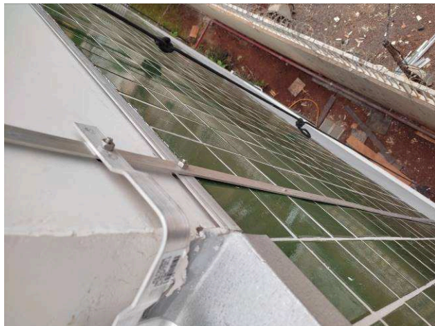
Figura 44E: Captação SPDA – fitas alumínio 7/8"x1/8"
