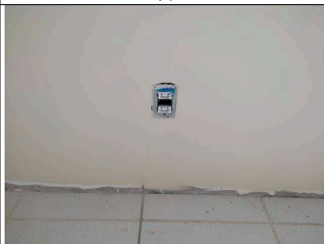
Figura 18E: Interruptores e tomadas – 4ª VT
