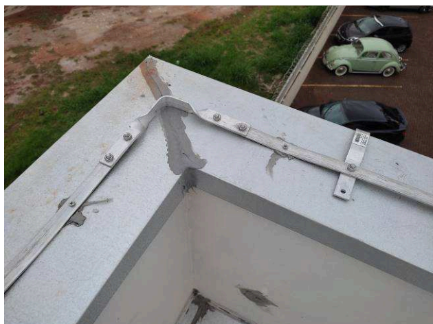
Figura 46E: Captação SPDA – fitas alumínio 7/8"x1/8"
