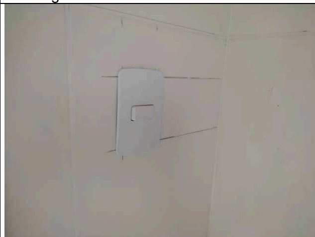
Figura 16E: Interruptores e tomadas – 4ª VT
