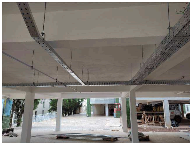
Figura 26E: Iluminação garagem
