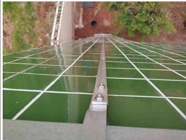
Figura 45E: Captação SPDA – fitas alumínio 7/8"x1/8"
