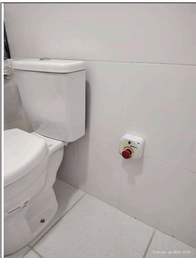
Figura 49: Alarmes – banheiros públicos.
