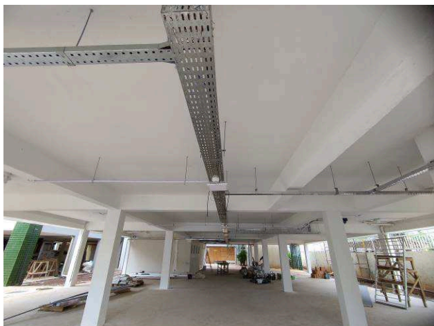
Figura 25E: Iluminação garagem
