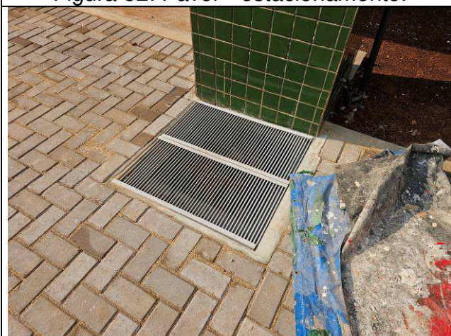
Figura 54: Grelhas - águas pluviais.
