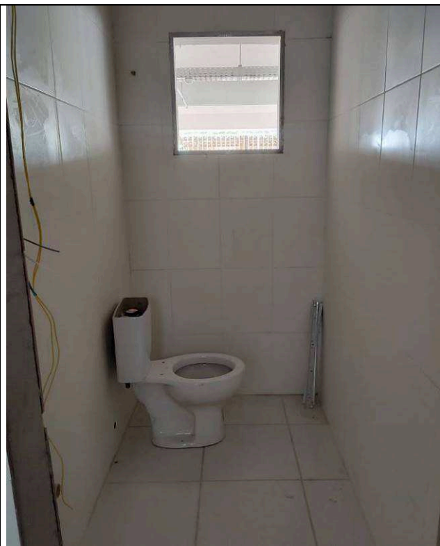
Figura 03: Azulejos – banheiro subsolo.
