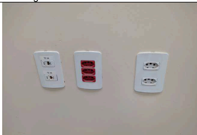
Figura 42E: Pontos RJ45 cat6 - Cejusc
