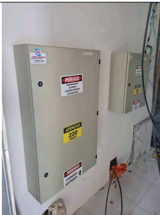
Figura 30E: Quadros elétricos – QDC4 QDE4
