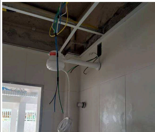
Figura 05: Forro – banheiro subsolo.
