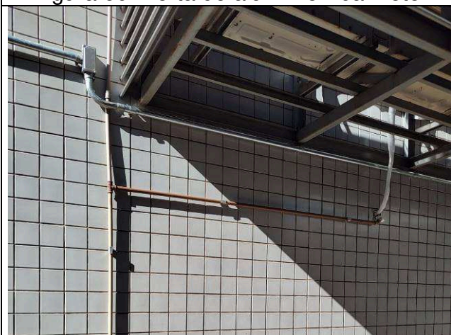
Figura 62: Rede frigorígena – Split da Sala de Terceirizados.
