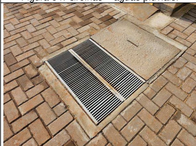
Figura 56: Grelhas - águas pluviais.
