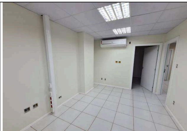
Figura 61: Equipamentos de ar condicionado - CEJUSC.
