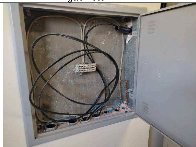
Figura 33E: Ramal rede lógica entre Setorial e Prédio Principal
