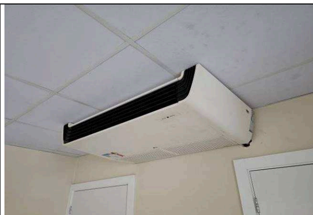
Figura 79: Equipamentos de ar condicionado - CEJUSC.
