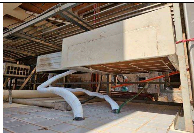
Figura 80: Equipamentos de ar condicionado - CEJUSC.
