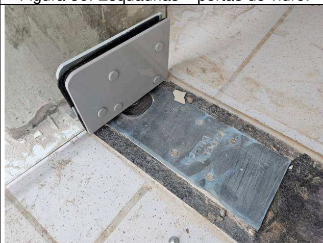
Figura 38: Esquadrias – molas de piso das portas de vidro.
