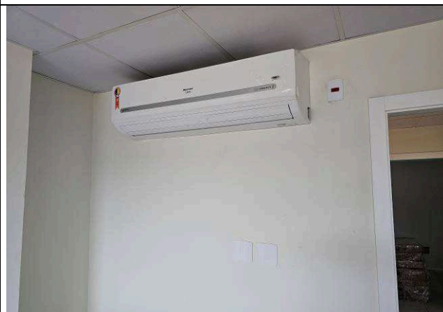
Figura 64: Equipamentos de ar condicionado - CEJUSC.
