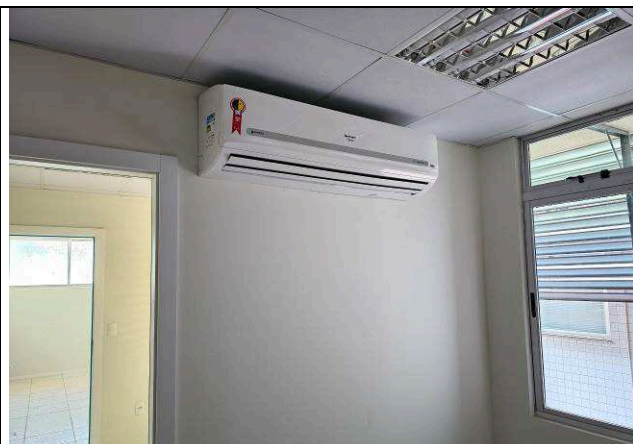
Figura 62: Equipamentos de ar condicionado - CEJUSC.
