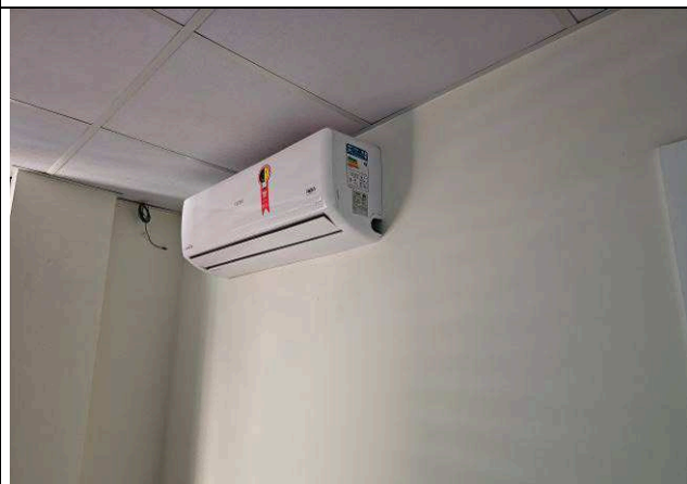
Figura 63: Equipamentos de ar condicionado - CEJUSC.
