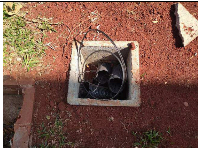
Figura 35E: Ramal rede lógica entre Setorial e Prédio Principal
