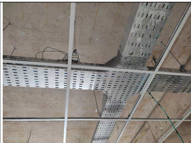
Figura 17E: Cabeamento alarme – 4ª VT
