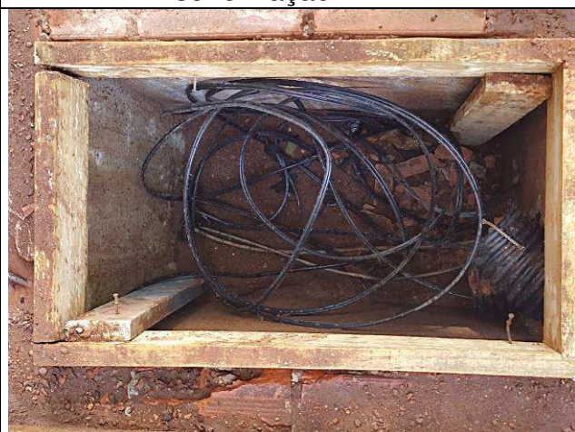
Figura 34E: Ramal rede lógica entre Setorial e Prédio Principal
