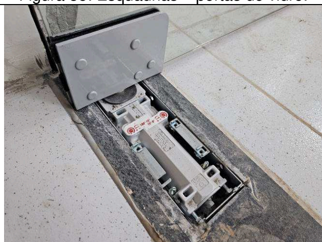
Figura 37: Esquadrias – molas de piso das portas de vidro.
