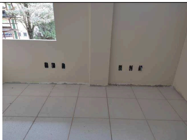
Figura 07E: Infraestrutura e cabeamento elétrico - Cejusc.
