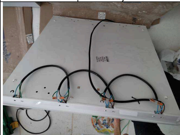
Figura 18E: Iluminação interna – Cejusc e hall.
