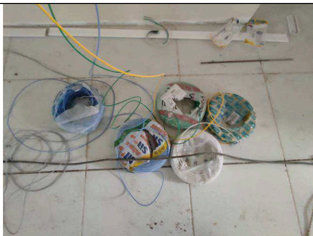
Figura 10E: Cabeamento elétrico - Cejusc.
