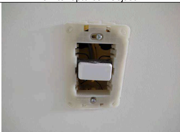
Figura 14E: Cabeamento elétrico, tomadas e interruptores - Cejusc.
