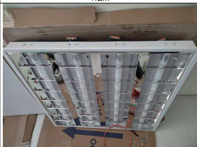
Figura 19E: Iluminação interna – Cejusc e hall.
