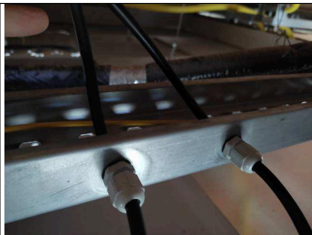
Figura 21E: Iluminação interna – Cejusc e hall.
