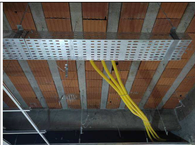
Figura 01E: Infraestrutura perfilados, eletrocalhas, eletrodutos e caixas - Cejusc.
