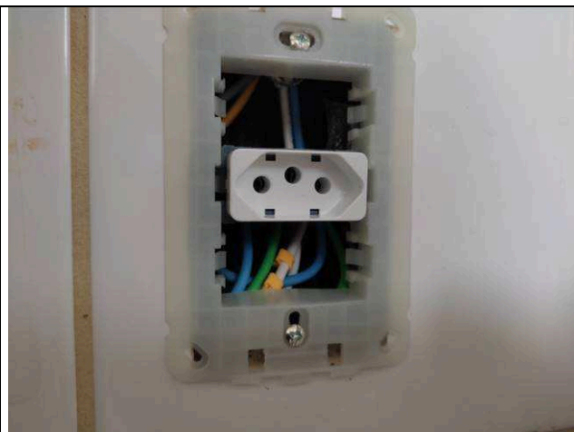
Figura 15E: Cabeamento elétrico, tomadas e interruptores - Cejusc.
