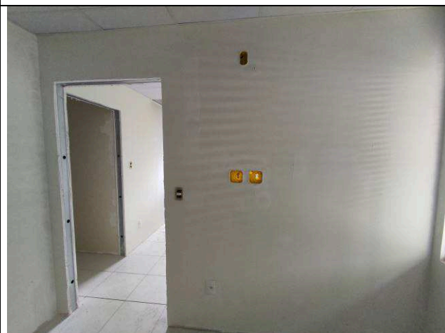
Figura 08E: Infraestrutura caixas rede lógica - Cejusc.
