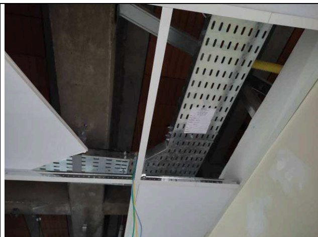
Figura 02E: Infraestrutura perfilados, eletrocalhas, eletrodutos e caixas - Cejusc.
