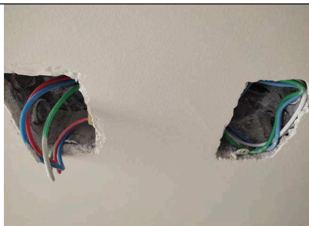
Figura 13E: Cabeamento elétrico, tomadas e interruptores - Cejusc.
