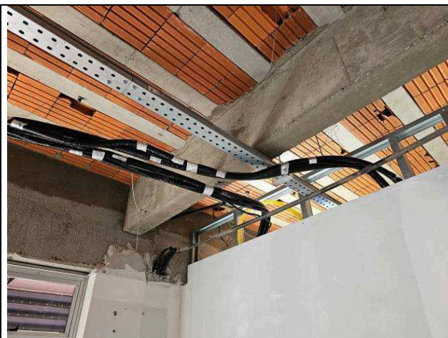
Figura 100: Climatação – redes frigorígenas.
