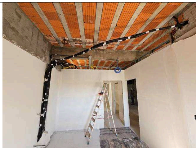
Figura 99: Climatação – redes frigorígenas.
