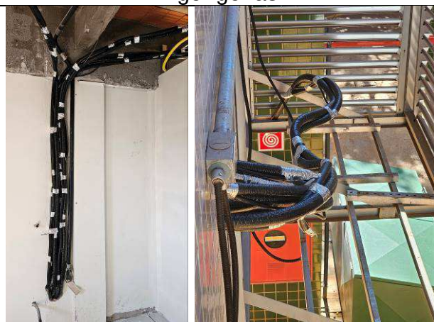
Figura 101: Climatação – redes frigorígenas.
