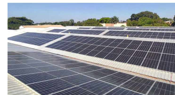
Usina Solar - Fórum Trabalhista de Londrina - PR
