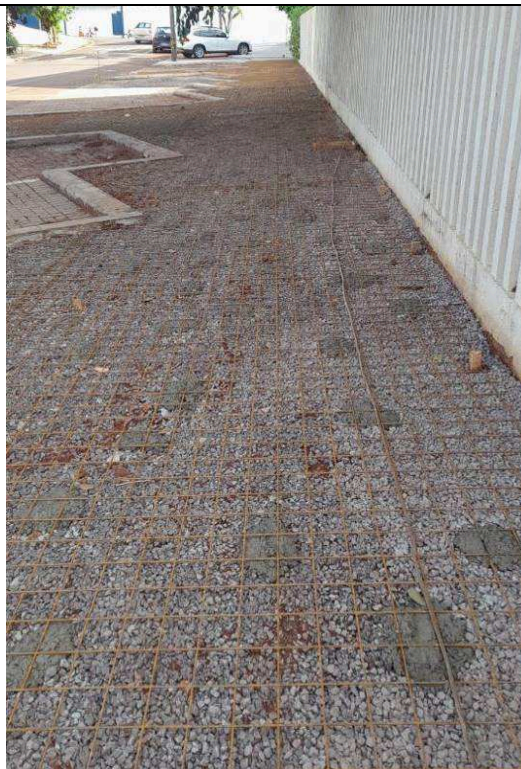
Figura 16: Tela Metálica – Calçada Parecis.
