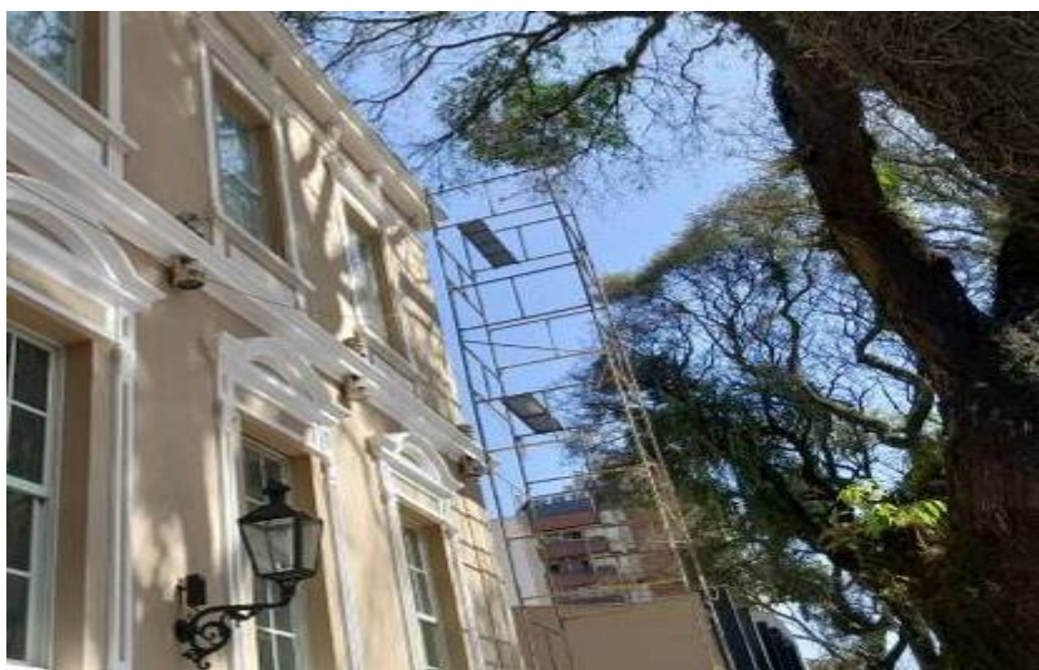
Figura E01– Andaime tubular tipo torre e furos em concreto
