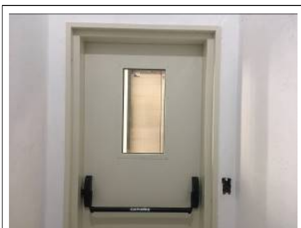
Figura 09 – Porta Corta-Fogo instalada
