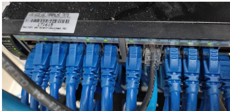
Figuras 02 – Proteções e inversores instalados – Colombo
