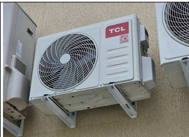
Figura 90: Condensadora nova – 12.000 BTU's.
