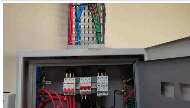
Figura 13E: cabearamento elétrico rede estabilizada
