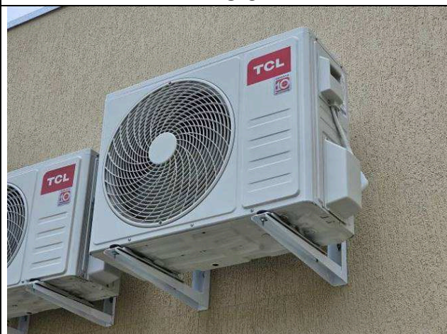
Figura 92: Condensadora nova – 18.000 BTU's.
