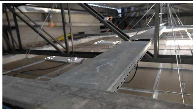
Figura 07E: eletrocalhas tampadas e infraestrutura interna
