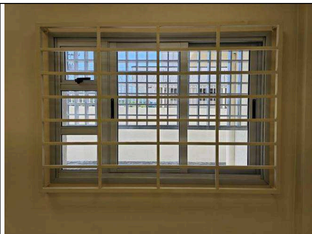
Figura 40: Gradis de proteção das janelas.
