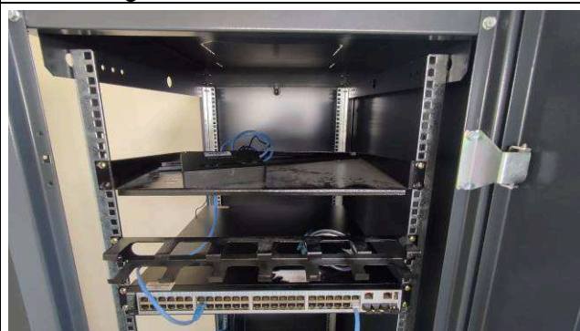
Figura 57E: rack sala técnica
