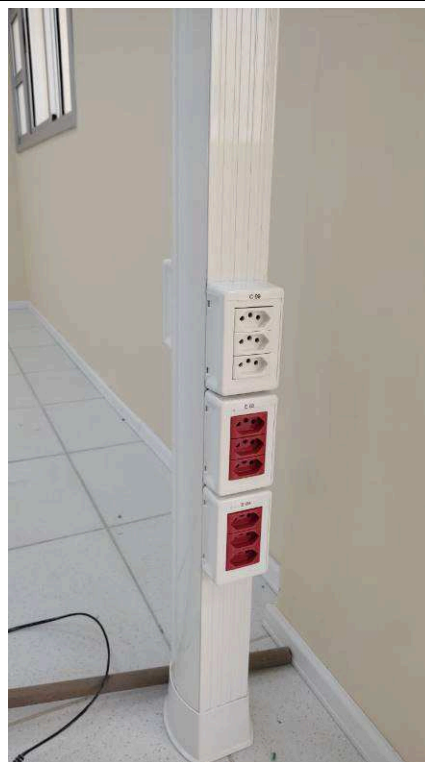
Figura 52E: colunas técnicas Dutotec
