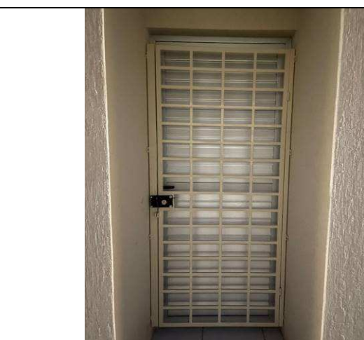
Figura 43: Grade de abrir de proteção da porta – porta da área de terceirizados.
