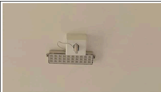
Figura 30E: blocos de emergência e balizadores
