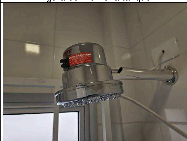
Figura 82: Chuveiro elétrico – terceirizados.
