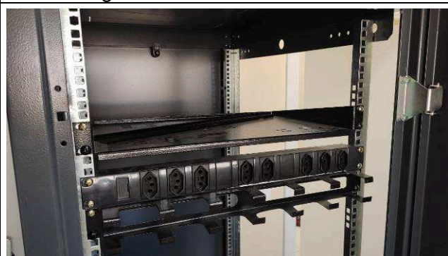
Figura 59E: rack sala técnica
