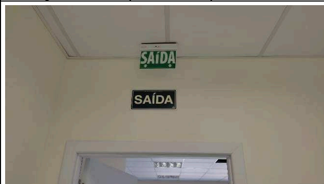
Figura 28E: blocos de emergência e balizadores
