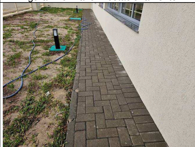
Figura 118: Paver – calçada interna frontal.
