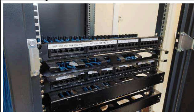
Figura 58E: rack sala técnica
