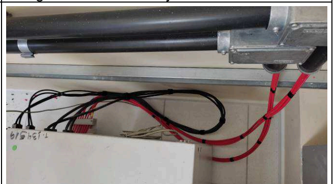
Figura 04E: infraestrutura e instalação nobreak
