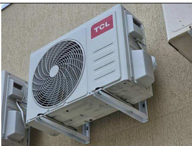
Figura 88: Condensadora nova - 9.000 BTU's.
