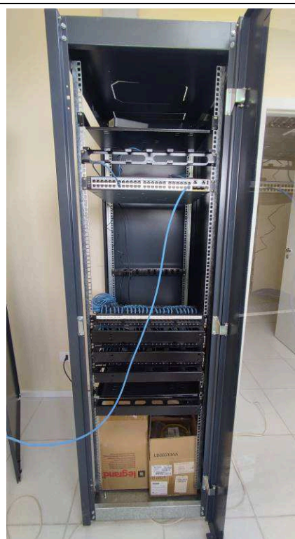
Figura 56E: rack sala técnica
