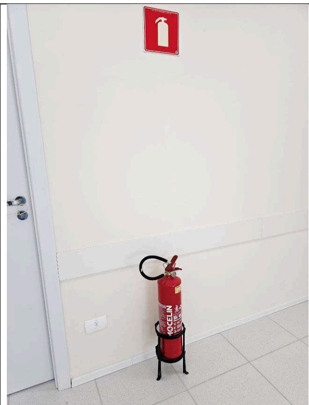
Figura 104: Extintor – Pó químico ABC.
