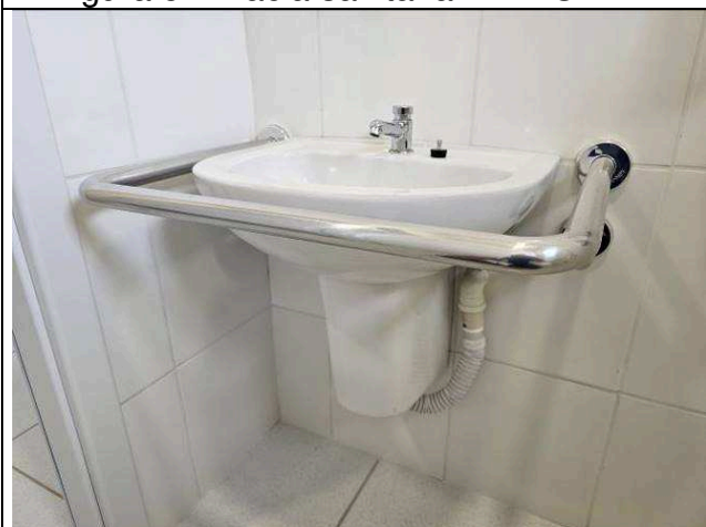
Figura 59: Lavatório – BWC PNE.
