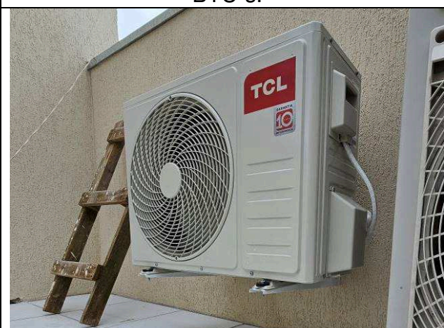
Figura 94: Condensadora nova – 24.000 BTU's.
