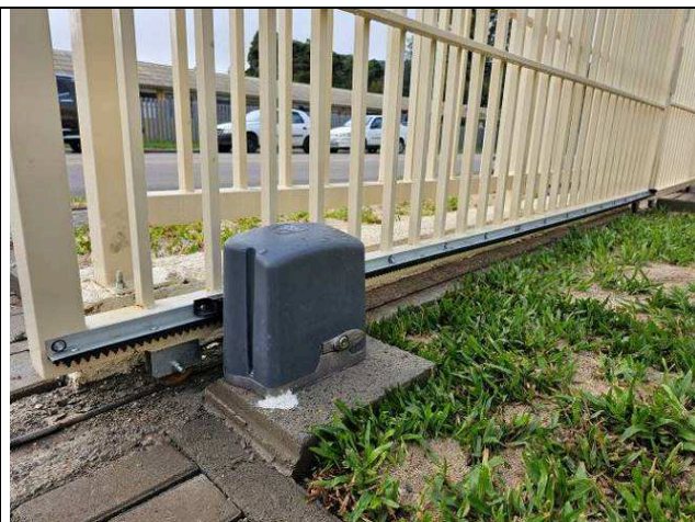
Figura 126: Portão de veículos – detalhe motor automação.
