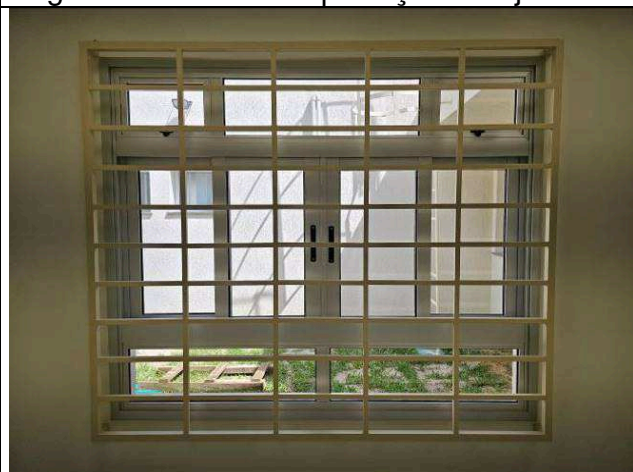
Figura 36: Gradis de proteção das janelas.
