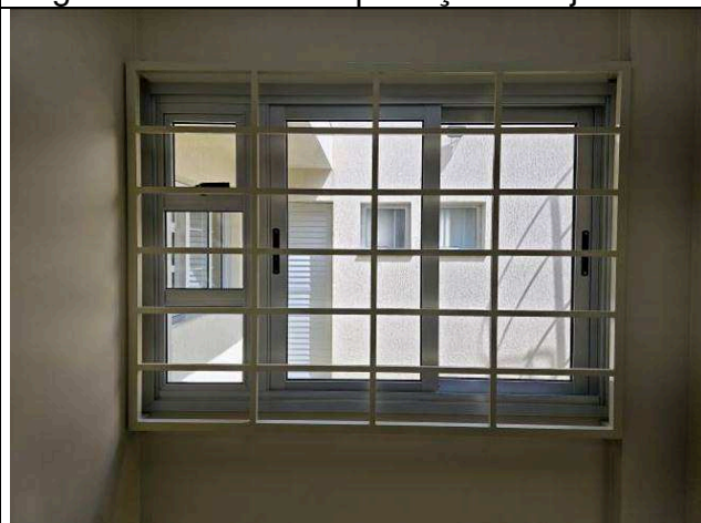
Figura 35: Gradis de proteção das janelas.
