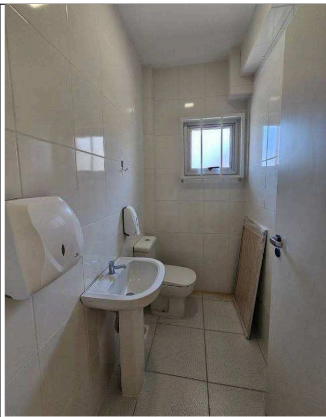
Figura 46: Azulejos – banheiro gabinete de juiz 2ª Vara.
