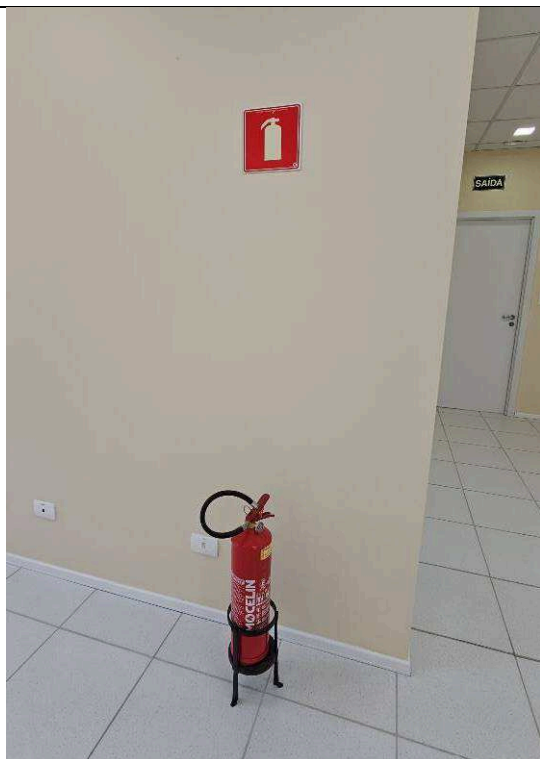
Figura 105: Extintor – Pó químico ABC.
