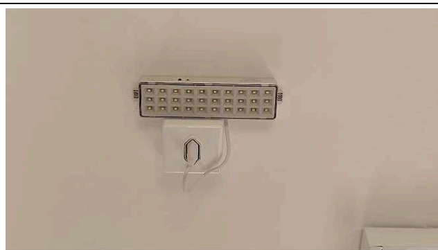
Figura 29E: blocos de emergência e balizadores
