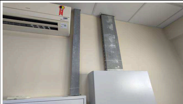
Figura 10E: eletrocalhas tampadas e infraestrutura interna
