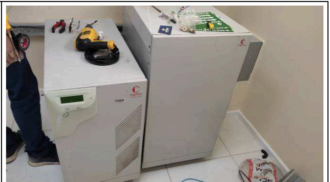
Figura 02E: remanejamento do nobreak
