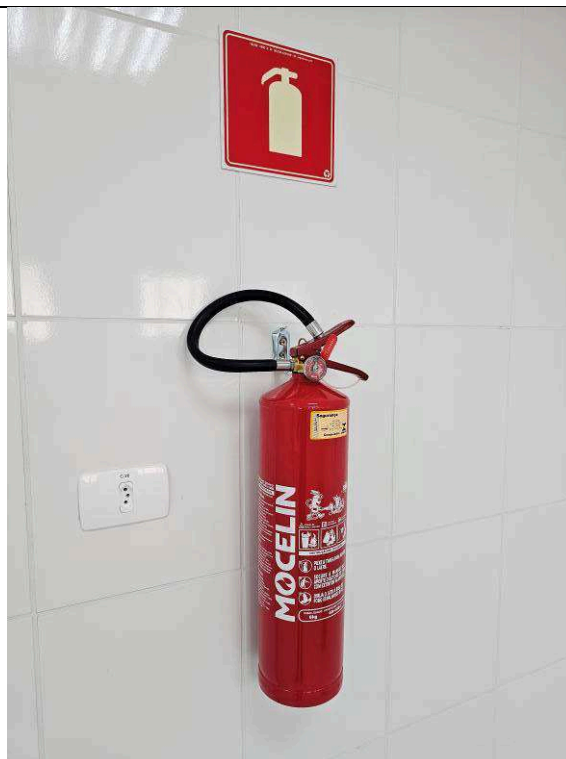
Figura 106: Extintor – Pó químico ABC.
