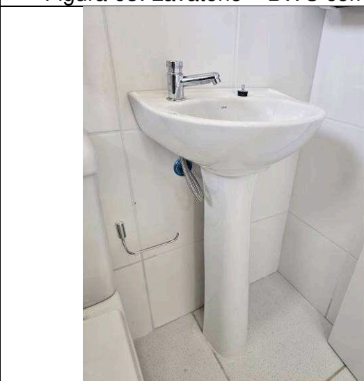
Figura 65: Lavatório – BWC terceirizados.
