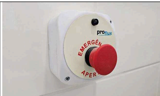
Figura 83: Acionador interno do alarme antipânico - PNE.
