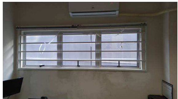
Figura I.5.4C: Gradil metálico instalado na janela da sala de segurança
