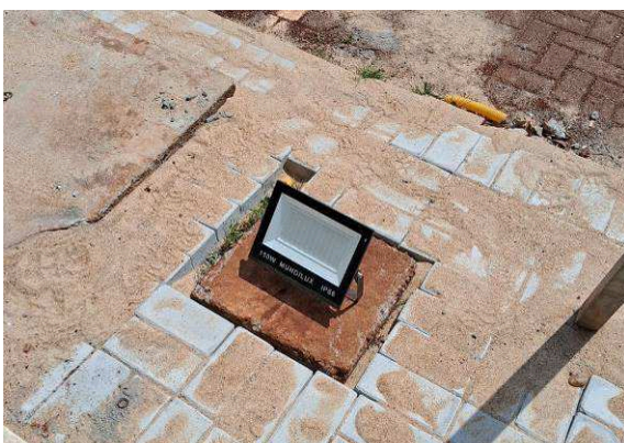
Figura I.5.7E: Iluminação externa – refletor entrada FT
