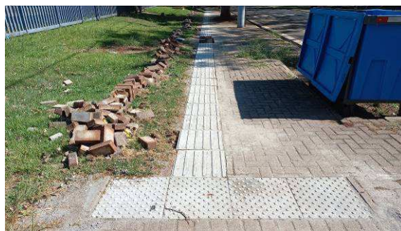
Figura I.7.4C: Piso tátil de alerta e direcional, instalados no passeio público
