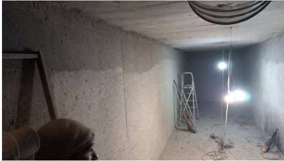
Figura I.8.3C: Remoção da manta e camada de proteção mecânica de um dos dois reservatórios inferiores
