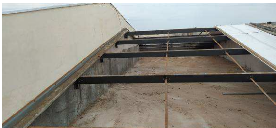
Figura I.2.3C: Remoção das telhas de fibrocimento e início da instalação das telhas termoacústicas na região do CejusC
