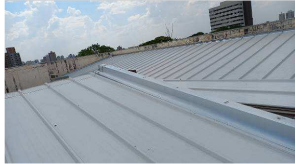
Figura I.2.8C: Rufos e contrarrufos instalados na região do bloco central
