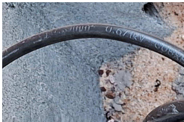
Figura I.5.6E: Iluminação externa – cabos 1kV
