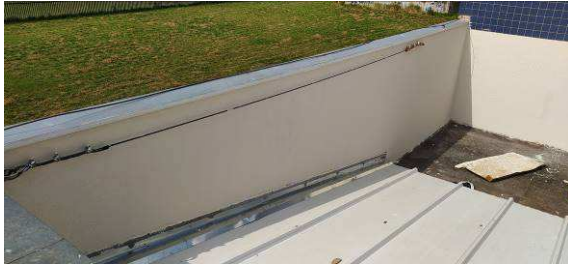
Figura I.4.3C: Aplicação de textura acrílica em platibanda, na região da cobertura da 4ª vara
