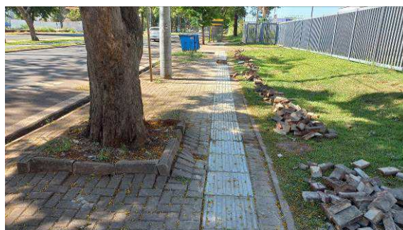
Figura I.7.6C: Piso tátil direcional, instalado no passeio público
