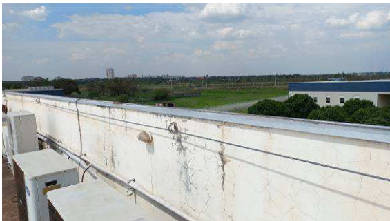
Figura I.2.13C: Chapim instalado na região do Arquivo
