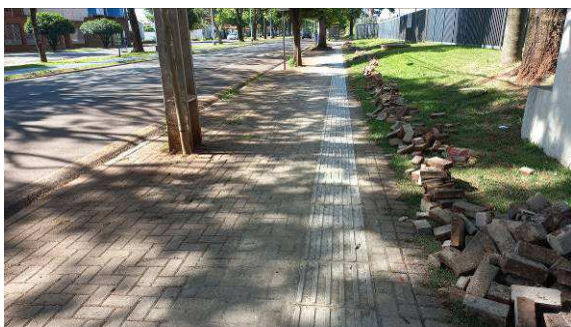
Figura I.7.3C: Piso tátil direcional, instalado no passeio público
