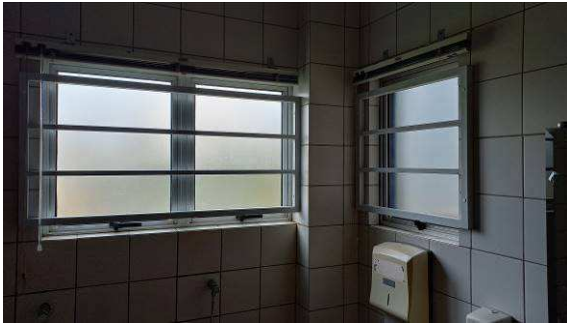
Figura I.5.1C: Gradis instalados em janelas do sanitário público feminino, no pavimento térreo
