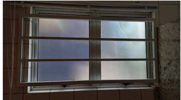
Figura I.5.2C: Gradil instalado em janela do sanitário público masculino, no pavimento térreo
