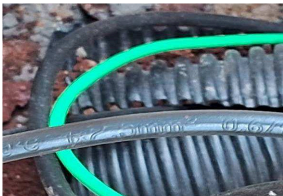
Figura I.5.5E: Iluminação externa – cabos 1kV
