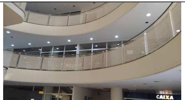
Figura I.6.2E: Substituição lâmpadas fluorescentes compactas por LED bulbo E27
