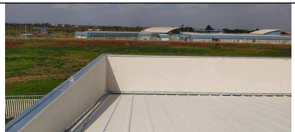
Figura I.4.6C: Textura aplicada nas faces internas das platibandas do prédio da Setorial (faces leste e sul)
