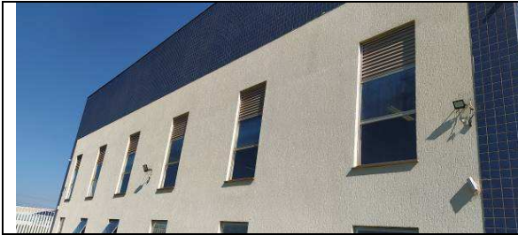
Figura I.3.3C: Instalação de esquadrias de vidro em substituição a venezianas de alumínio, na Setorial
