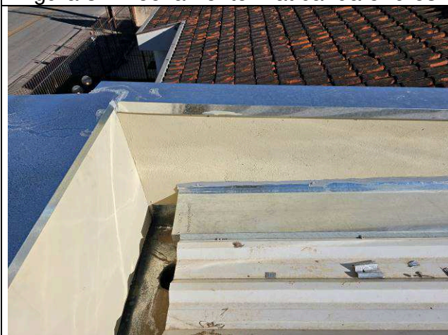
Figura 33: Fechamento Platibanda e rufos.
