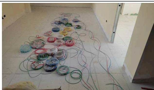
Figura 13E: Cabeamento elétrico
