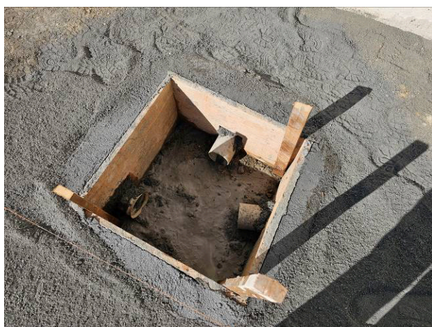
Figura 47: Drenagem – águas pluviais.
