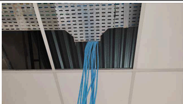
Figura 21E: Cabeamento UTP cat-6
