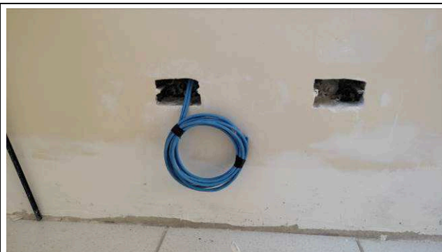
Figura 26E: Caixas 2x4", 4x4", eletrodutos corrugados 1", cabeamento UTP cat-6
