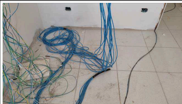
Figura 22E: Cabeamento UTP cat-6
