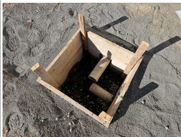
Figura 48: Drenagem – águas pluviais.
