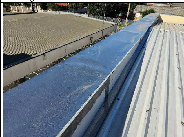
Figura 31: Fechamento Platibanda e rufos.
