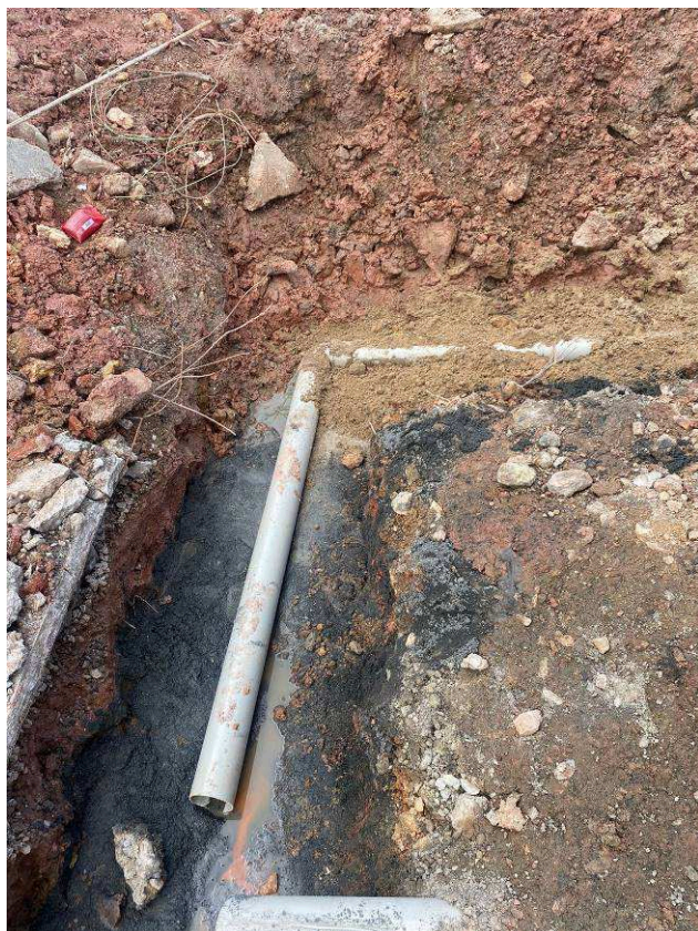
Figura 45: Drenagem – águas pluviais.
