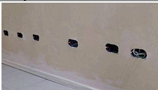
Figura 23E: Caixas 2x4", 4x4", eletrodutos corrugados 1", cabeamento UTP cat-6
