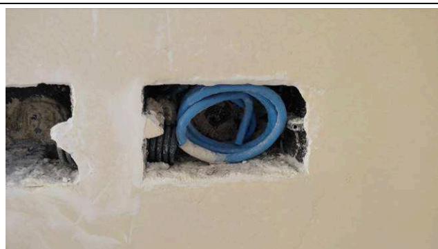
Figura 25E: Caixas 2x4", 4x4", eletrodutos corrugados 1", cabeamento UTP cat-6
