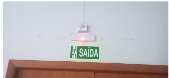
Figura I.5.6E: Substituição blocos de emergência 30 leds
