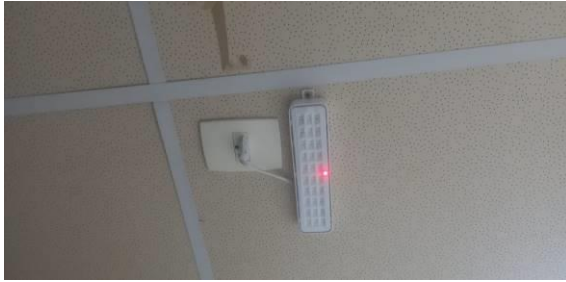
Figura I.5.3E: Substituição blocos de emergência 30 leds
