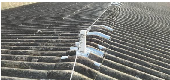
Figura I.8.13C: Linha de vida em cabo com alma de aço, atravessando toda a extensão da cobertura do barracão, na região da cumeeira
