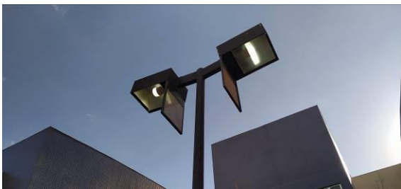
Figura I.5.11E: Substituição lâmpadas LED 30W – luminárias tipo pétala
