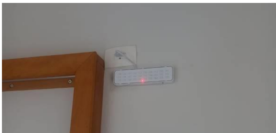
Figura I.5.7E: Substituição blocos de emergência 30 leds
