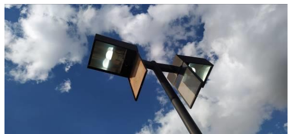
Figura I.5.10E: Substituição lâmpadas LED 30W – luminárias tipo pétala
