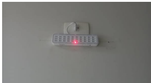
Figura I.5.2E: Substituição blocos de emergência 30 leds
