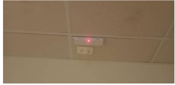
Figura I.5.4E: Substituição blocos de emergência 30 leds
