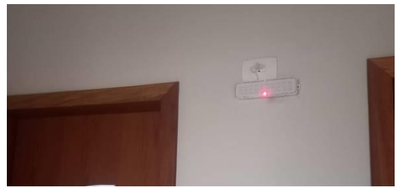
Figura I.5.8E: Substituição blocos de emergência 30 leds
