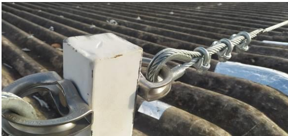
Figura I.8.11C: Detalhe de placas olhais em um dos pontalotes estruturais de sustentação das linhas de vida na cobertura da setorial
