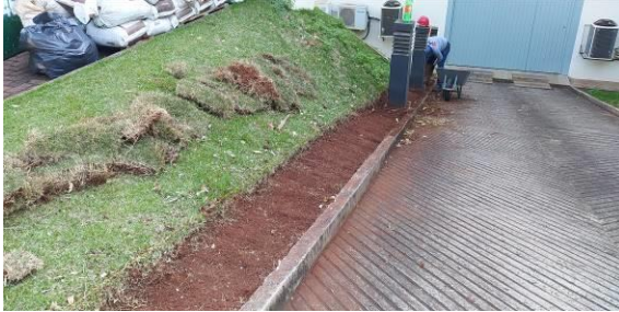
Figura I.8.1C: Limpeza da vegetação na faixa de plantio da grama preta – rampa do subsolo da direita
