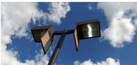
Figura I.5.9E: Substituição lâmpadas LED 30W – luminárias tipo pétala
