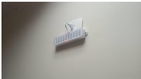
Figura I.5.1E: Substituição blocos de emergência 30 leds
