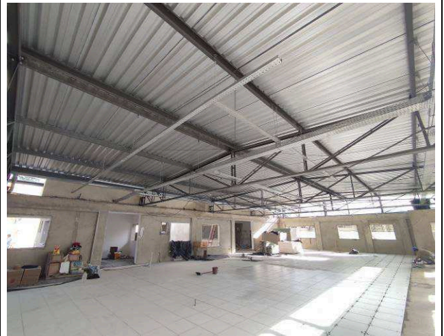
Figura 34: Eletrocalhas e perfilados - frente.
