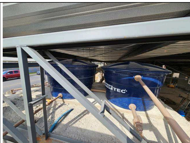
Figura 55: Reservatórios – BWC's públicos.
