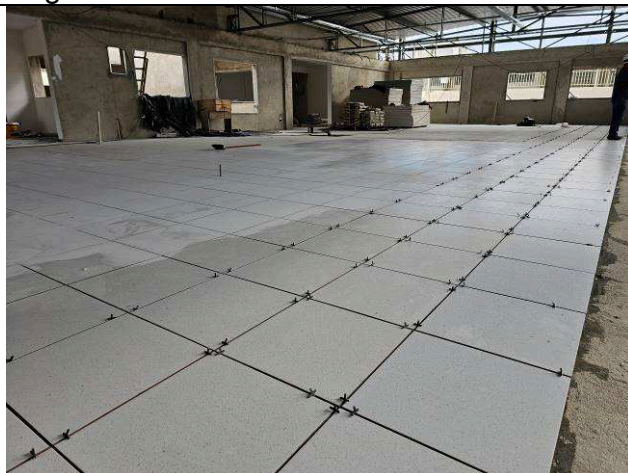
Figura 13: Piso Cerâmico – edifício frontal.
