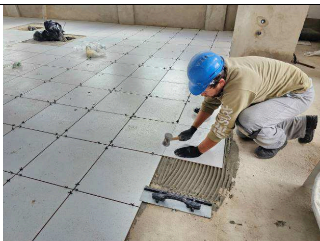
Figura 11: Piso Cerâmico – edifício frontal.
