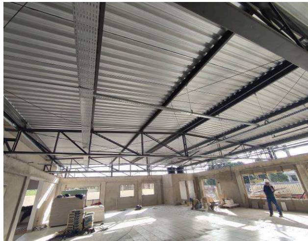
Figura 33: Eletrocalhas e perfilados - frente.
