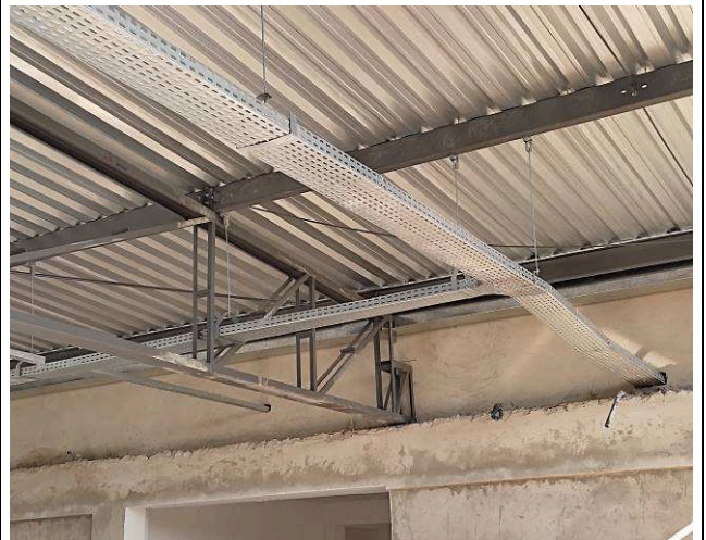
Figura 36: Eletrocalhas e perfilados - frente.
