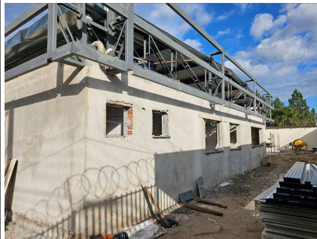
Figura 52: Revestimento argamassado – paredes externas área frontal.
