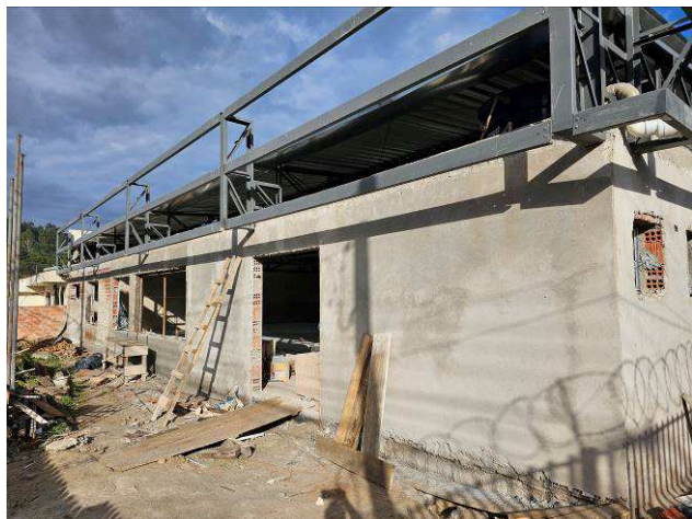
Figura 51: Revestimento argamassado – paredes externas área frontal.
