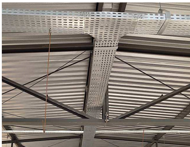
Figura 37: Eletrocalhas e perfilados - frente
