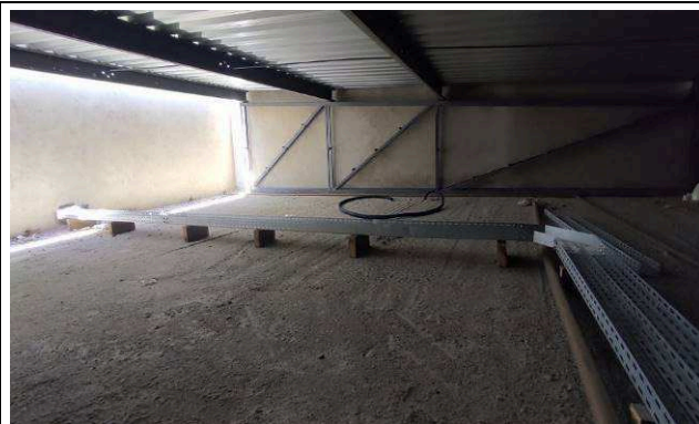
Figura 02E: Eletrocalhas 200X50 área fundos
