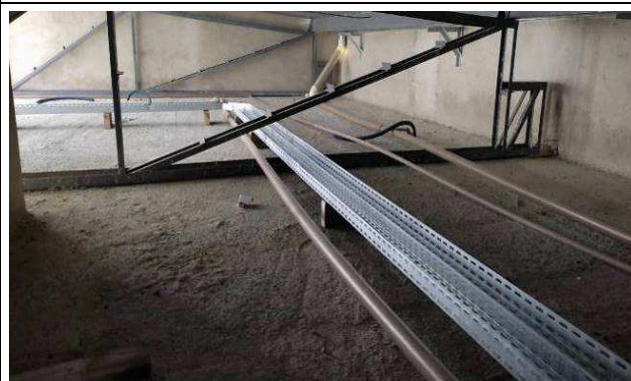
Figura 06E: Eletrocalhas 200X50 área fundos
