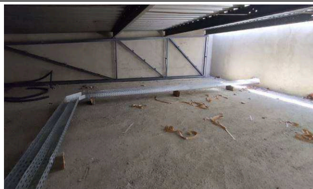
Figura 01E: Eletrocalhas 200X50 área fundos
