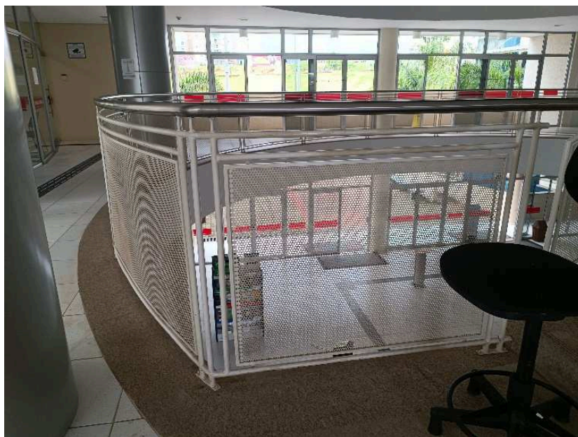
Figura 29 – guarda corpo – proteção dos vãos das escadas do átrio central.
