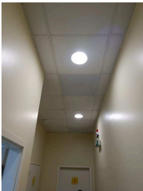
Figura 17 - Forro de gesso acartonado em placas – circulação banheiros/ copa auditório.
