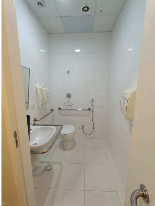
Figura 13 - Forro de gesso acartonado em placas – banheiro PNE auditório.
