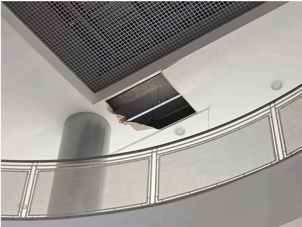
Figura 11 - Forro de gesso acartonado monolítico – átrio do edifício principal.
