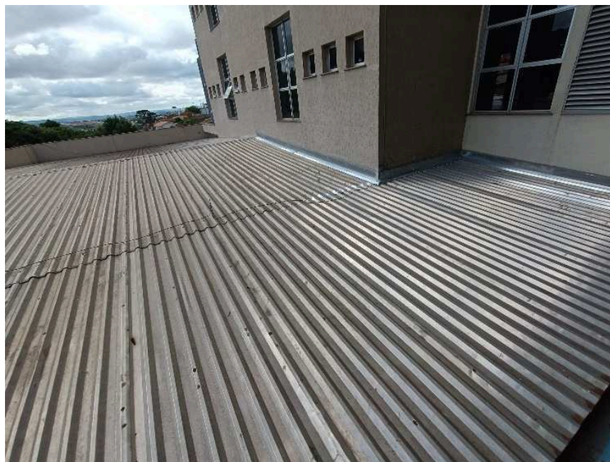
Figura 1 – Cobertura existente no anexo (auditório). Telhas e rufos a serem substituídos.
