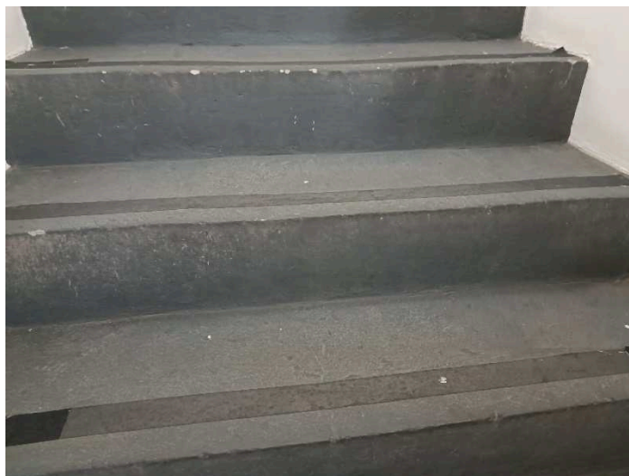
Figura 31 – escada interna – piso descascando e fitas antiderrapantes desgastadas
