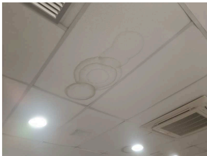
Figura 18 - Forro acústico – plateia auditório.
