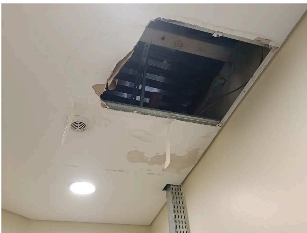
Figura 9 - Forro de gesso acartonado monolítico da sala técnica – auditório
