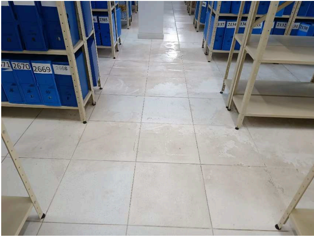
Figura 22 – piso manchado (arquivo maior – subsolo).
