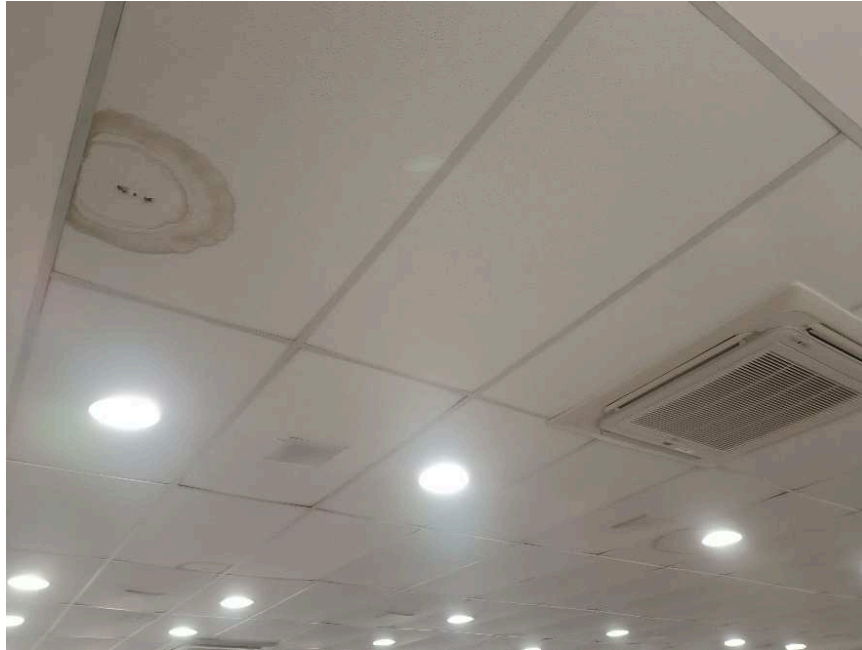
Figura 19 - Forro acústico – plateia auditório.
