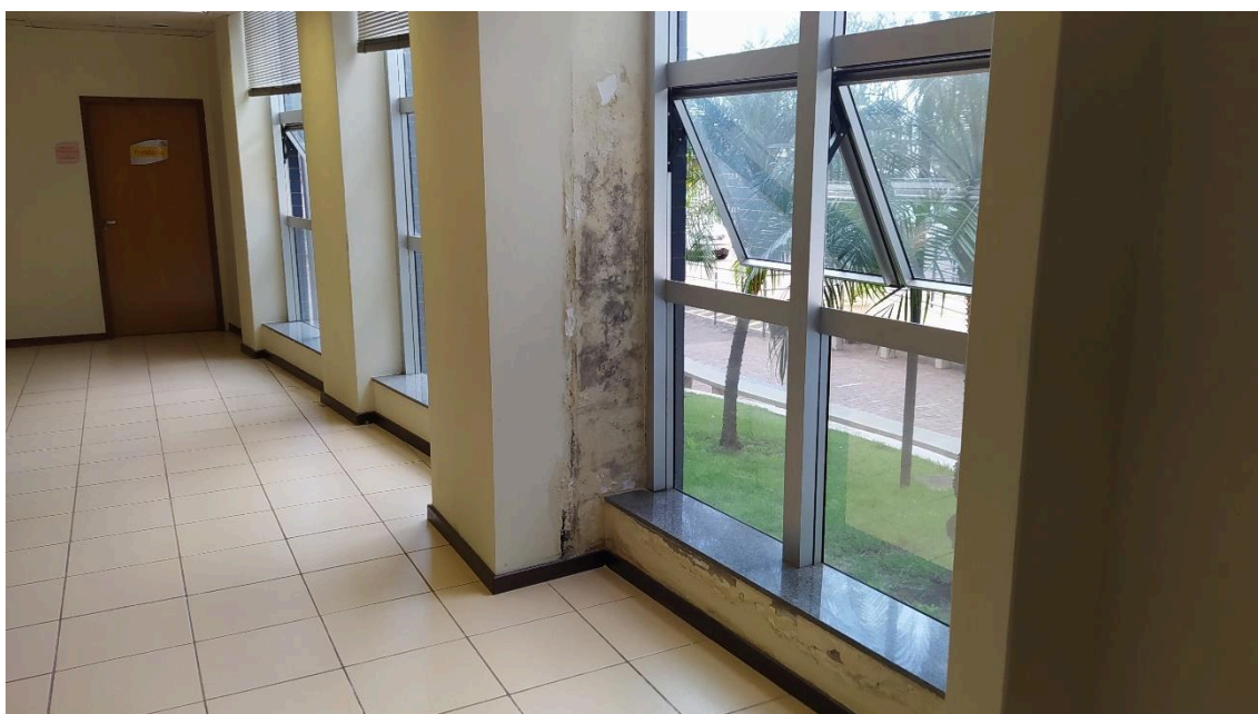
Local de prumada pluvial com vazamento – Pavimento térreo do Fórum
