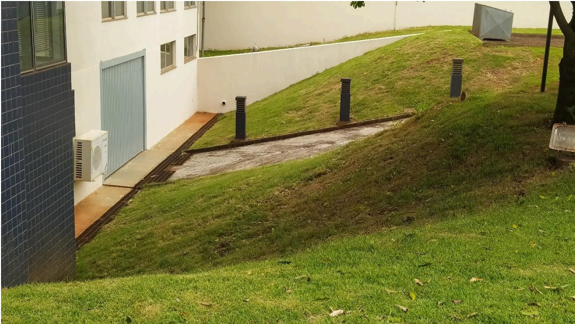
Elaboração de faixas de retenção, em forma de grama preta, nas partes baixas dos taludes, nos acessos aos estacionamentos do subsolo
