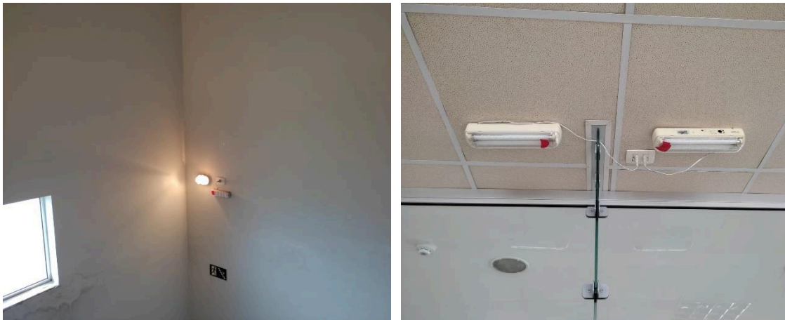
Figuras 7E a 8E – Blocos de emergência a serem substituídos
