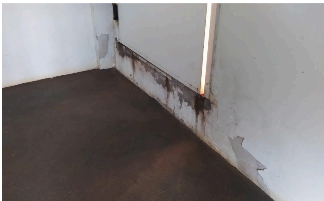
Portas corta-fogo de acesso ao terraço – Substituir soleira e instalar veda-porta
