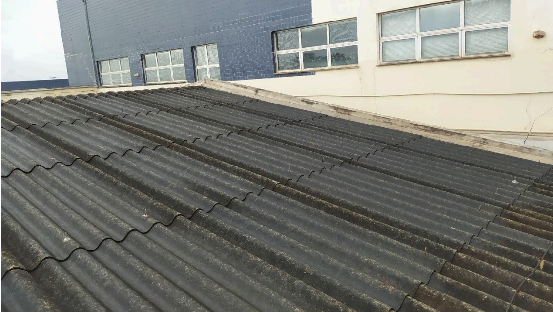
Telhas, calhas, rufos, chapins e contrarrufos a serem removidos, na cobertura do Fórum
