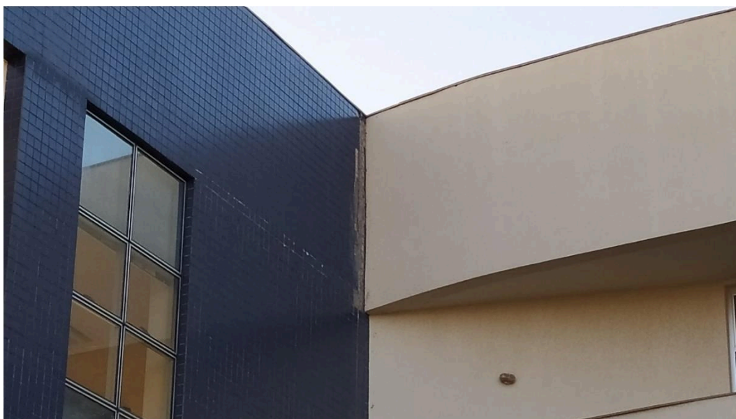
Pastilhas soltas em trecho da fachada principal
