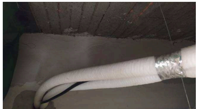
Figura 26C: Detalhe da linha frigorífica e dos cabos elétricos de acionamento do condicionador instalado no balcão de atendimento
