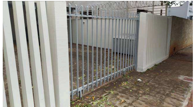
Figura 38C: Pintura do portão do estacionamento direito
