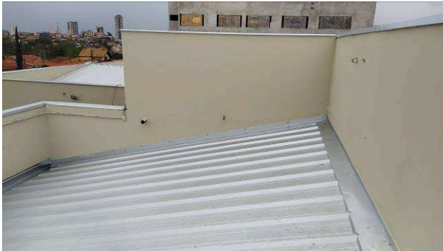
Figura 43C: Pintura das faces internas das platibandas, após aplicação de massa acrílica e lixamento – Sala de audiência 1
