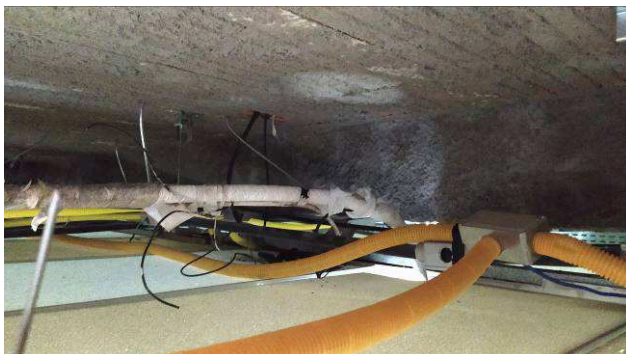
Figura 25C: Detalhe da linha frigorífica e dos cabos elétricos de acionamento do condicionador instalado na sala de audiência 1
