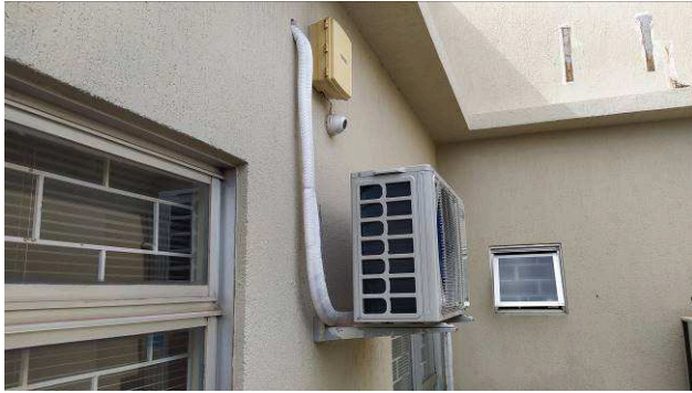
Figura 21C: Reposicionamento de condensadora do gabinete do juiz auxiliar, com linha frigorífica nova
