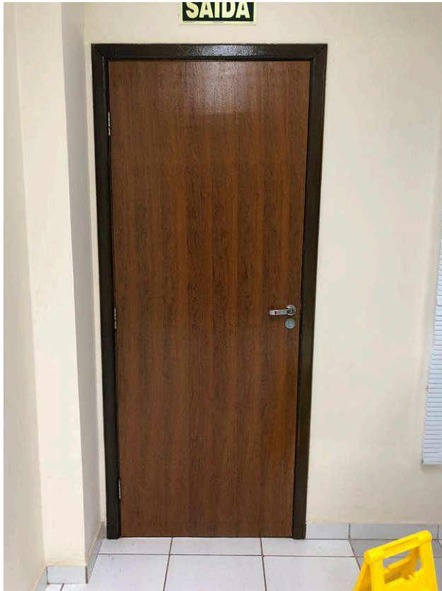
Figura 57C: Instalação de folha de porta nova e aplicação de verniz na folha, batentes e alizares
