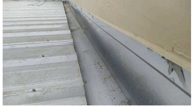
Figura 13C: Detalhe de calha instalada na região da sala de audiência 1 e conciliação
