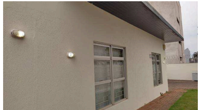
Figura 12E: Luminárias e lâmpada LED
