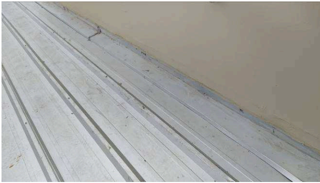
Figura 14C: Detalhe de rufo instalado na região do arquivo
