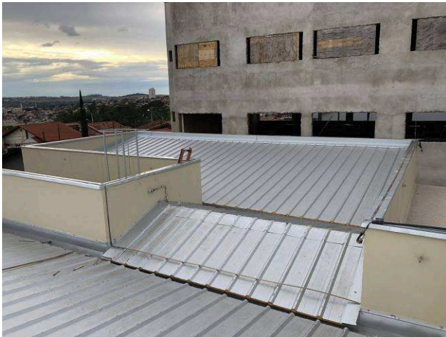
Figura 08C: Cobertura metálica termoacústica – Arquivo e copa
