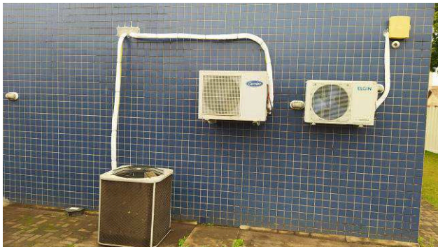
Figura 23C: Reposicionamento das condensadoras do PAB, do hall de espera e da sala dos oficiais
