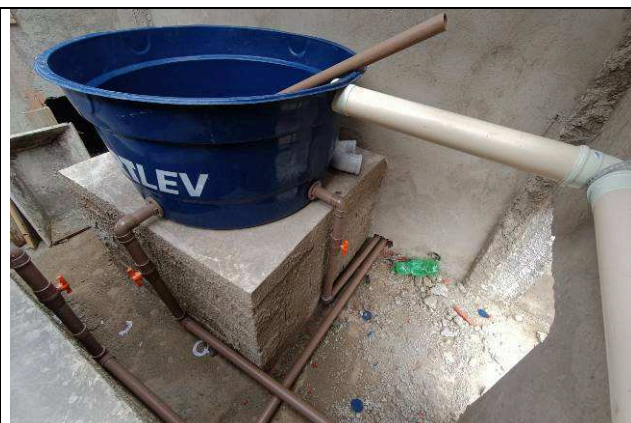
Figura 12: Reservatório de água pluvial, registros e tubulações de distribuição.
