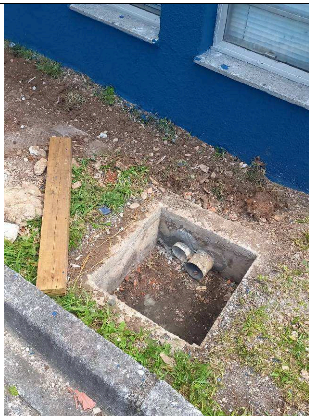
Figura 32: Caixas de passagem e prumadas.
