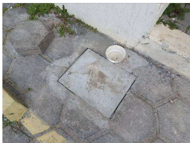
Figura 33: Caixas de passagem e prumadas.
