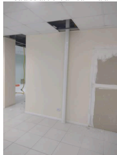
Figura 02E: Colunas Dutotec
