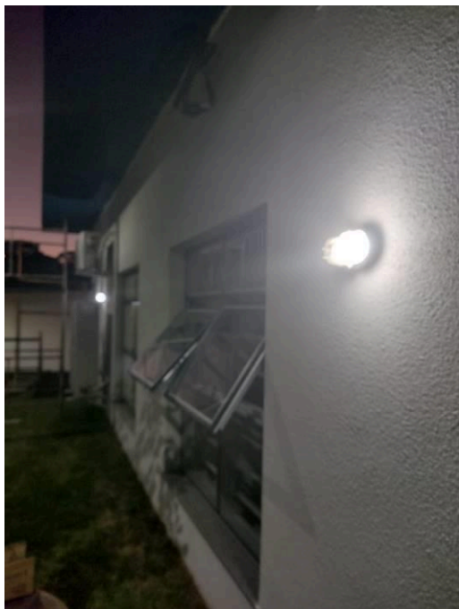
Figura 13E: Iluminação externa – lâmpadas bulbo
