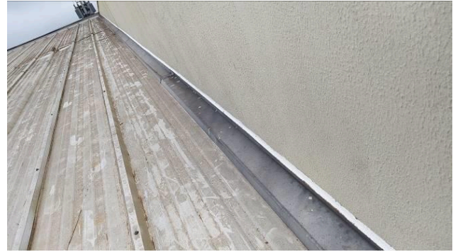
Figura 53C: Vedação de rufo, no bloco central
