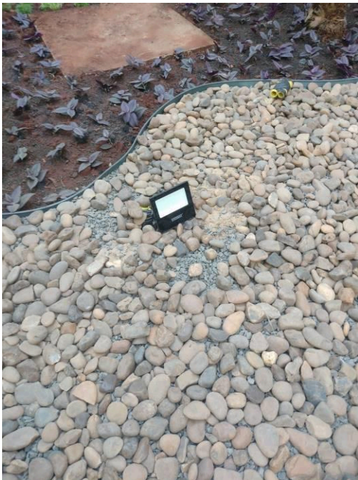
Figura 11E: Iluminação jardim interno
