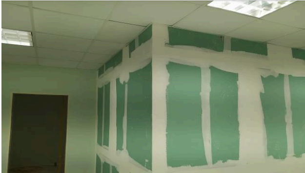
Figura 46C: Execução de parede de gesso acartonado (drywall), na divisão das salas do Cejusc
