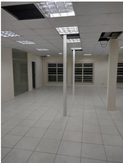
Figura 01E: Colunas Dutotec
