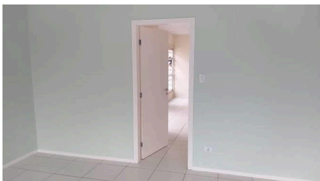
Figura 05C: Pintura de portas, batentes, vistas e rodapés – Sala de conciliação 1 da 2ª vara
