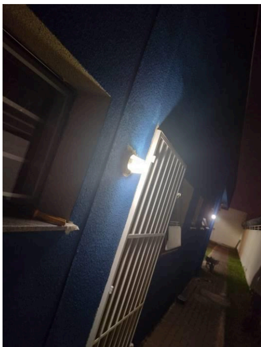
Figura 15E: Iluminação externa – lâmpadas bulbo
