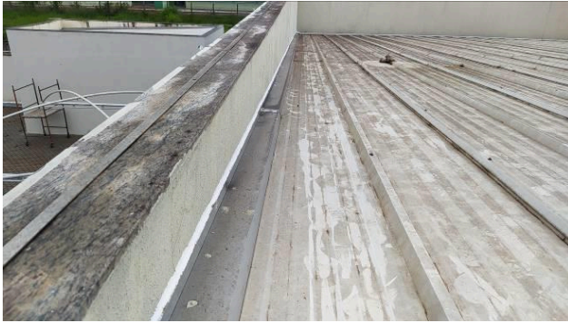
Figura 52C: Vedação de rufo, no bloco esquerdo
