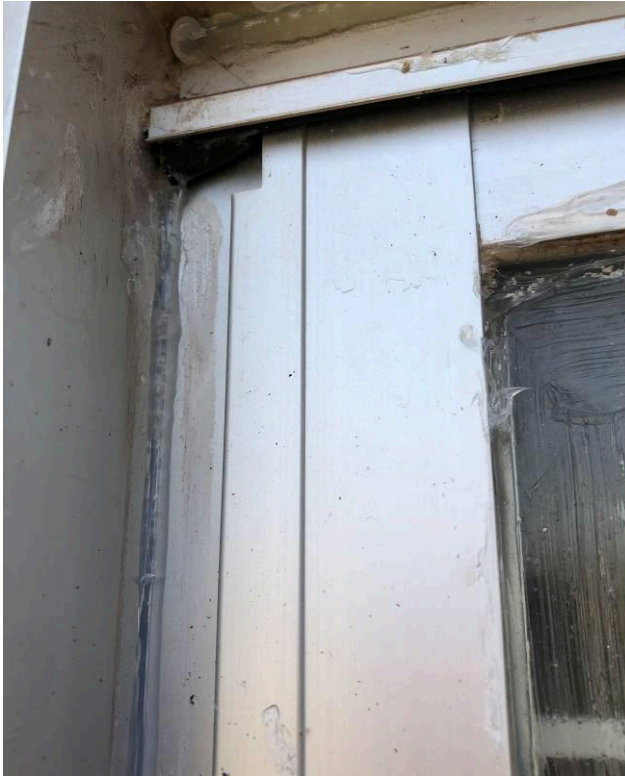
Figura 48C: Vedação das juntas da janela, na sala da OAB
