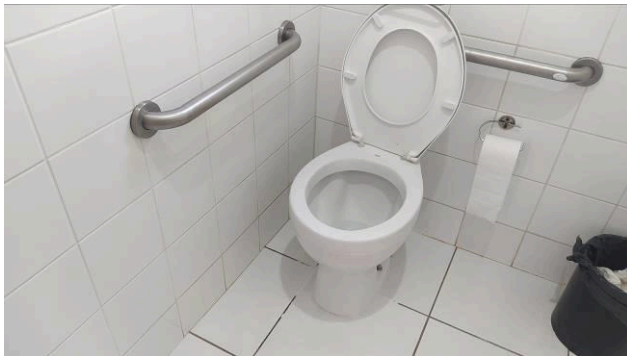
Figura 32C: Vaso sanitário PCD, instalado no BWC público masculino
