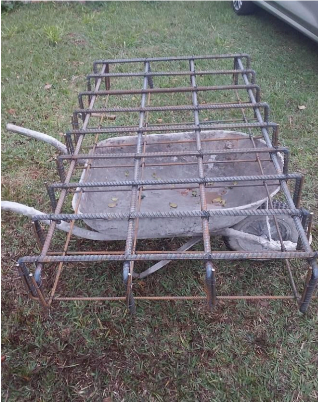
Figura 28C: Corte, dobra e montagem da armadura do bloco radier para instalação da cisterna de reuso
