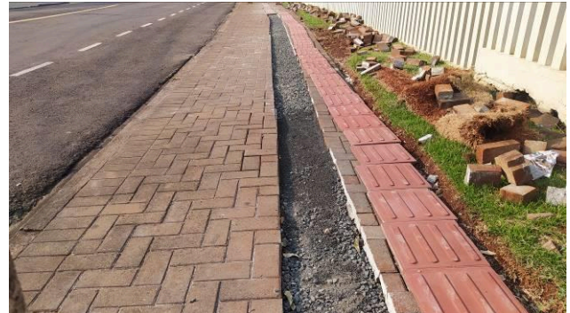
Figura 37C: Realização dos rasgos no paver, para instalação do piso tátil em placa cimentícia no passeio público
