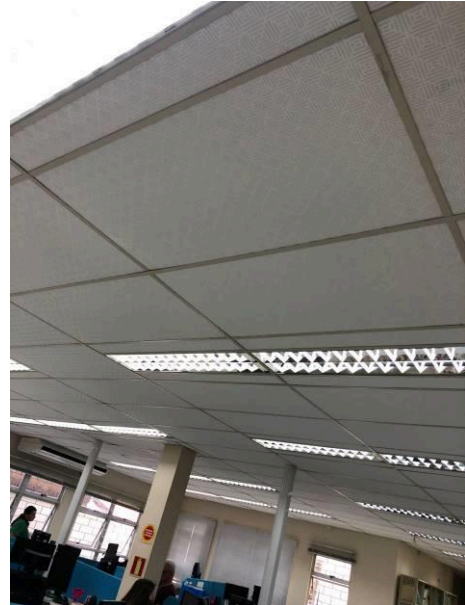
Figura 04E: Iluminação interna – lâmpadas LED
