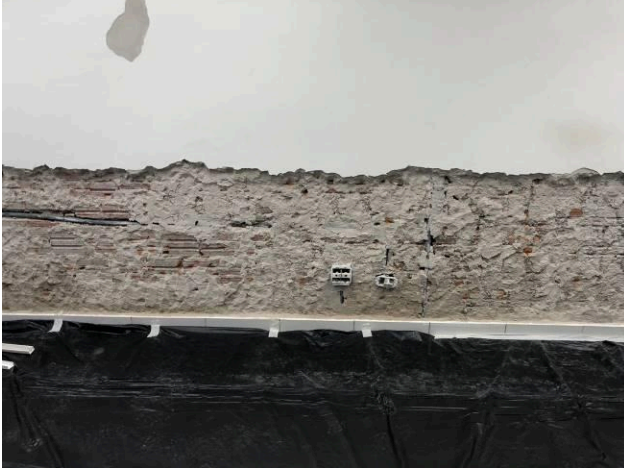
Figura 44C: Demolição do revestimento argamassado no barrado das paredes externas da sala da OAB
