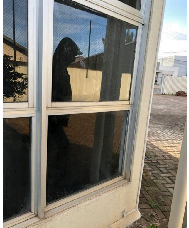
Figura 49C: Vedação das juntas da janela, na sala da OAB
