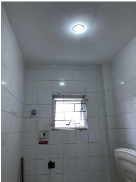
Figura 09E: Iluminação interna – lâmpadas LED
