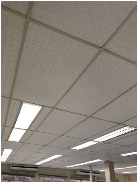
Figura 05E: Iluminação interna – lâmpadas LED
