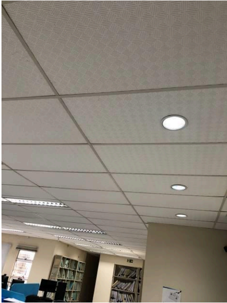
Figura 07E: Iluminação interna – lâmpadas LED
