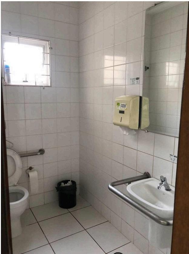
Figura 36C: Espelho instalado em sanitário público
