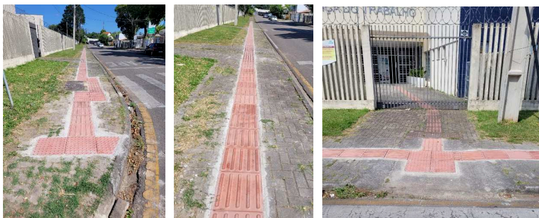
Figuras 20 – Piso tátil instalado na testada da Vara do Trabalho de Pinhais.
