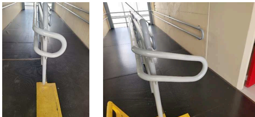
Figuras 8 – Adaptação de corrimão para abertura das portas corta fogo, no 3º e 5º piso.
