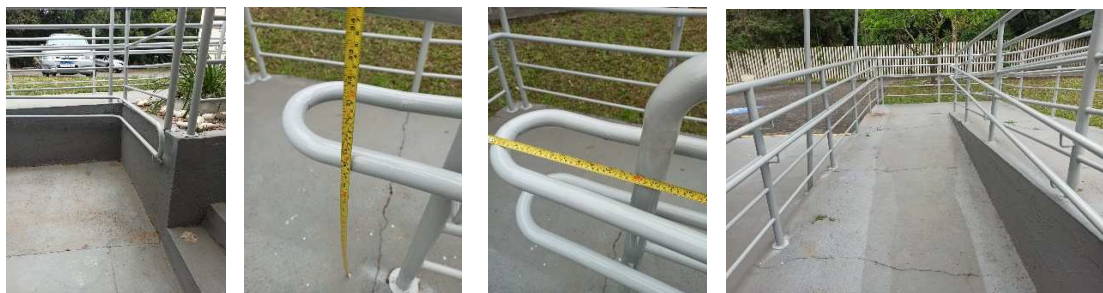
Figuras 7 – Complemento de corrimão duplo na rampa.
