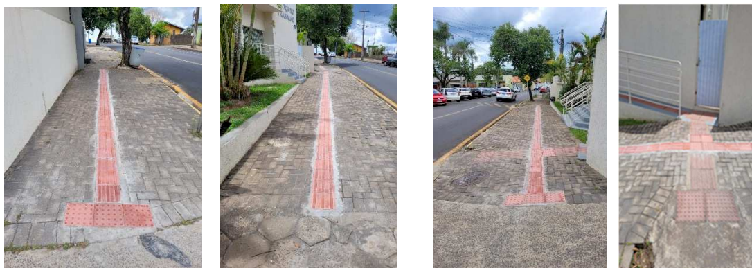
Figuras 19 – Piso tátil instalado na testada da Vara do Trabalho de Telêmaco Borba.
