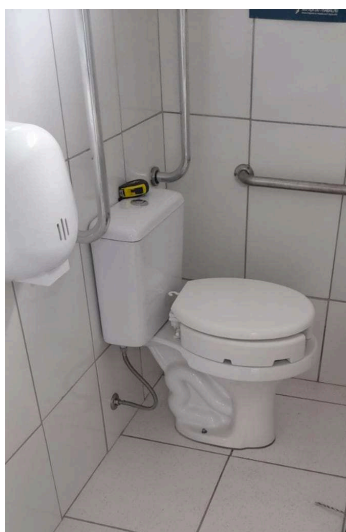
Figura 4- Vaso e assento removido de União da Vitória
