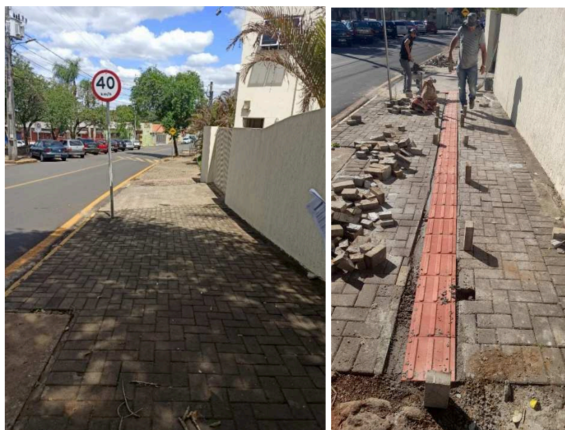
Figuras 6 – Complemento de piso tátil que ficou faltando na instrução da contratação.
