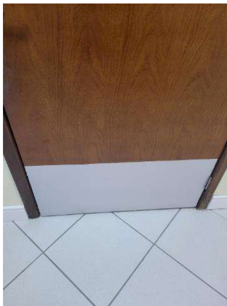
Figura 14 – Chapa de laminado na porta – Banheiro Adaptado na 5º Vara.
