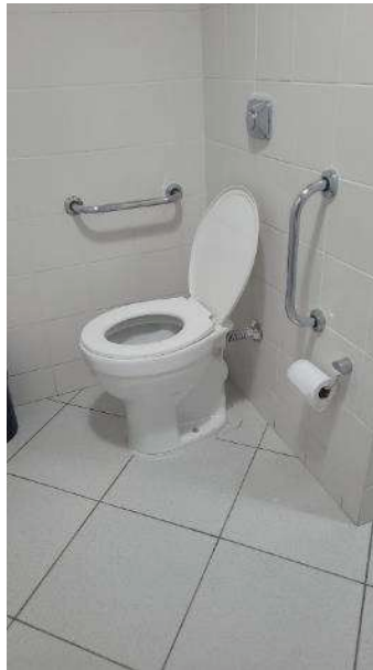
Figura 7 – Vasos Sanitários e Assentos substituídos - Banheiros Adaptados da 21ª, 22ª e 23ª Vara
