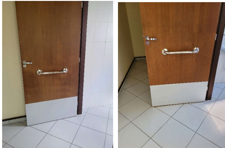
Figuras 19 – Chapas de laminado nas portas – Banheiros Públicos Adaptados no 10º Pavimento.
