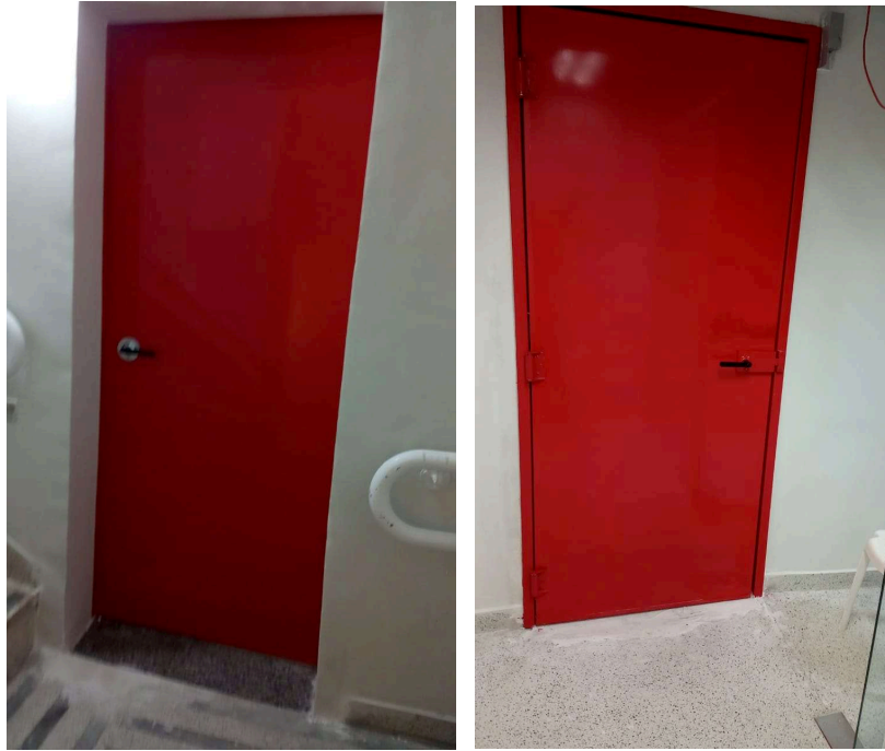
Figuras 22 – Porta corta-fogo – na sobreloja do Anexo.
