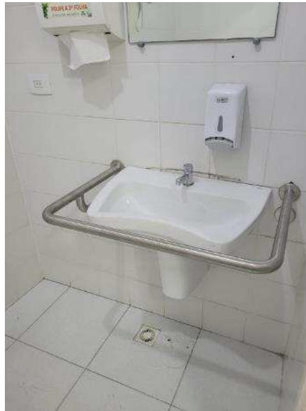
Lavatório e barra de apoio para o lavatório.
