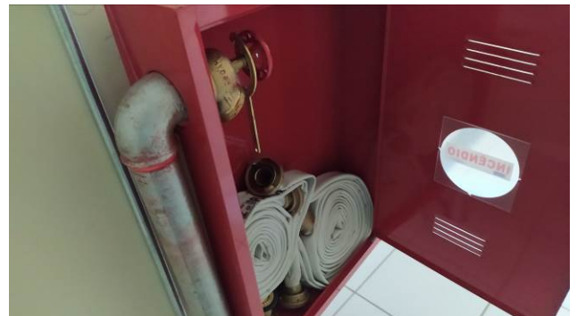
Figura 14C: Detalhe do kit interno completo e tubulação de aço galvanizado de 2 1/2", no segundo pavimento
