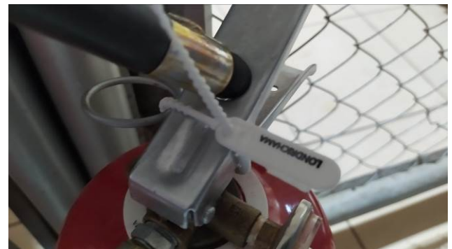
Figura 06C: Detalhe do lacre no extintor
