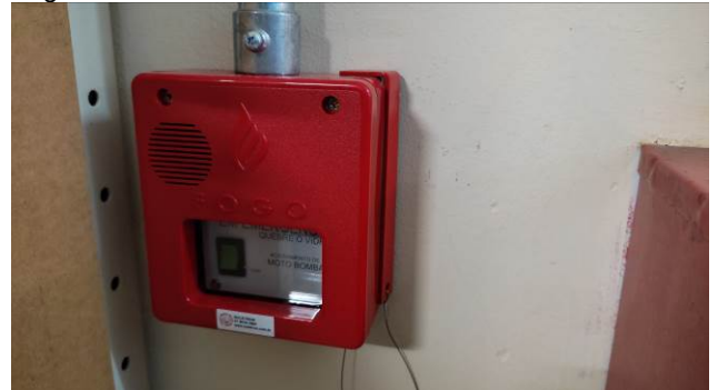
Figura 10E: sistema de acionamento da bomba hidrantes
