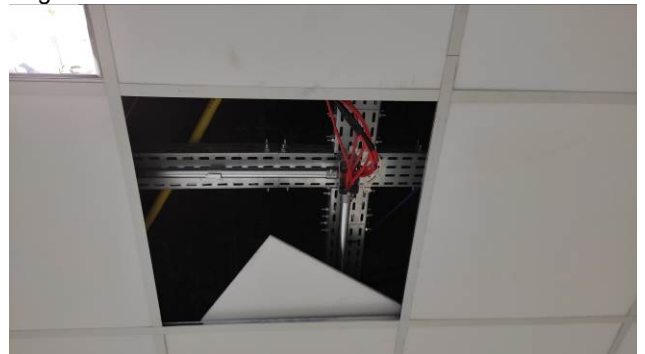
Figura 30E: sistema de acionamento da bomba hidrantes
