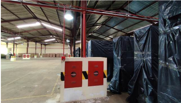
Figura 03E: sistema de acionamento da bomba hidrantes
