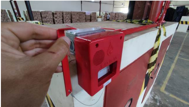
Figura 07E: sistema de acionamento da bomba hidrantes
