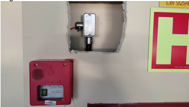
Figura 13E: sistema de acionamento da bomba hidrantes
