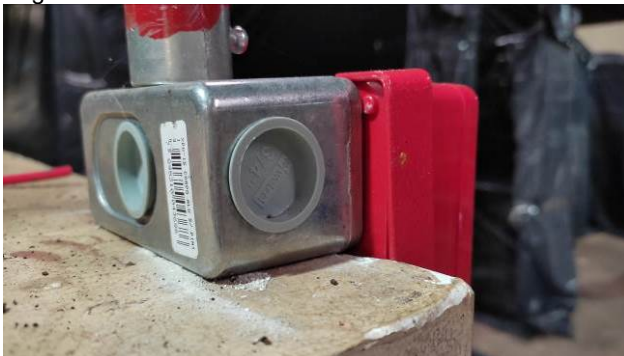
Figura 05E: sistema de acionamento da bomba hidrantes
