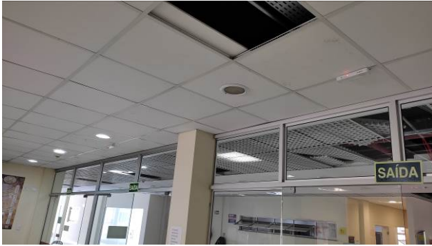
Figura 59E: iluminação de emergência Térreo FT
