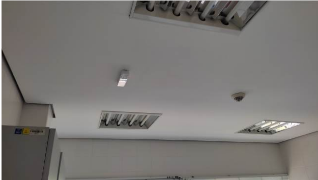
Figura 43E: iluminação de emergência 2º pavimento FT
