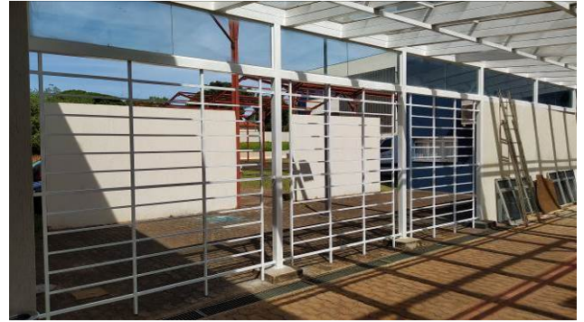
Figura 82C: Gradil de fechamento (em metalon) dos vãos existentes na região da cobertura de vidro
