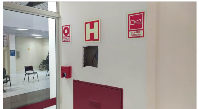
Figura 26C: Placas E1, E3 e E7, instaladas junto a hidrante, na lanchonete
