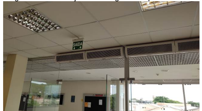
Figura 46E: iluminação de emergência 1º pavimento FT
