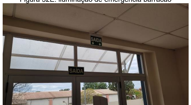
Figura 34E: iluminação de emergência barracão
