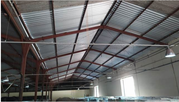
Figura 71C: Telhas termoacústicas instaladas no estacionamento – visto por baixo
