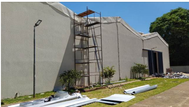
Figura 01C: Utilização de andaime no processo de remoção e instalação de telhas no barracão
