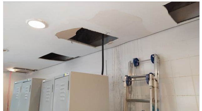
Figura 38C: Demolição de forro de gesso acartonado fixo, para passagem das tubulações de prumadas (H01 e H02), no vestiário masculino
