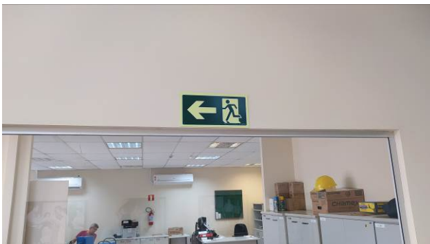
Figura 17C: Placa S2, instalada no almoxarifado da Setorial
