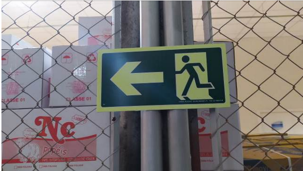
Figura 15C: Placa S2, instalada no almoxarifado da Setorial
