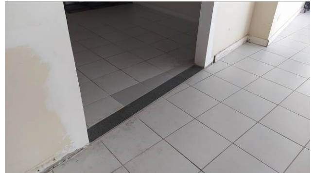
Figura 42C: Soleira em granito cinza andorinha, instalada no vão para a instalação da porta da rota de fuga do auditório
