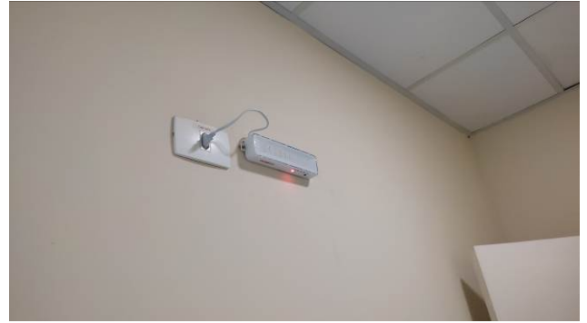
Figura 60E: iluminação de emergência Térreo FT
