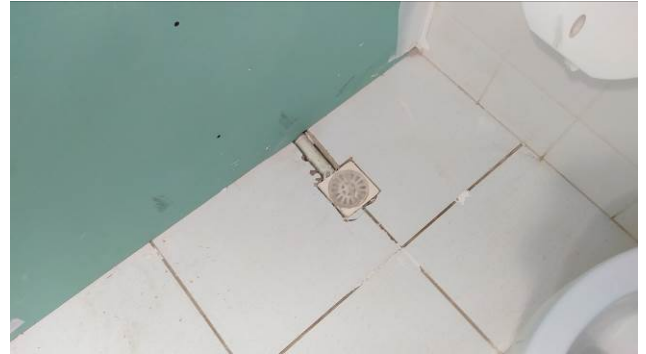
Figura 54C: Ligação do ponto de esgoto secundário em tubulação de esgoto primário, no sanitário público feminino do segundo pavimento
