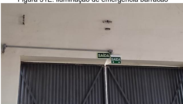
Figura 33E: iluminação de emergência barracão
