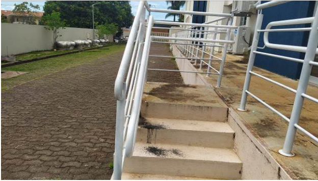
Figura 47C: Corrimão duplo, em tubos de aço galvanizado, instalado na escada de acesso ao Arquivo
