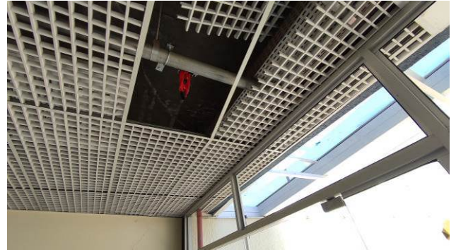
Figura 28E: sistema de acionamento da bomba hidrantes
