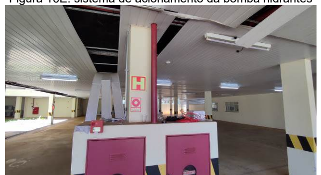
Figura 18E: sistema de acionamento da bomba hidrantes
