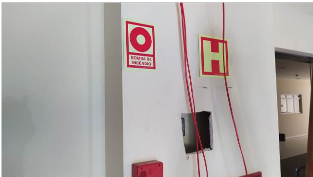
Figura 25C: Placas E3 e E7, instaladas junto a hidrante, primeiro pavimento
