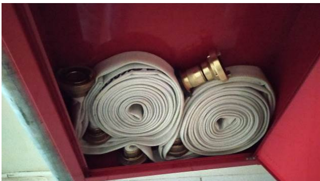
Figura 07C: Kit interno com par de mangueiras de 15m cada, esguicho e chave Storz, em hidrante localizado no primeiro pavimento do Fórum
