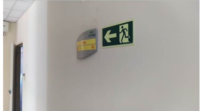
Figura 28C: Placa S2, instalada no segundo pavimento (5ª Vara)
