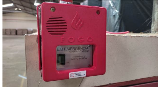
Figura 04E: sistema de acionamento da bomba hidrantes
