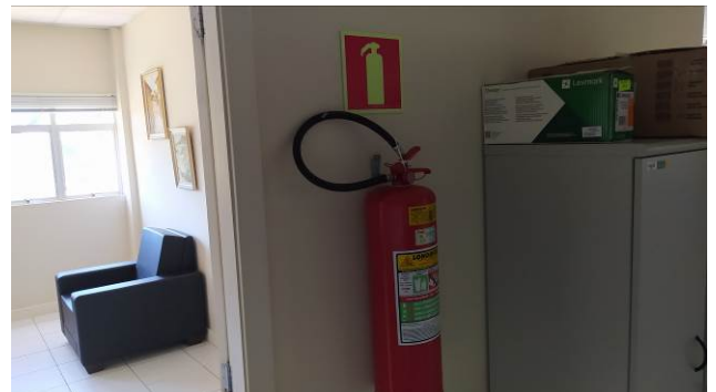
Figura 32C: Extintor de água pressurizada, de 10L, instalado na secretaria da 5ª Vara
