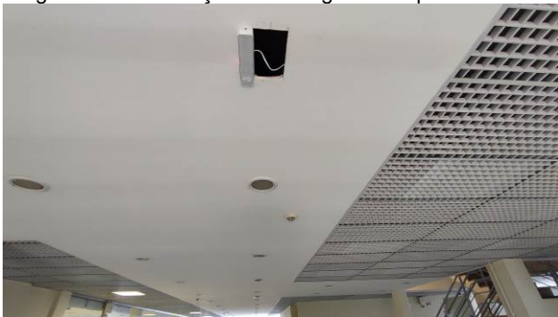
Figura 47E: iluminação de emergência 1º pavimento FT
