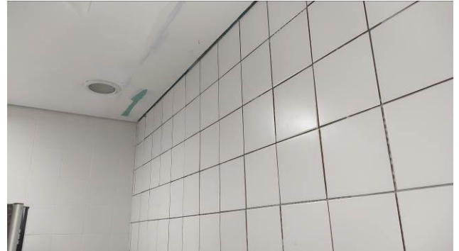
Figura 60C: Finalização da instalação dos azulejos em parede de gesso acartonado verde, no sanitário feminino do pavimento térreo. No detalhe o forro já reconstruído.
