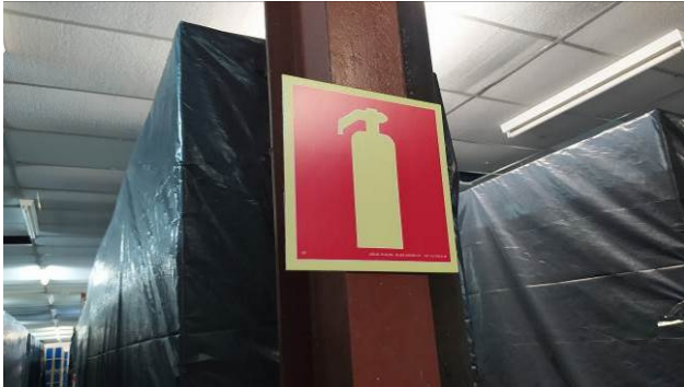
Figura 21C: Placa E5, instalada junto a extintor, no arquivo
