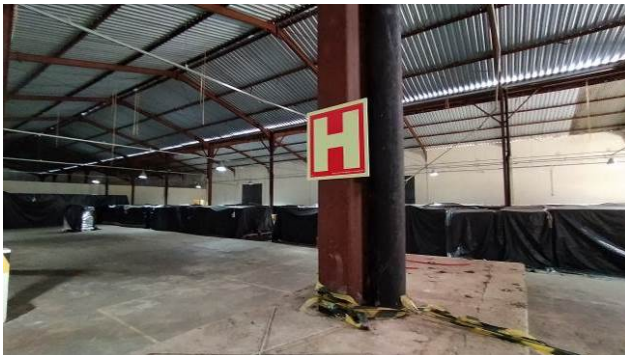
Figura 23C: Placa E7, instalada junto a hidrante, no estacionamento coberto do barracão
