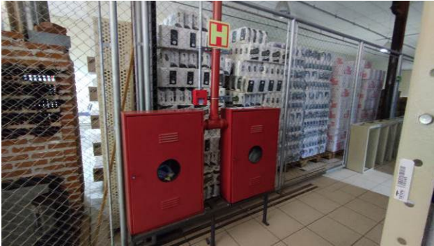
Figura 11E: sistema de acionamento da bomba hidrantes
