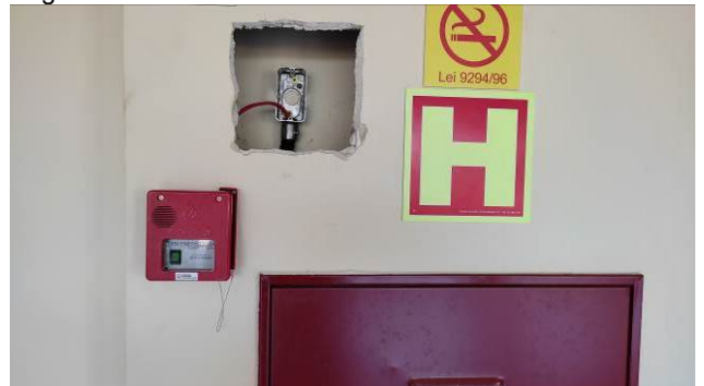
Figura 14E: sistema de acionamento da bomba hidrantes
