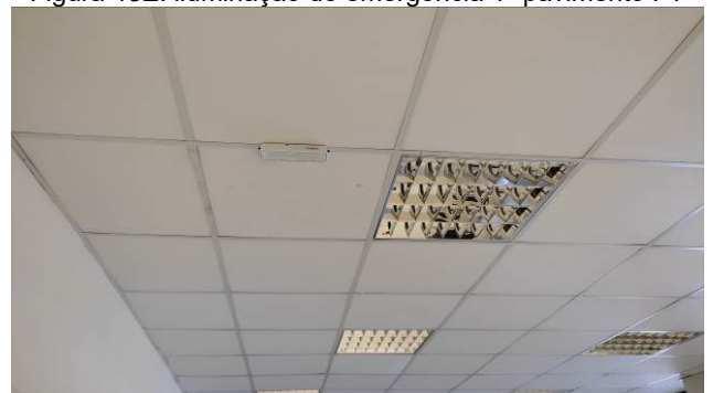
Figura 50E: iluminação de emergência 1º pavimento FT
