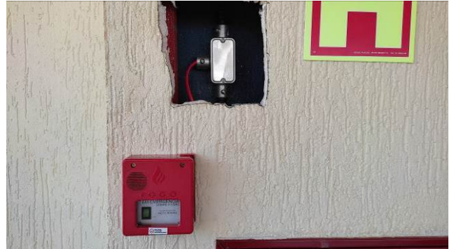
Figura 12E: sistema de acionamento da bomba hidrantes
