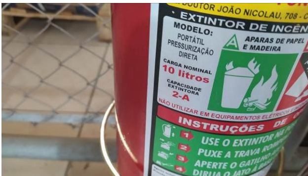
Figura 05C: Detalhe da carga do extintor de AP (10L, 2-A)
