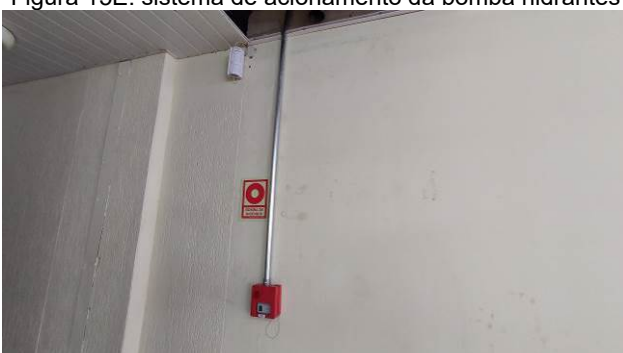
Figura 17E: sistema de acionamento da bomba hidrantes
