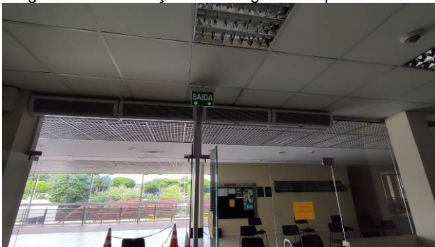
Figura 45E: iluminação de emergência 2º pavimento FT
