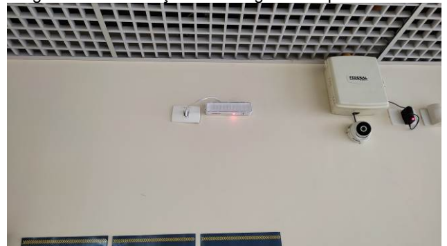
Figura 48E: iluminação de emergência 1º pavimento FT
