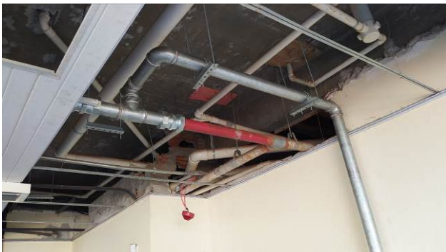
Figura 37C: Detalhe da tubulação de aço galvanizado para atender o hidrante H24 e derivação para atender às prumadas H01 e H02
