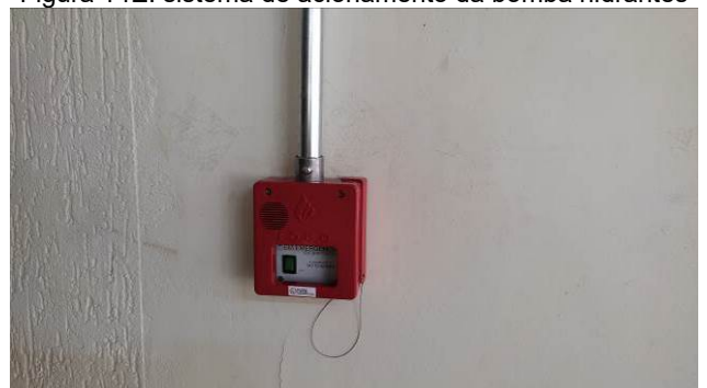
Figura 16E: sistema de acionamento da bomba hidrantes
