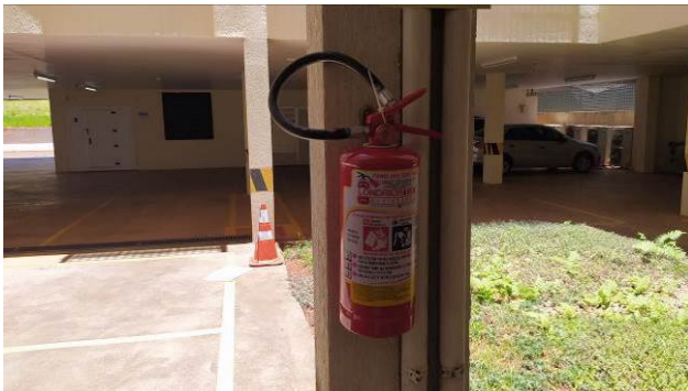
Figura 35C: Extintor de PQS 4kg, instalado no estacionamento do Fórum
