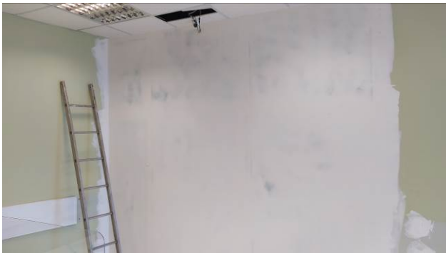
Figura 78C: Aplicação de massa corrida PVA, na parede de gesso acartonado (parede falsa), na sala de audiência 1 da 5ª Vara
