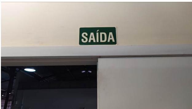
Figura 19C: Placa S12, instalada no almoxarifado da Setorial
