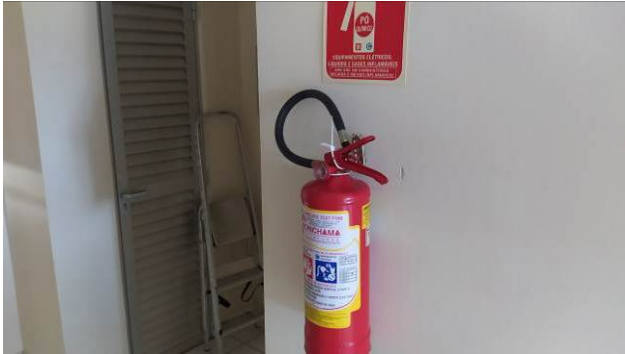
Figura 33C: Extintor de PQS 4kg, instalado no hall de circulação do bloco leste (armário técnico)
