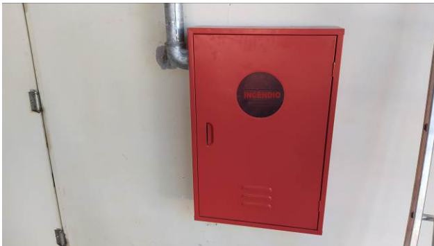
Figura 11C: Hidrante com tubulação conectada, no pavimento térreo (terraço técnico do bloco leste)
