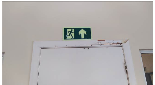
Figura 18C: Placa S3, instalada na secretaria da Setorial
