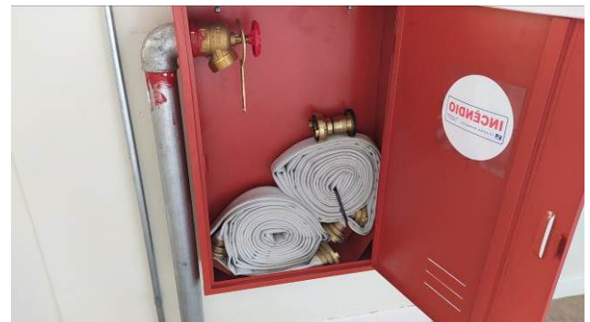
Figura 08C: Kit interno com par de mangueiras de 15m cada, esguicho e chave Storz, em hidrante localizado no segundo pavimento do Fórum
