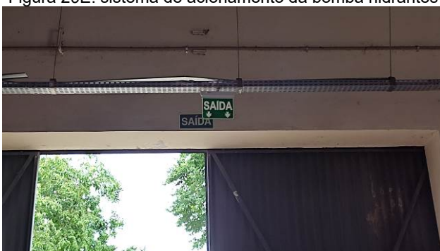
Figura 31E: iluminação de emergência barracão
