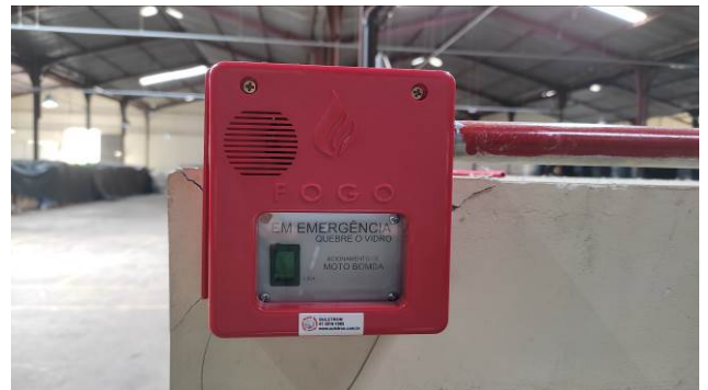
Figura 02E: sistema de acionamento da bomba hidrantes
