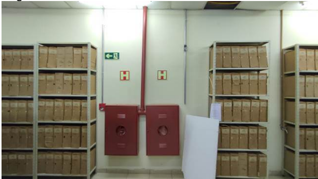
Figura 09E: sistema de acionamento da bomba hidrantes
