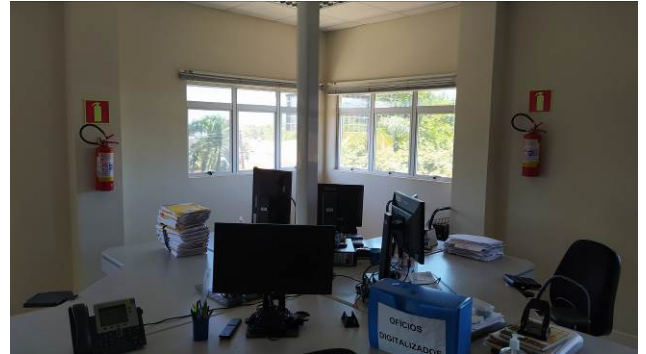
Figura 34C: Extintores de PQS 4kg, instalados na secretaria da 7ª Vara
