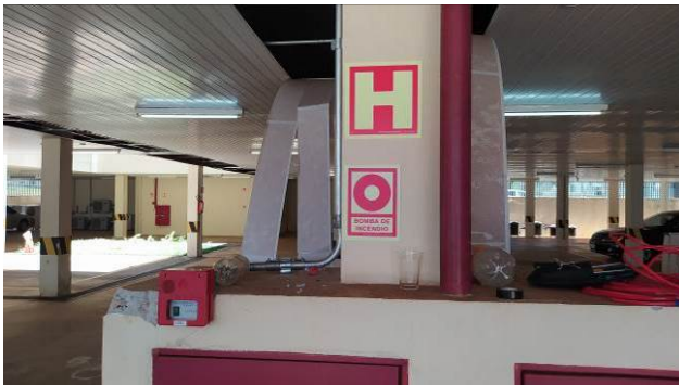
Figura 29C: Placas E3 e E7, instaladas junto a hidrante, no estacionamento do Fórum
