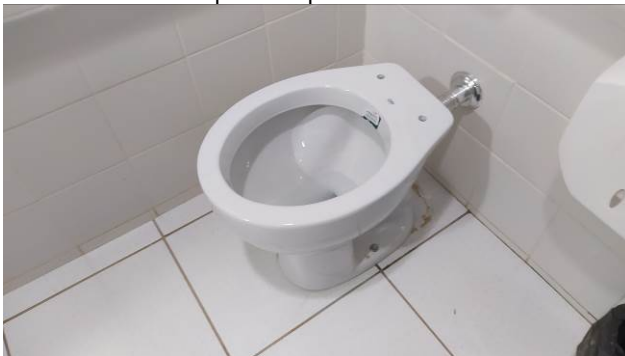
Figura 63C: Bacia sanitária instalada no BWC masculino do pavimento térreo
