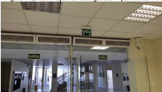
Figura 49E: iluminação de emergência 1º pavimento FT
