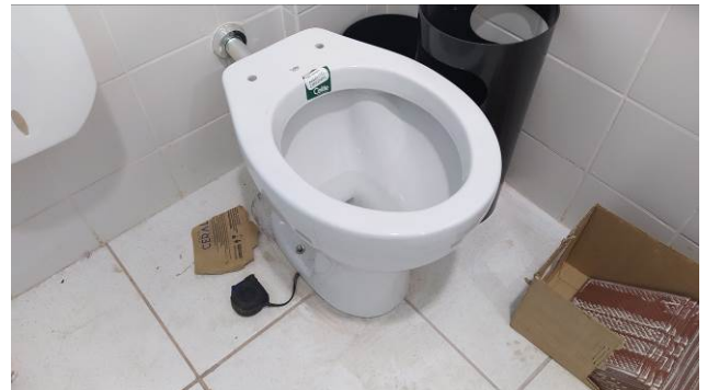
Figura 64C: Bacia sanitária instalada no BWC PNE do pavimento térreo
