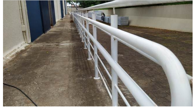
Figura 48C: Corrimão duplo, em tubos de aço galvanizado, instalado no lado direito do barracão
