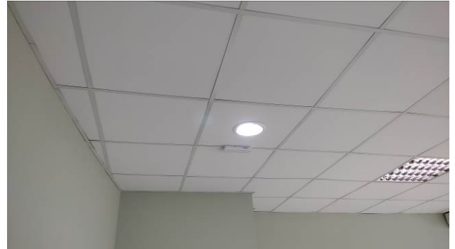
Figura 44E: iluminação de emergência 2º pavimento FT
