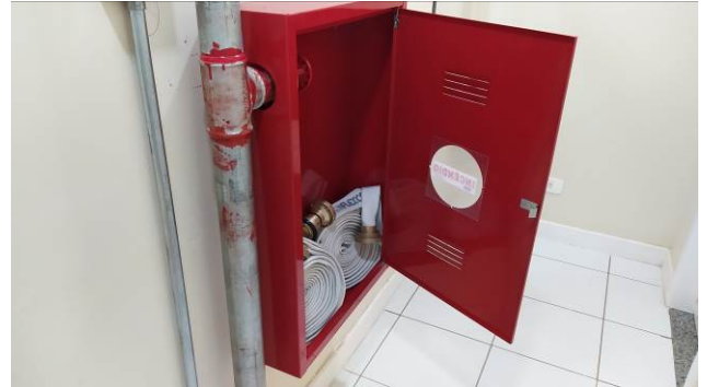
Figura 10C: Detalhe do kit interno completo e tubulação de aço galvanizado de 2 1/2", no primeiro pavimento
