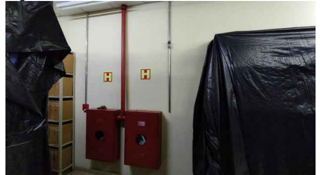
Figura 08E: sistema de acionamento da bomba hidrantes
