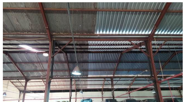
Figura 80C: Telhas termoacústicas na finalização da cobertura do trecho de estacionamento e instalação de calhas novas até o trecho onde as telhas foram substituídas
