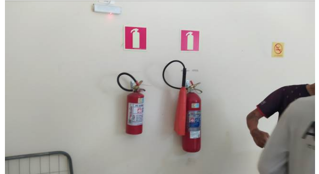
Figura 10C: Extintores de CO2 e PQS reposicionados e placas E5, fotoluminescentes, instaladas no almoxarifado da setorial
