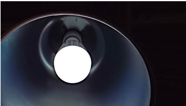
Figura 35E: Substituição de lâmpadas Vapor metálico por LED, 65W 6000lm
