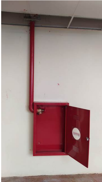
Figura 21C: Abrigo para hidrante, registro globo angular e tubo de aço galvanizado, em parede posterior da escada enclausurada do bloco oeste
