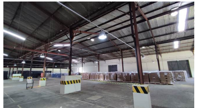
Figura 32E: Substituição de lâmpadas Vapor metálico por LED, área do barracão – antigo estacionamento coberto
