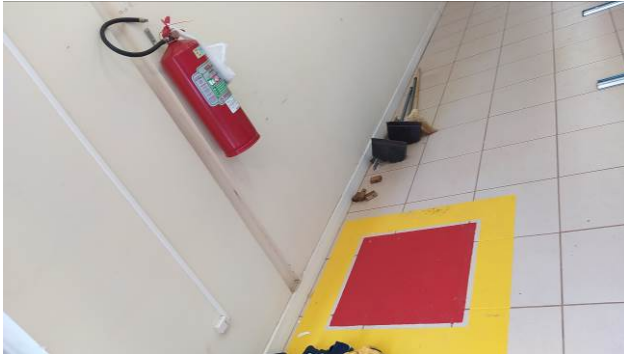
Figura 03C: Alteração da posição de extintores no arquivo. Execução de demarcação de piso (E17)
