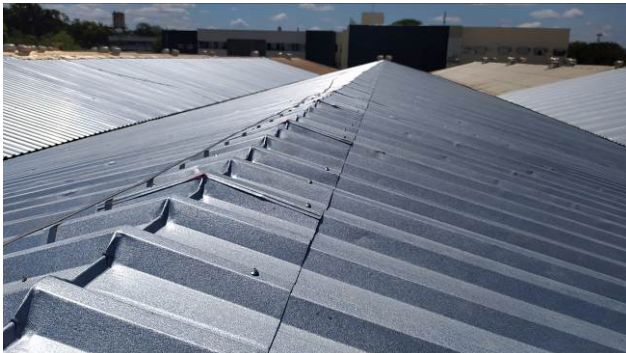
Figura 31C: Detalhe das goivas, instaladas nas cumeeiras da cobertura
