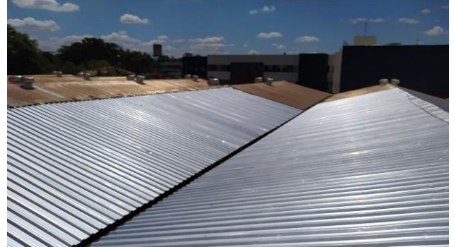
Figura 30C: Telha tipo sanduíche, instalada na cobertura do barracão (região do estacionamento)
