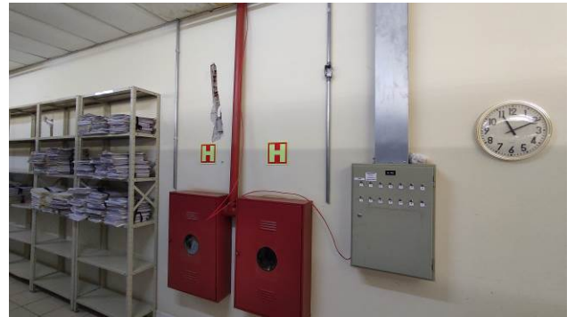
Figura 02E: Infraestrutura e cabeamento para acionamento da bomba dos hidrantes - Arquivo
