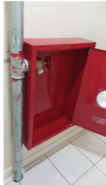
Figura 24C: Abrigo para hidrante, registro globo angular e tubo de aço galvanizado, na parede posterior da escada enclausurada do primeiro andar do bloco oeste (2ª Vara)
