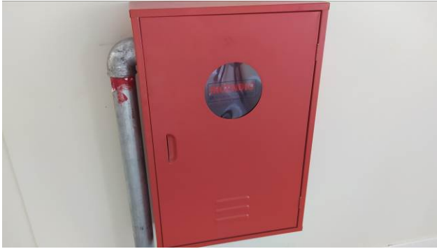
Figura 25C: Abrigo para hidrante, registro globo angular e tubo de aço galvanizado, na parede frontal da escada de incêndio, no segundo andar
