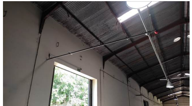
Figura 28E: Infraestrutura e cabeamento para ampliação dos circuitos de iluminação de emergência
