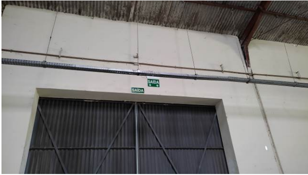
Figura 25E: Blocos de emergência tipo balizador de Saída – portas do antigo estacionamento coberto
