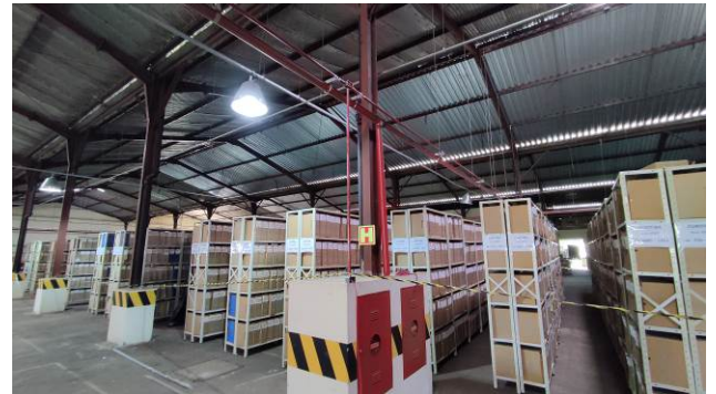
Figura 08E: Infraestrutura e cabeamento para acionamento da bomba dos hidrantes – antigo estacionamento coberto
