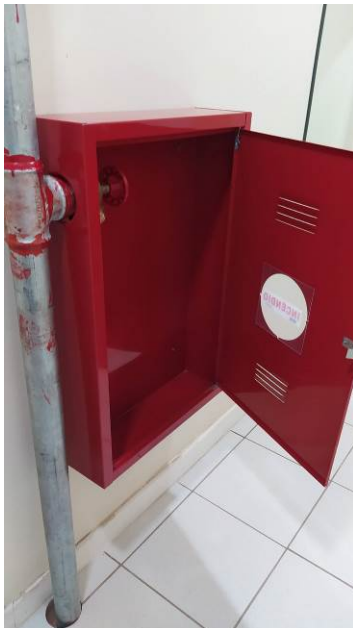
Figura 23C: Abrigo para hidrante, registro globo angular e tubo de aço galvanizado, na parede posterior da escada enclausurada do primeiro andar do bloco oeste (1ª Vara)
