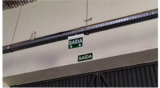
Figura 26E: Blocos de emergência tipo balizador de Saída – portas do antigo estacionamento coberto
