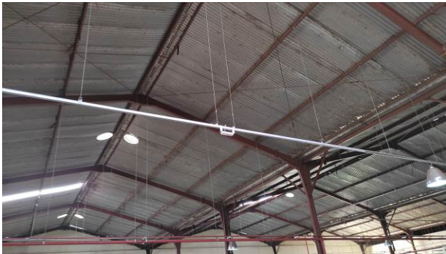
Figura 13E: Blocos de emergência – área antigo estacionamento coberto
