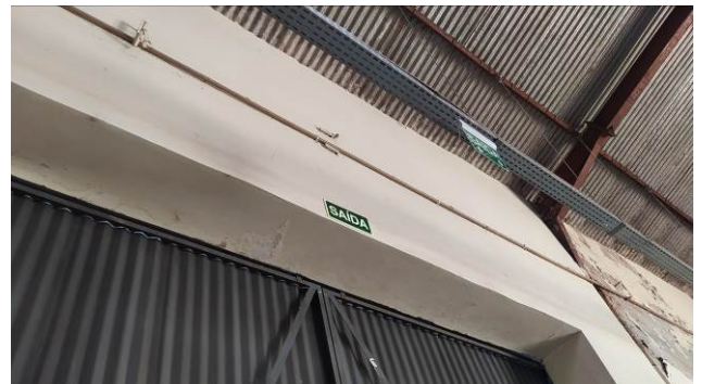
Figura 14C: Placa S12, fotoluminescente, instalada sobre porta de aço do estacionamento coberto
