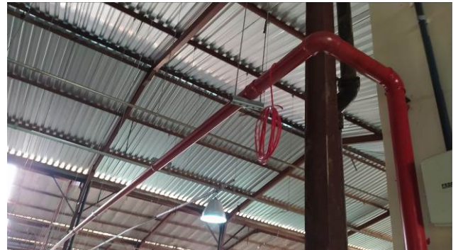
Figura 06C: Tubulação de aço galvanizado 2 1/2" instalada e pintada, no estacionamento, para atender ao abrigo recém instalado
