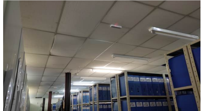
Figura 18E: Blocos de emergência – área Arquivo
