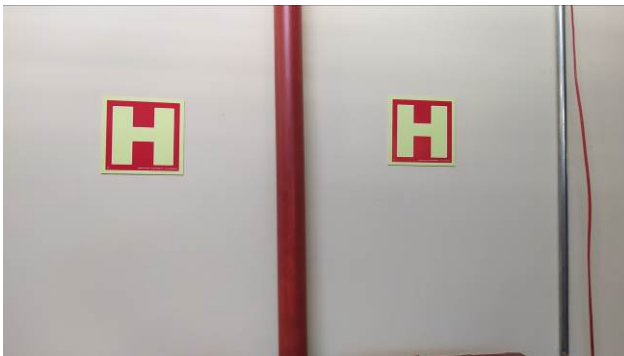
Figura 11C: Placas fotoluminescentes tipo E8, instaladas sobre hidrantes existentes, no arquivo
