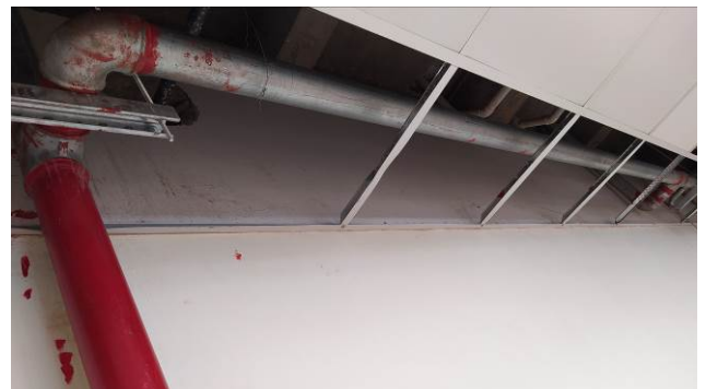
Figura 20C: Demolição de trecho do forro de PVC em réguas e instalação de tubulação de aço galvanizado 2 ½", próximo da escada enclausurada
