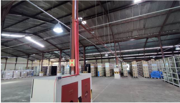
Figura 05E: Infraestrutura e cabeamento para acionamento da bomba dos hidrantes – antigo estacionamento coberto
