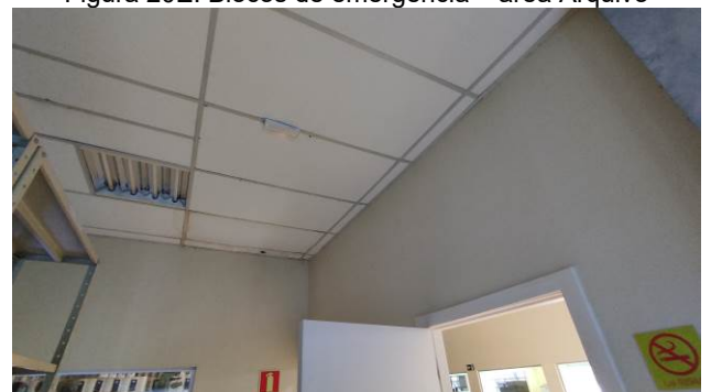
Figura 22E: Blocos de emergência – área depósito
