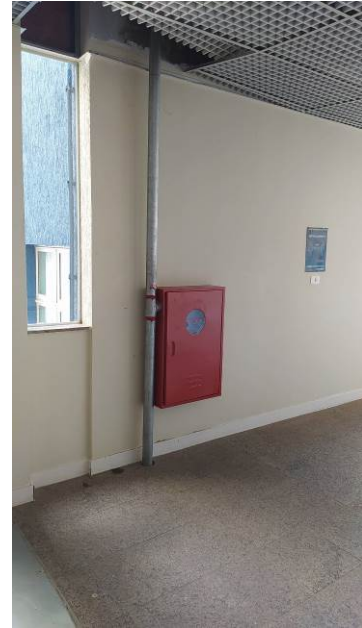
Figura 22C: Abrigo para hidrante, registro globo angular e tubo de aço galvanizado, na parede frontal da escada de incêndio do primeiro andar
