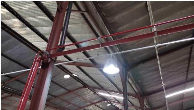
Figura 07E: Infraestrutura e cabeamento para acionamento da bomba dos hidrantes – antigo estacionamento coberto
