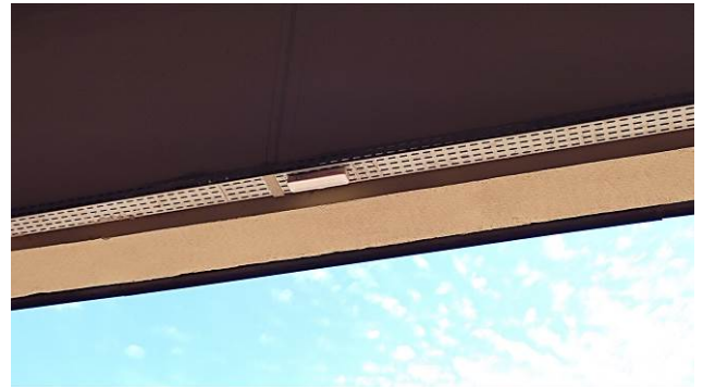
Figura 14E: Blocos de emergência – área antigo estacionamento coberto
