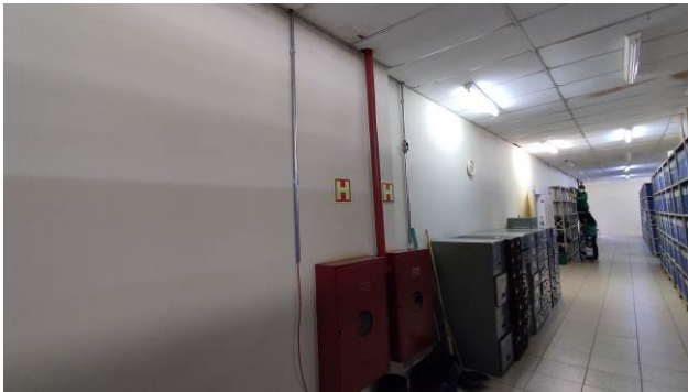
Figura 01E: Infraestrutura e cabeamento para acionamento da bomba dos hidrantes - Arquivo
