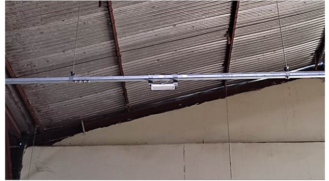
Figura 12E: Blocos de emergência – área antigo estacionamento coberto
