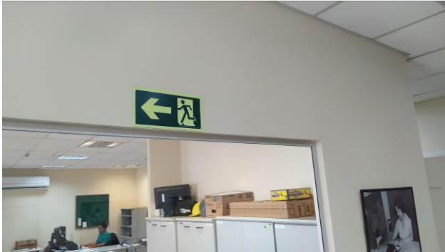
Figura 09C: Placa tipo S2, instalada em parede da secretaria da setorial
