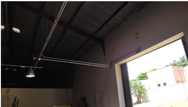
Figura 27E: Infraestrutura e cabeamento para ampliação dos circuitos de iluminação de emergência
