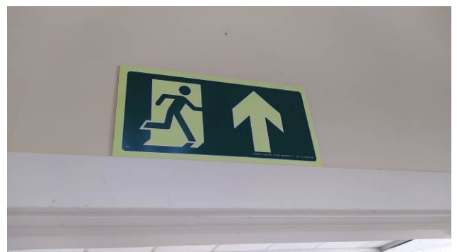
Figura 08C: Placa tipo S3, instalada na porta de saída da setorial
