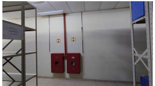
Figura 04E: Infraestrutura e cabeamento para acionamento da bomba dos hidrantes - Arquivo
