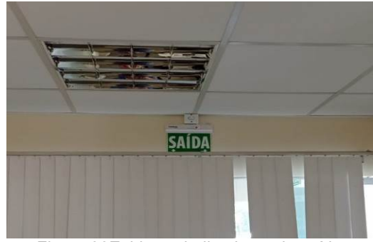
Figura 08E: blocos balizadores de saída
