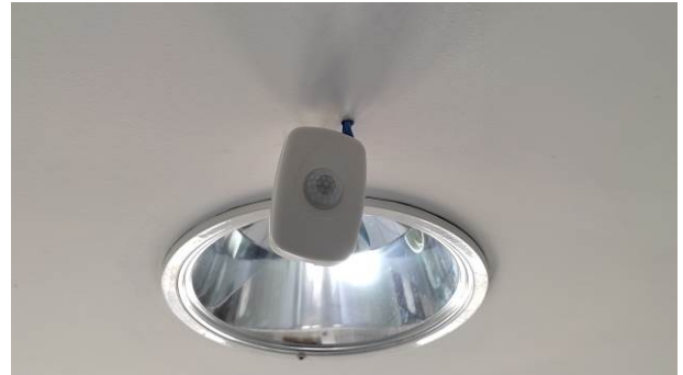
Figura 31E: Sensor de presença em banheiro público PNE - iluminação
