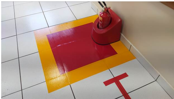
Figura 23C: Extintor de PQS 4kg 20B-C, instalado no hall público e sinalização de solo E17
