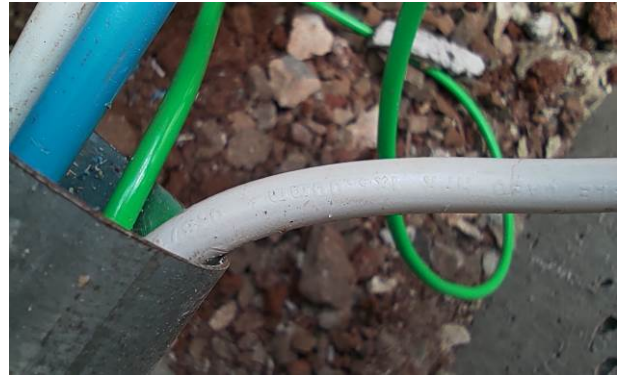
Figura 29E: Ramal alimentador para edificação fundos
