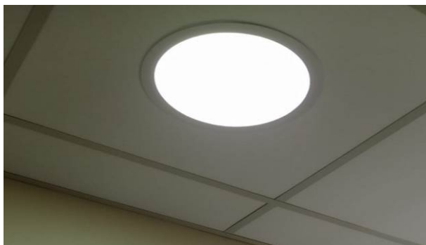
Figura 18E: lâmpadas LED bulbo em plafon
