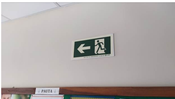
Figura 25C: Placa S2, instalada no hall público
