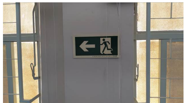
Figura 26C: Placa S2, instalada na secretaria
