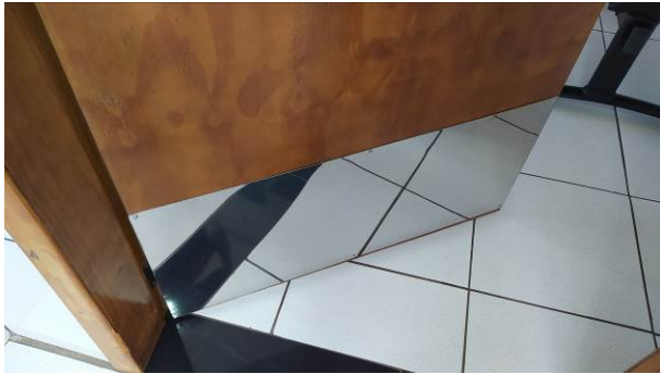
Figura 36C: Placa em laminado melamínico, instalada na porta do sanitário PNE
