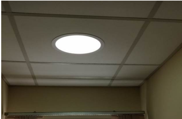
Figura 16E: lâmpadas LED bulbo em plafon
