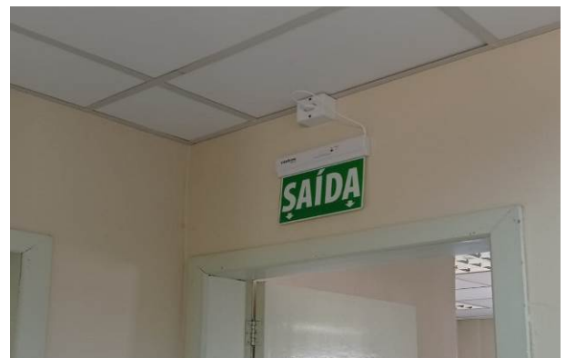
Figura 06E: blocos balizadores de saída
