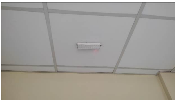
Figura 01E: blocos de emergência
