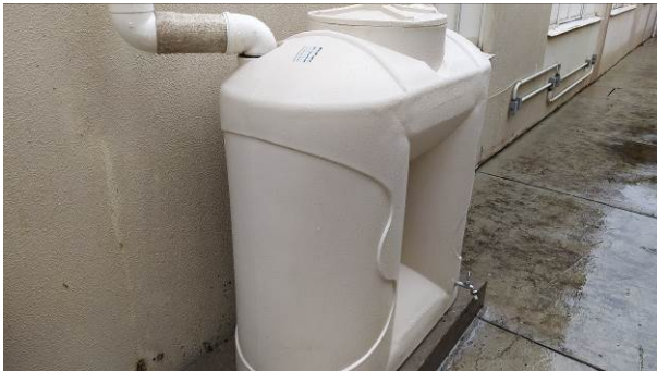
Figura 29C: Cisterna de reuso, instalada ao lado da sala técnica
