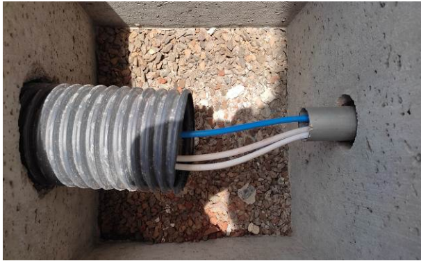
Figura 28E: Ramal alimentador para edificação fundos
