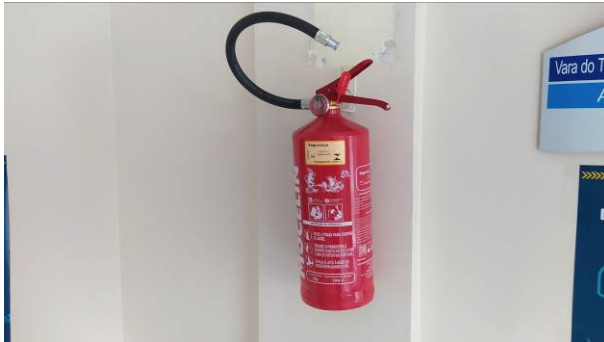
Figura 19C: Extintor de PQS 4kg 20B-C, instalado na sala de audiência
