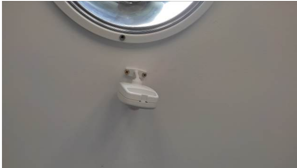
Figura 30E: Sensor de presença em banheiro público PNE - iluminação
