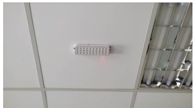
Figura 02E: blocos de emergência
