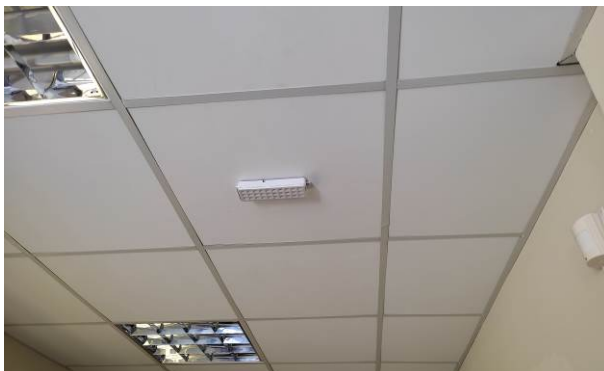
Figura 03E: blocos de emergência
