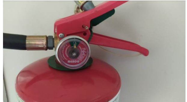
Figura 20C: Verificação do nível de carga do extintor
