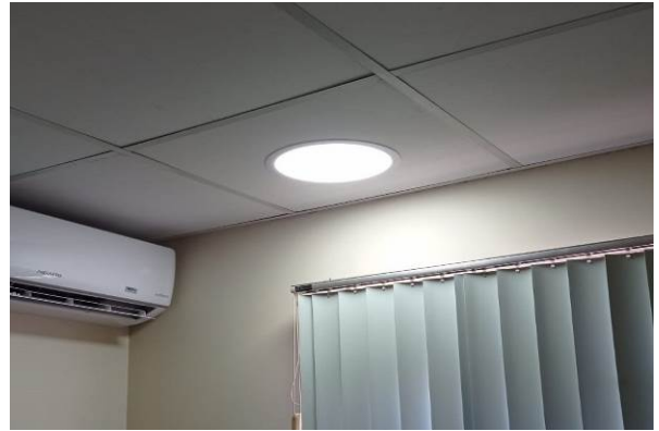
Figura 17E: lâmpadas LED bulbo em plafon
