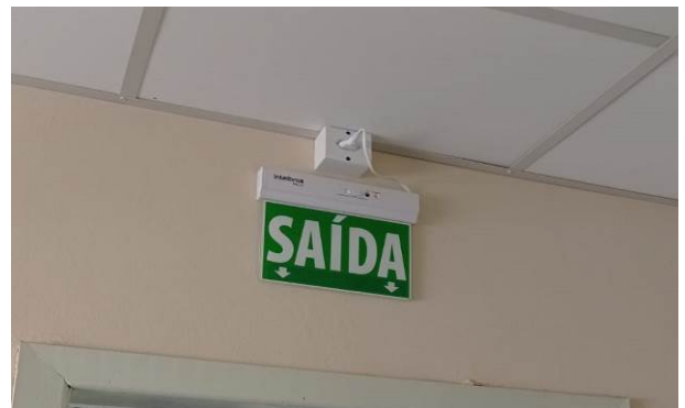
Figura 04E: blocos balizadores de saída
