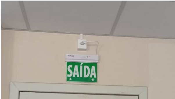
Figura 07E: blocos balizadores de saída
