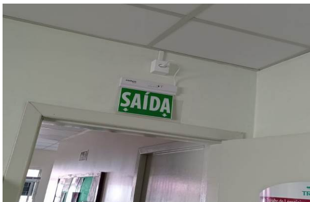
Figura 05E: blocos balizadores de saída
