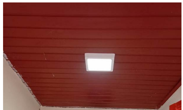
Figura 15E: plafon LED banheiro edícula
