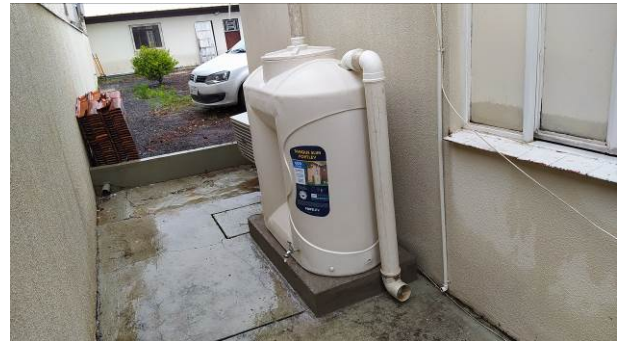
Figura 30C: Cisterna de reuso, instalada ao lado da sala técnica
