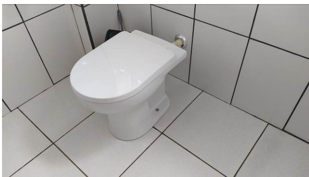
Figura 34C: Vaso sanitário PNE, instalado no banheiro público
