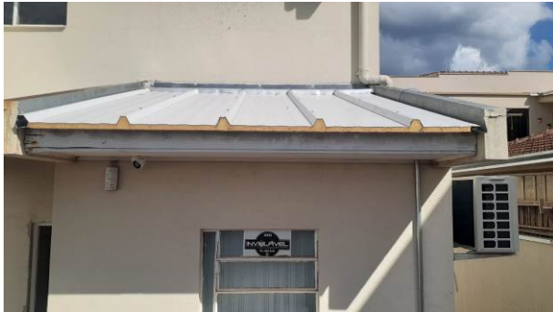
Figura 48C: Telha termoacústica instalada na cobertura da sala técnica (anexo ao prédio principal)
