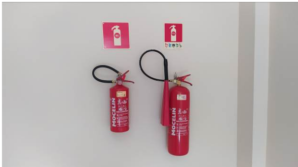
Figura 15C: Placas E5, instaladas junto a extintores (PQS de 4kg e CO2 de 6kg) localizados na sala do no-break
