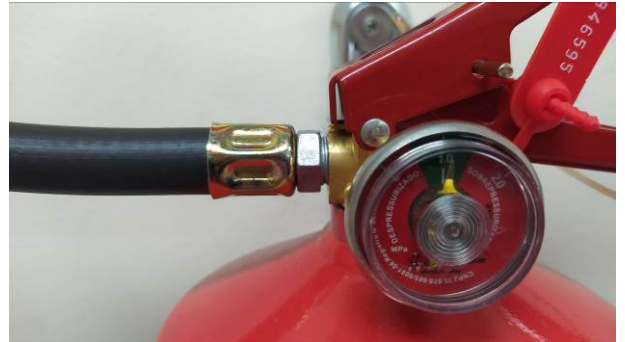
Figura 12C: Detalhe da verificação da carga de um extintor
