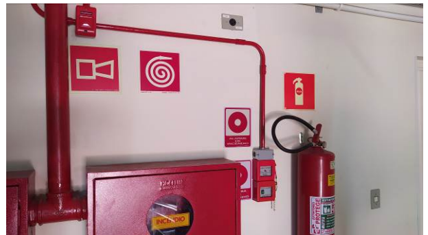
Figura 06C: Placas E1, E2, E3 e E7, instaladas junto a hidrantes, na setorial. Placa E5 sobre extintor
