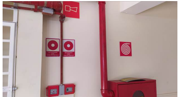
Figura 16C: Placas E1, E2, E3 e E7, instaladas junto á hidrante no estacionamento da 1ª Vara
