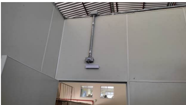
Figura 25E: blocos de emergência
