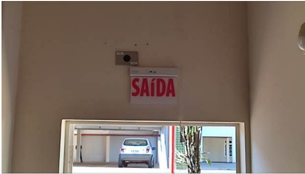
Figura 27E: blocos de emergência balizadores de saída
