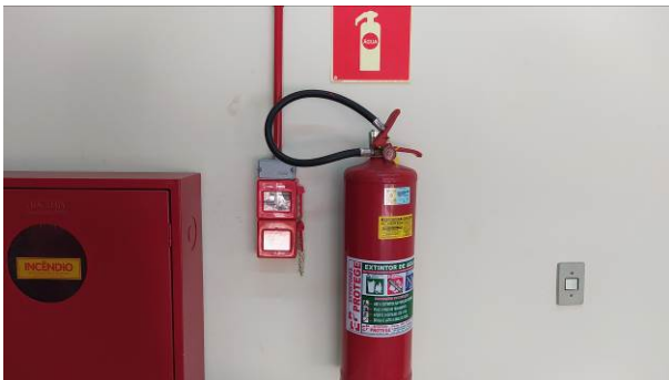
Figura 05C: Placa E5, instalada junto a extintor de água, na setorial
