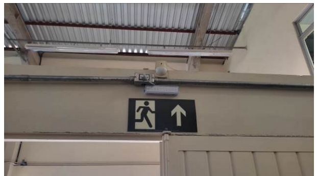
Figura 24E: blocos de emergência
