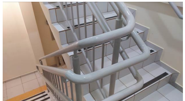
Figura 32C: Adaptação da altura dos guarda-corpos e pintura da escada da 1ª vara
