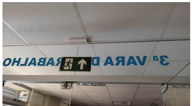
Figura 26E: blocos de emergência
