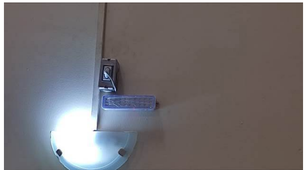
Figura 22E: blocos de emergência
