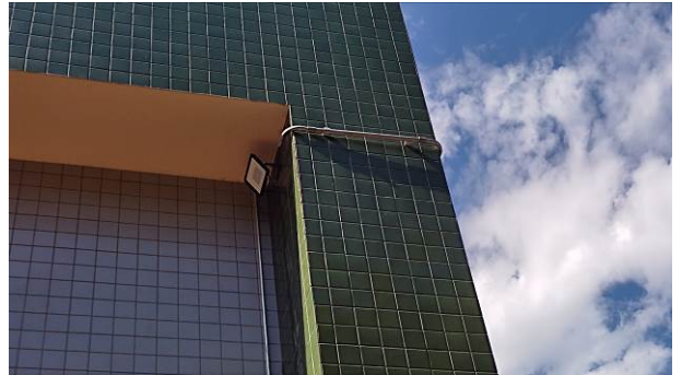
Figura 36E: projetores externos entrada veículos e estacionamento aberto
