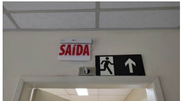
Figura 30E: blocos de emergência balizadores de saída
