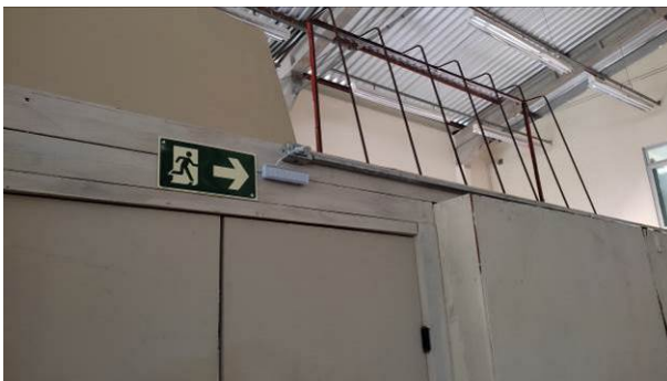
Figura 23E: blocos de emergência
