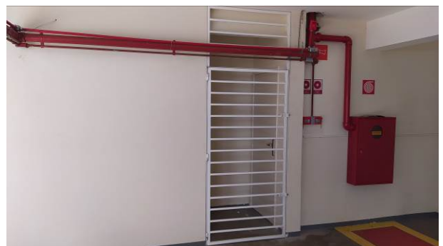
Figura 54C: Portão em gradil metálico, instalado na porta de acesso à escada da 1ª vara
