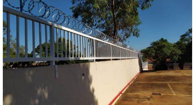
Figura 38C: Execução do gradil metálico sobre o muro lateral esquerdo e instalação de concertina dupla – parte central
