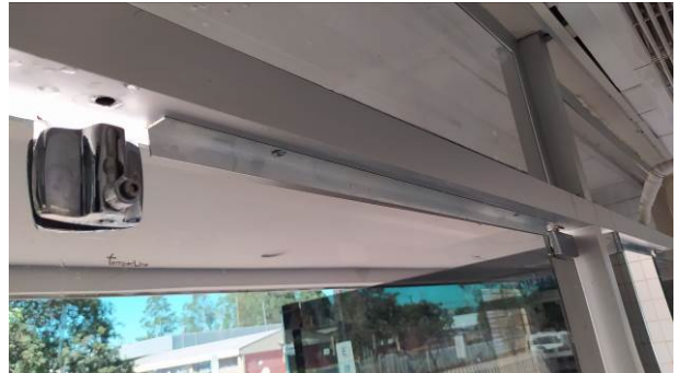
Figura 64C: Instalação de perfil em cantoneira de alumínio, para impedir a abertura das portas para dentro (portas com barra antipânico no acesso principal)
