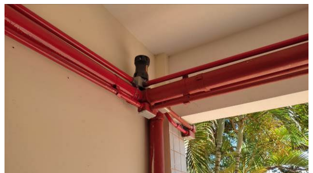
Figura 16E: sirene relativa ao acionamento da bomba de incêndios
