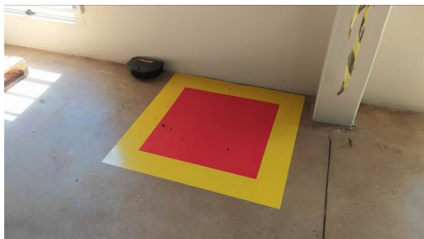
Figura 02C: Sinalização de solo, tipo E17, executada no almoxarifado da setorial, junto a extintor de incêndio
