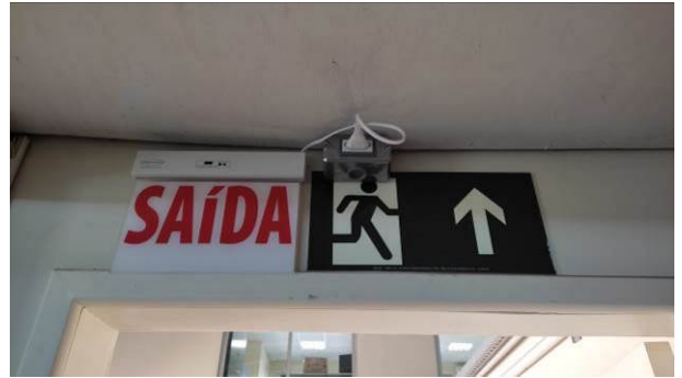
Figura 28E: blocos de emergência balizadores de saída
