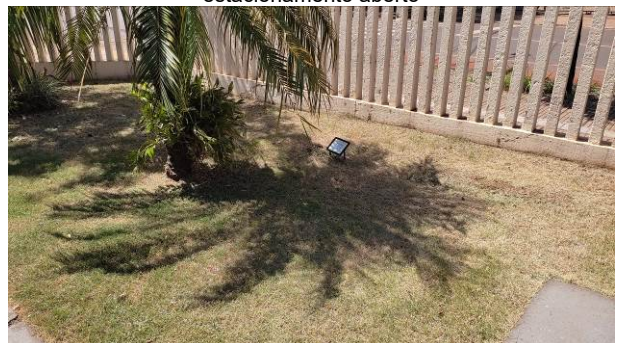
Figura 38E: projetores externos fachada
