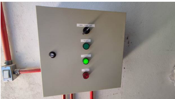
Figura 17E: Quadro de comandos da bomba de incêndios
