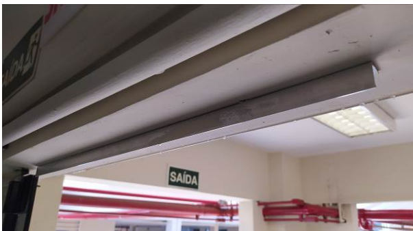
Figura 65C: : Instalação de perfil em cantoneira de alumínio, para impedir a abertura das portas para dentro (portas com barra antipânico no hall do auditório)
