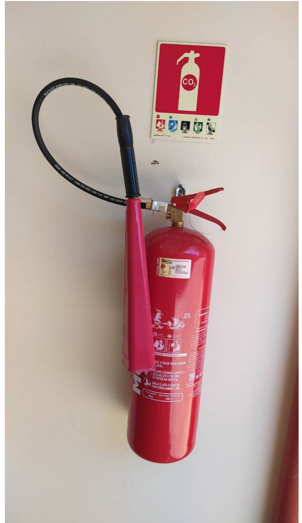
Figura 08C: Extintor de CO2 (6kg) instalado na sala do reservatório de incêndio, com placa E5 acima
