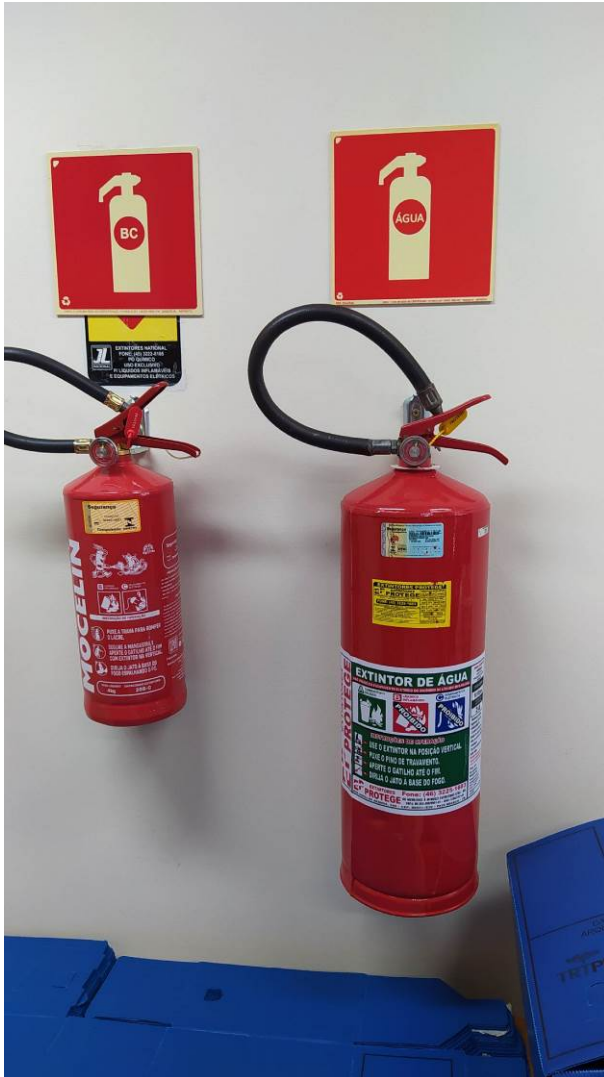
Figura 07C: Extintores de PQS (4kg) e AP (10L), instalados no pavimento inferior. Placas E5 acima dos extintores
