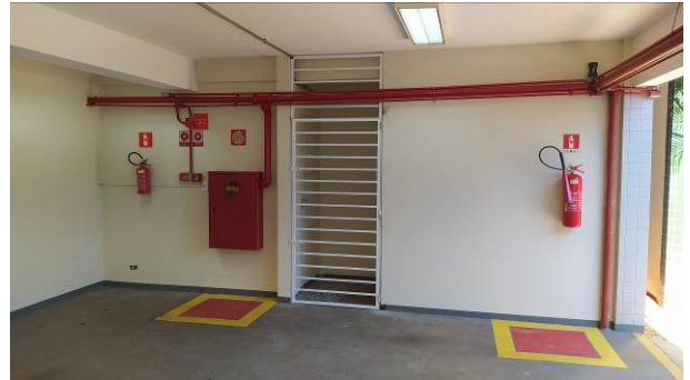
Figura 52C: Portão em gradil metálico, instalado na porta de acesso à escada da 2ª vara
