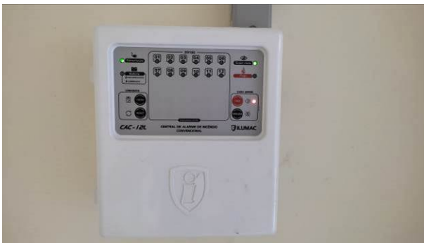
Figura 01E: central de alarme de incêndios
