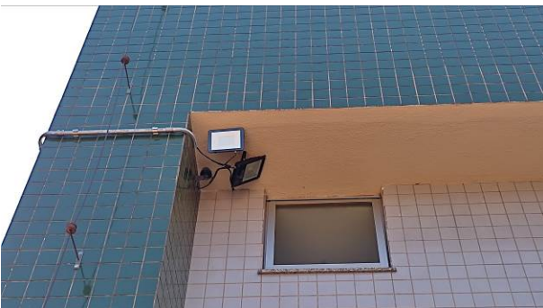
Figura 37E: projetores externos entrada veículos e estacionamento aberto
