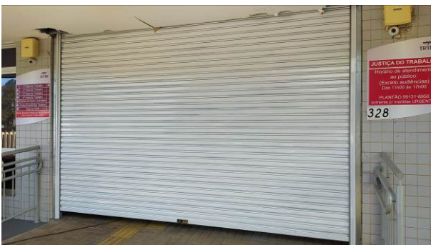
Figura 57C: Porta metálica de enrolar, instalada na entrada principal
