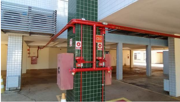
Figura 19C: Placas E1, E2 e E3, instaladas em hidrante, no estacionamento da 4ª vara
