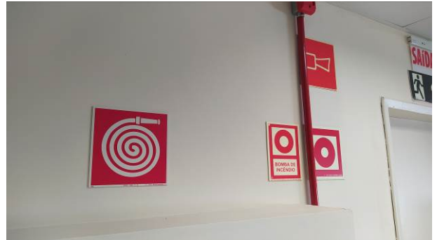
Figura 28C: Placas E1, E2, E3 e E7, instaladas junto a hidrante da 2ª vara
