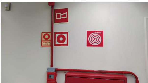
Figura 29C: Placas E1, E2, E3 e E7, instaladas junto a hidrante da 3ª vara
