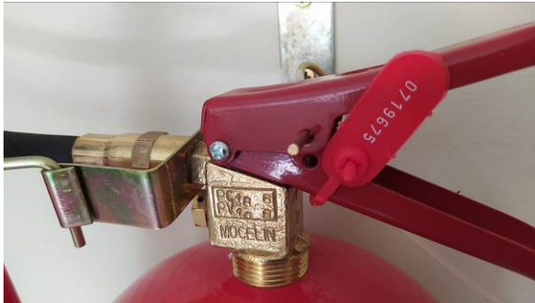
Figura 11C: Detalhe da verificação do lacre de um extintor
