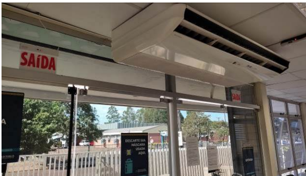
Figura 29E: blocos de emergência balizadores de saída
