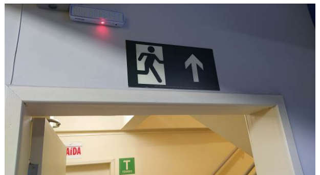
Figura 14C: Placa S3, instalada na porta de saída do arquivo da 1ª vara
