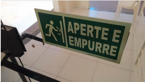
Figura 67C: Placas de sinalização "Aperte e empurre" instaladas na face interna das portas do hall do auditório
