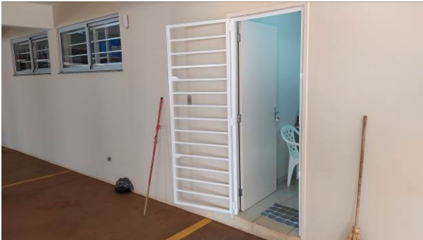
Figura 51C: Portão em gradil metálico, instalado na porta de acesso à copa dos terceirizados
