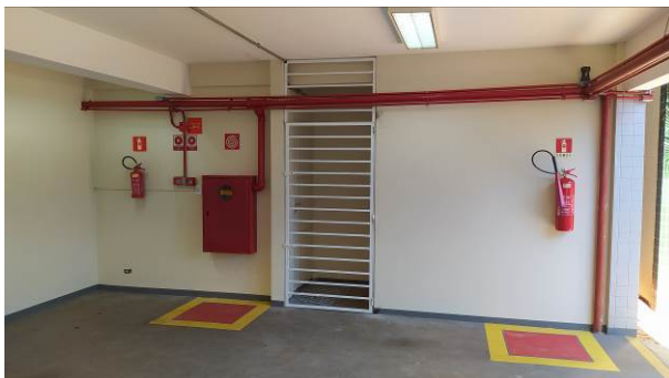
Figura 17C: Placas E1, E2, E3, E5 e E7, instaladas junto a hidrante e extintores no estacionamento da 2ª vara
