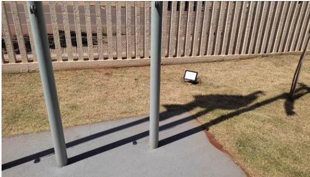
Figura 39E: projetores externos fachada
