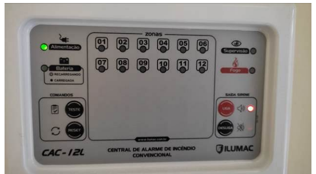
Figura 02E: central de alarme de incêndios
