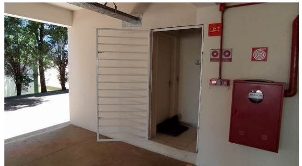
Figura 56C: Portão em gradil metálico, instalado na porta de acesso à escada da 3ª vara
