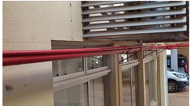
Figura 10E: infra para SDAI e acionamento bombas
