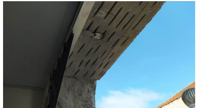
Figura 12C: Picoteamento do reboco no perímetro do vão de janela para melhor aderência do requadro
