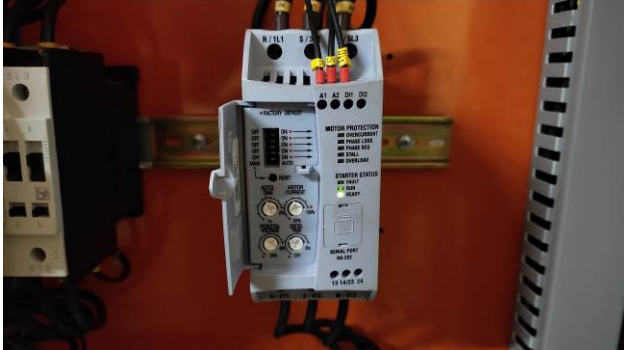
Figura 21E: Softstarter Quadro Hidrantes
