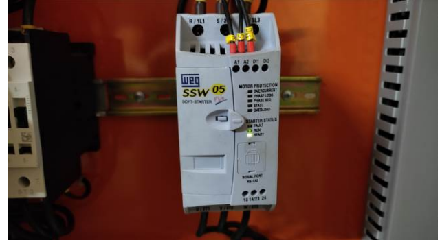
Figura 22E: Softstarter Quadro Hidrantes
