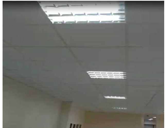
Figura 18E: Luminárias 4x10W
