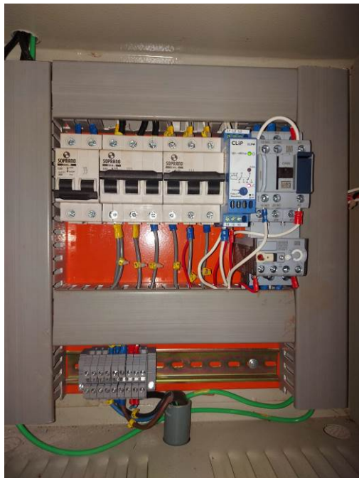
Figura 03E: Quadro de comandos e ramal alimentador
