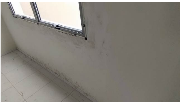
Figura 49C: Preparo de parede com aplicação de massa PVA e lixamento, no primeiro pavimento – sala dos assistentes
