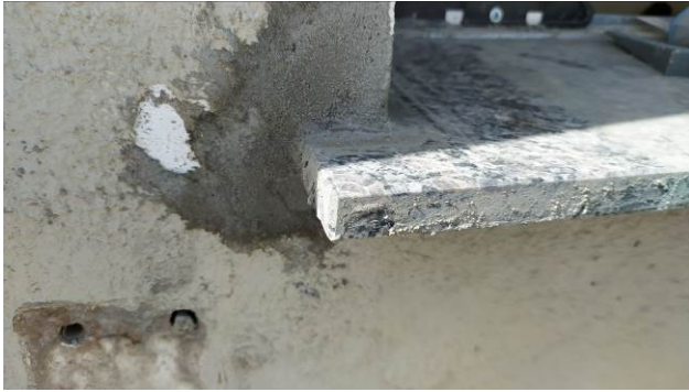
Figura 15C: Detalhe do avanço do peitoril no canto da parede, em vão de janela do primeiro andar
