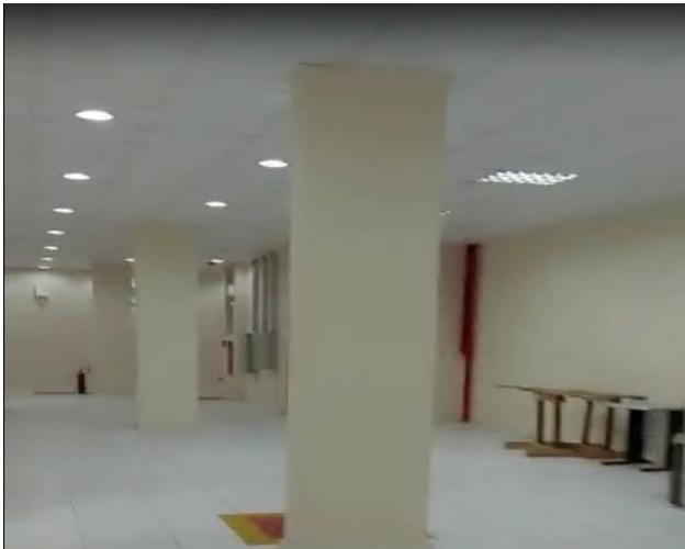
Figura 17E: Luminárias 4x10W
