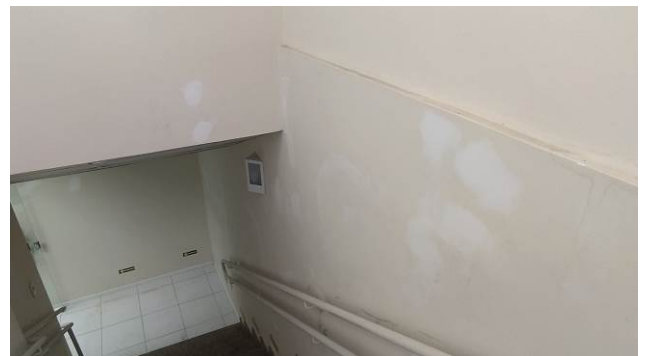
Figura 48C: Preparo de parede com aplicação de massa PVA e lixamento, no segundo pavimento – escada de acesso
