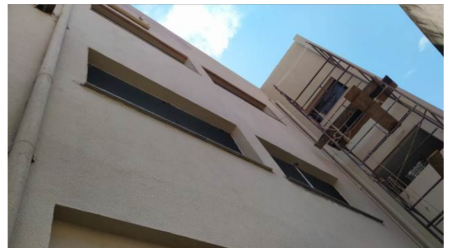
Figura 30C: Região onde foram realizadas diversas recuperações de revestimento (principalmente acima e abaixo de vãos de janelas)
