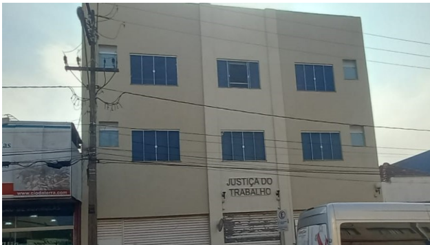
Figura 35C: Aplicação de uma demão de látex acrílico na fachada frontal do fórum
