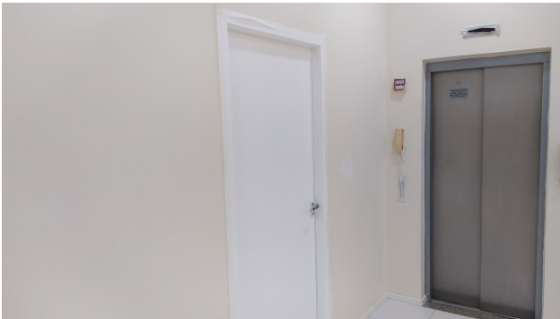
Figura 41C: Aplicação de uma demão esmalte sintético em portas, na região da sala da OAB, do pavimento térreo
