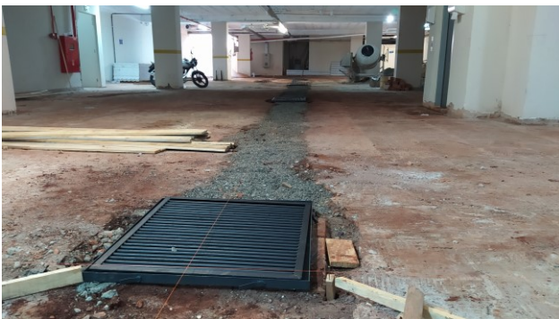
Figura 31C: Detalhe da primeira caixa de coleta (nos fundos do imóvel) e caminho da rede de coleta pluvial (brita)
