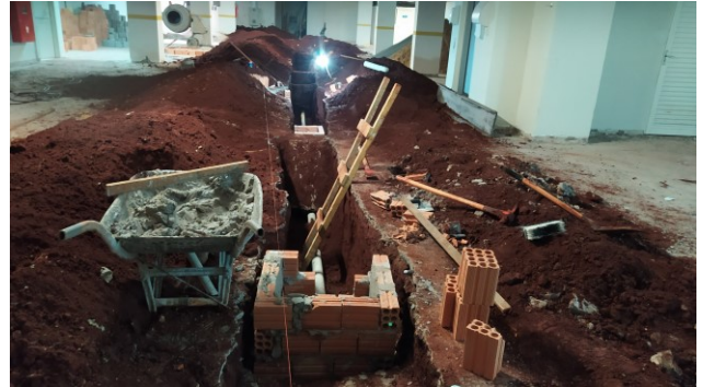
Figura 28C: Execução das caixas de coleta em alvenaria e ligação com tubos de PVC de 100mm
