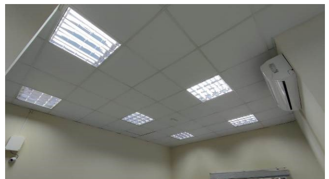
Figura 10E: Lâmpadas tubulares LED 9W instaladas
