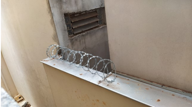
Figura 47C: Concertina instalada em um dos trechos vulneráveis do muro posterior
