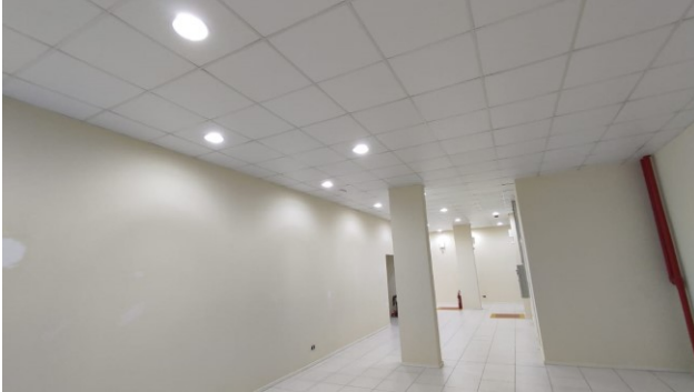
Figura 39C: Aplicação de uma demão de látex acrílico nas paredes do hall público, no pavimento térreo
