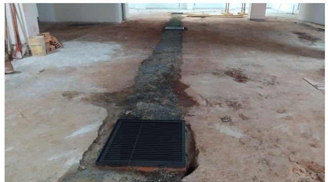
Figura 32C: Detalhe de uma caixa de coleta intermediária e caminho da rede de coleta pluvial, onde as valas foram reaterradas
