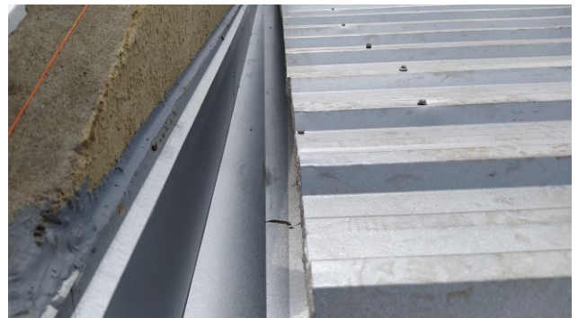
Figura 17C: Verificação da vedação da calha e do alinhamento da telha no balanço da calha – região do retângulo frontal
