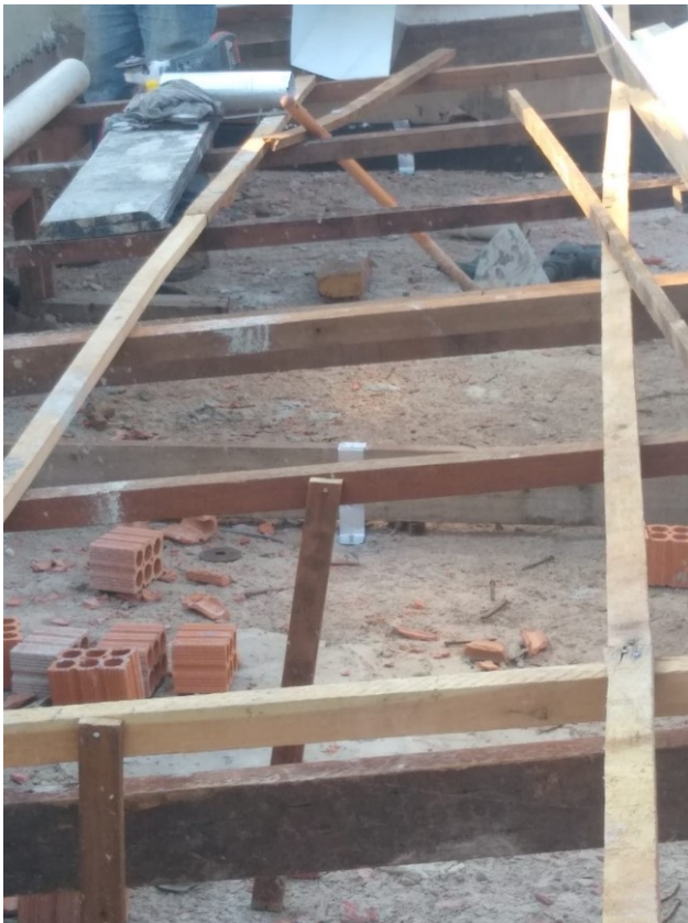
Figura 10C: Execução do madeiramento da cobertura (área do retângulo frontal) em uma água
