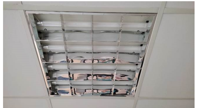
Figura 08E: Lâmpadas tubulares LED 9W instaladas
