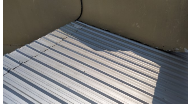
Figura 13C: Telhas metálicas tipo sanduíche, com preenchimento em EPS, instaladas na cobertura dos fundos (duas águas e goiva)
