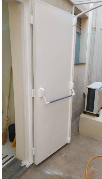
Figura 45C: Detalhe de porta corta-fogo após aplicação de uma demão de esmalte sintético branco, na saída do hall público, no pavimento térreo
