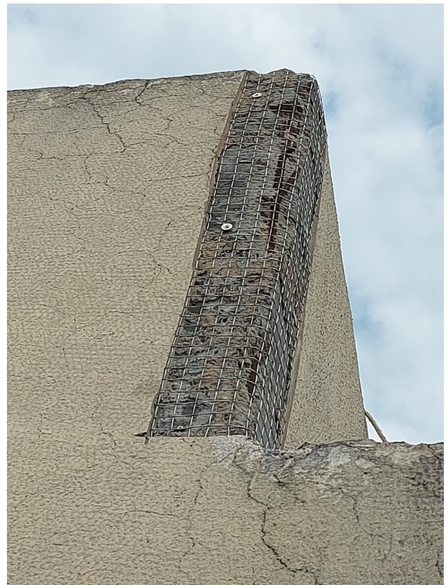
Figura 21C: Remoção do reboco deteriorado e aplicação de tela metálica em região de recuperação do revestimento externo
