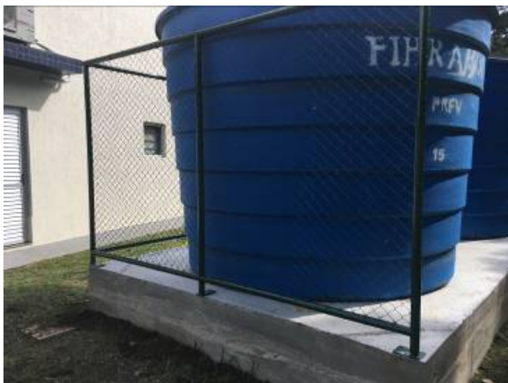
Figura 06 – reservatório de fibra de vidro (15.000 litros)
