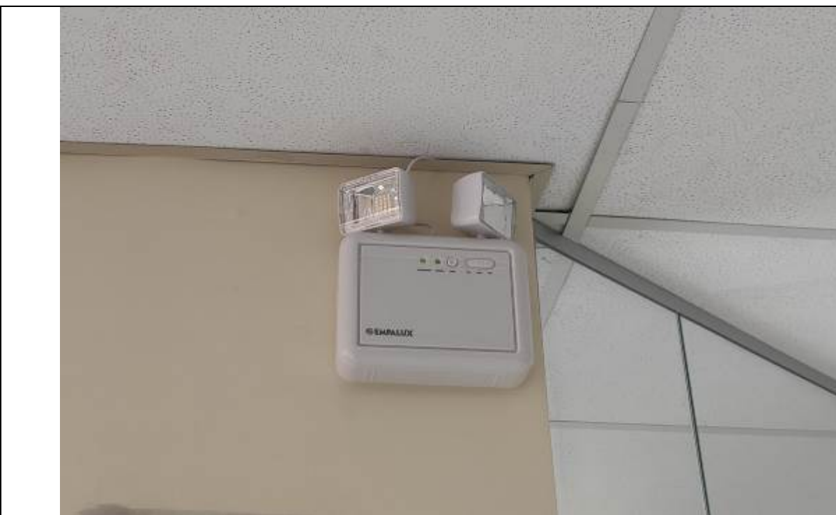
Figura E10: Bloco autônomo de iluminação de emergência, bivolt, com dois faróis LED.
