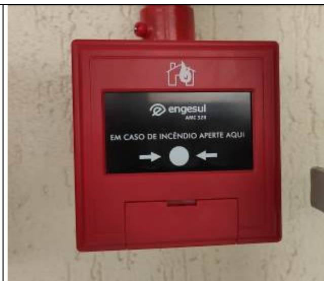
Figura E16: Acionador do alarme de incêndio
