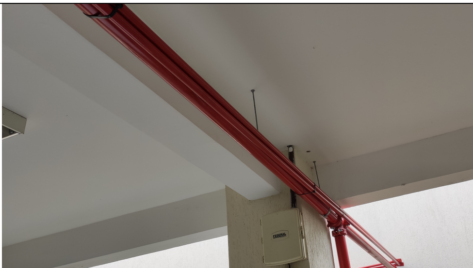
Figura E12: Eletroduto de aço galvanizado eletrolítico DN 25 mm (1") na cor vermelha
