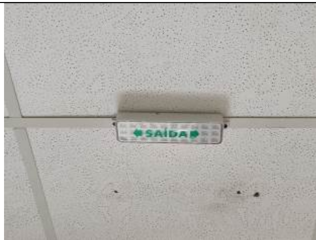
Figura E09: Bloco autônomo de iluminação de emergência
