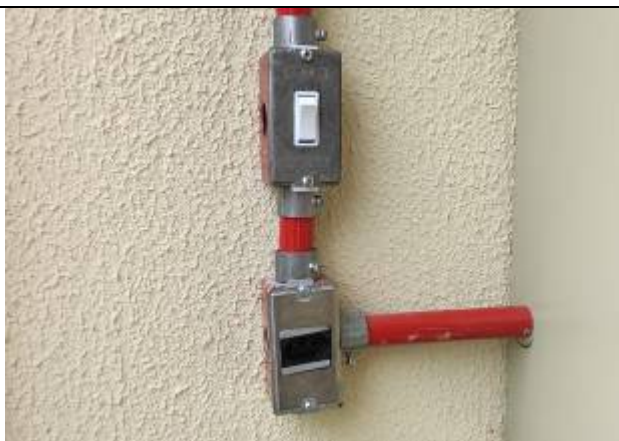
Figura E07: Conjunto interruptor simples e tomada
