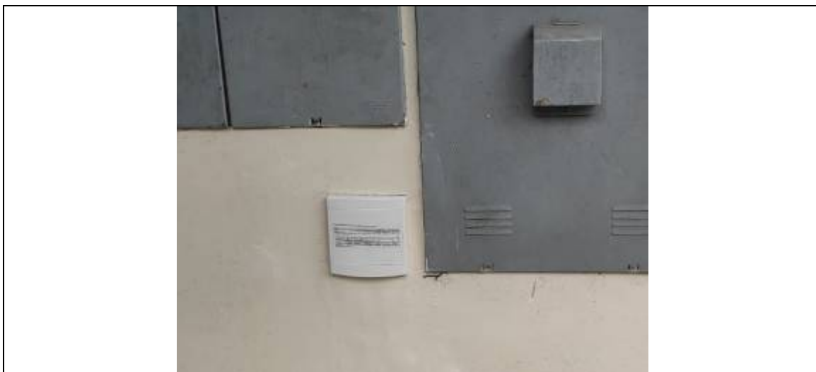
Figura E01: Caixa com disjuntor - ligação do ramal alimentador da bomba de incêndio.
