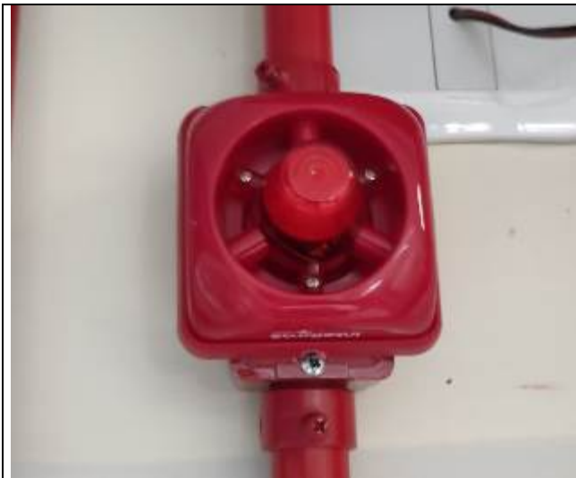
Figura E17: Sirene audiovisual do sistema de alarme de incêndio
