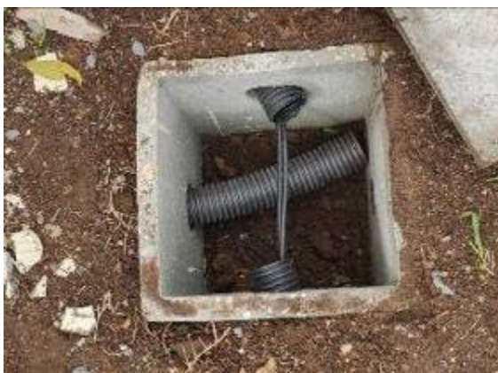
Figura E02: Dutos corrugados em PEAD
