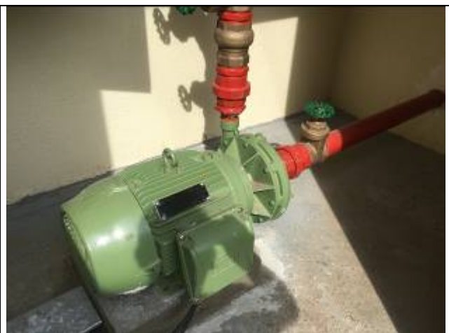
Figura 04: Moto bomba instalada.
