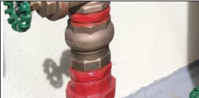
Figura 06: válvula de retenção instalada.
