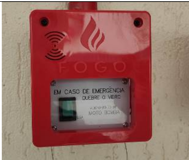
Figura E18: Acionador manual da bomba de combate a incêndio
