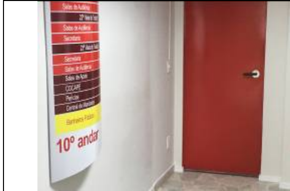
Figura 4: Porta corta-fogo – 10º andar.
