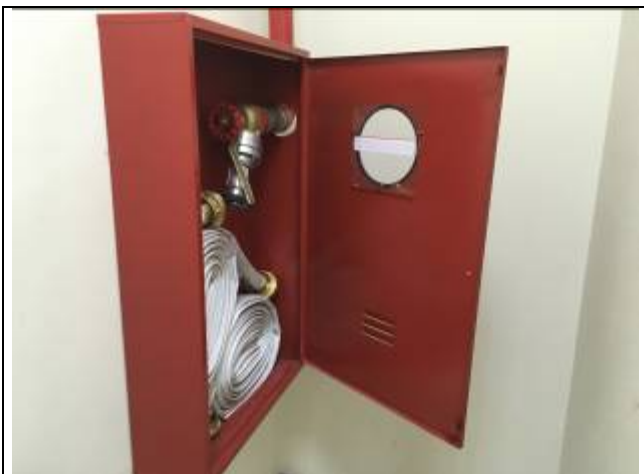
Figura 010: Hidrante HF 17 instalado.
