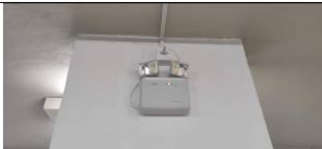
Figura 9: Luminária de emergência – com dois faróis led.
