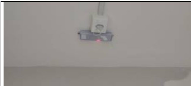
Figura 8: Luminária de emergência – sobrepor laje.
