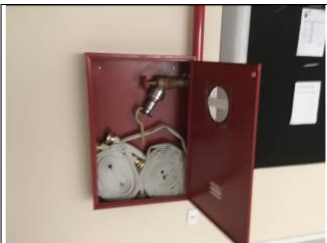
Figura 03: Hidrante H12 instalado.
