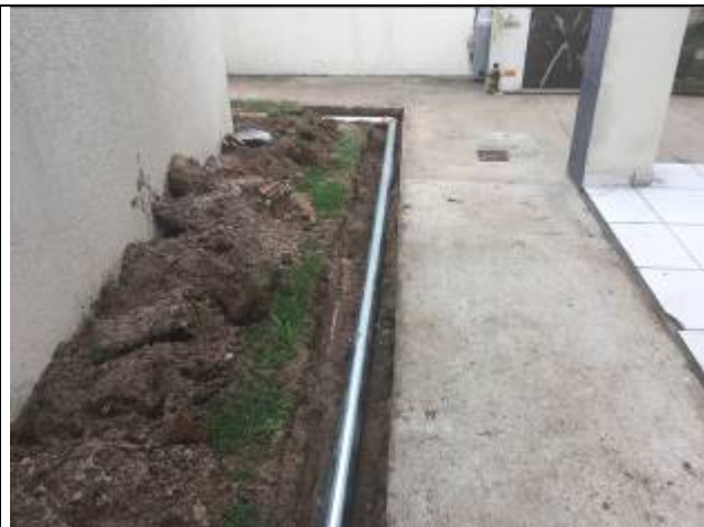
Figura 09: Tubulação aço galvanizado DN 65 mm / 100 mm.
