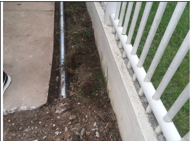
Figura 10: Tubulação aço galvanizado DN 65 mm / 100 mm.
