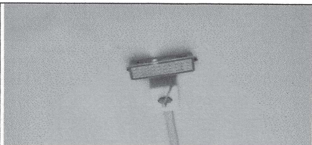
Figura 24: Luminária de emergência – sobrepor laje.
