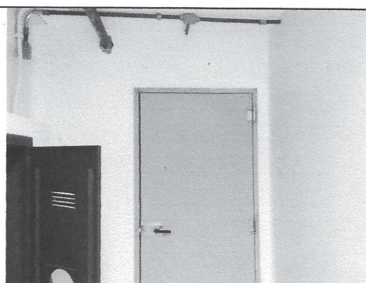
Figura 26: : Porta corta-fogo – TRT 400 – acesso à 14ª VT.
