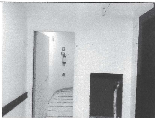
Figura 10: Caixa de hidrante – 1º andar
