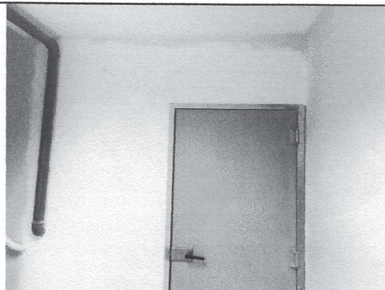
Figura 15: Porta corta-fogo – 7º andar.
