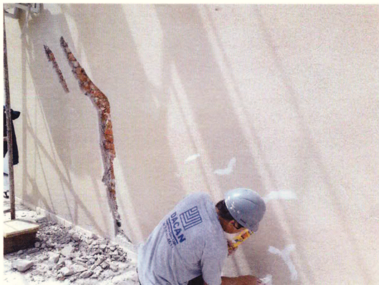
Figura 1 - tratamento de trincas e remoção de revestimento comprometido.
