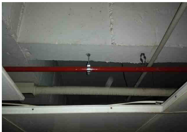
Figura 03: Eletroduto instalado acima do forro
