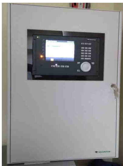
Figura 07: Central de alarme de incêndio
