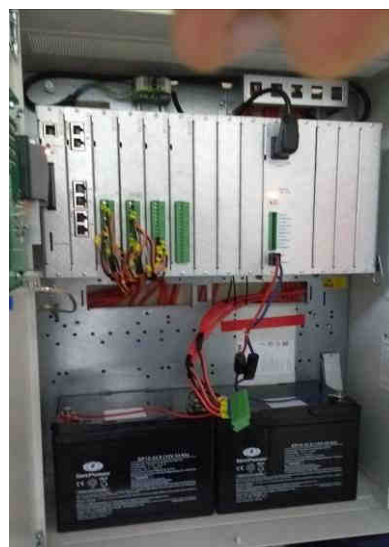
Figura 08: Central de alarme de incêndio
