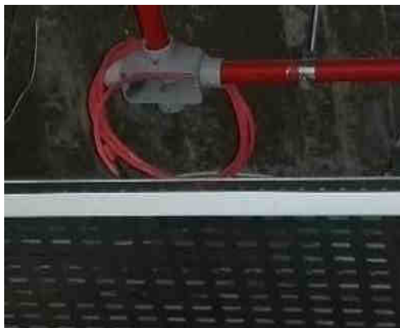
Figura 06: Cabo para sinal e detecção de incêndio
