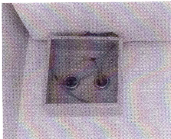
Figura 06: Cabo para sinal e detecção de incêndio
