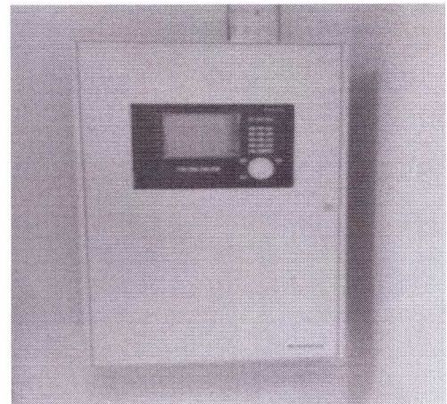
Figura 08: Central de alarme de incêndio
