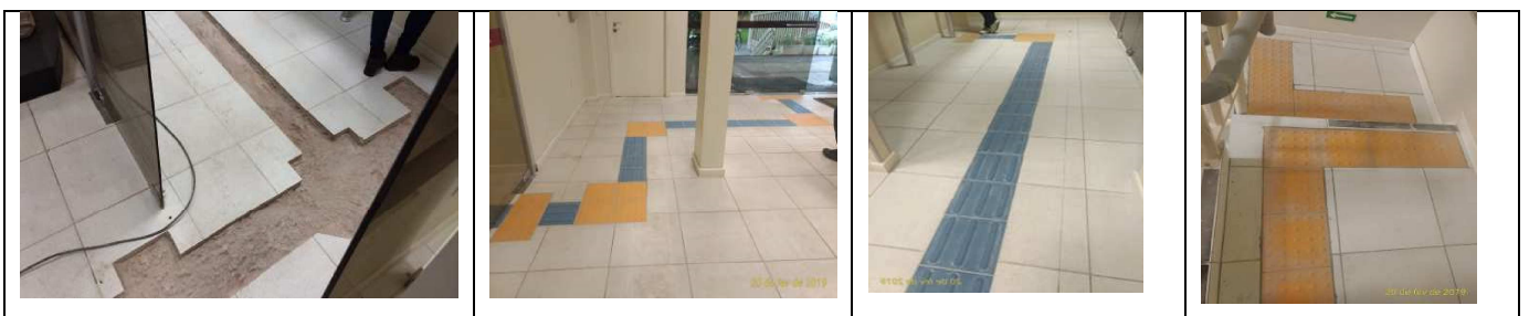
Figura 13: Piso podotátil em porcelanato recepção até atendimento VTs.
