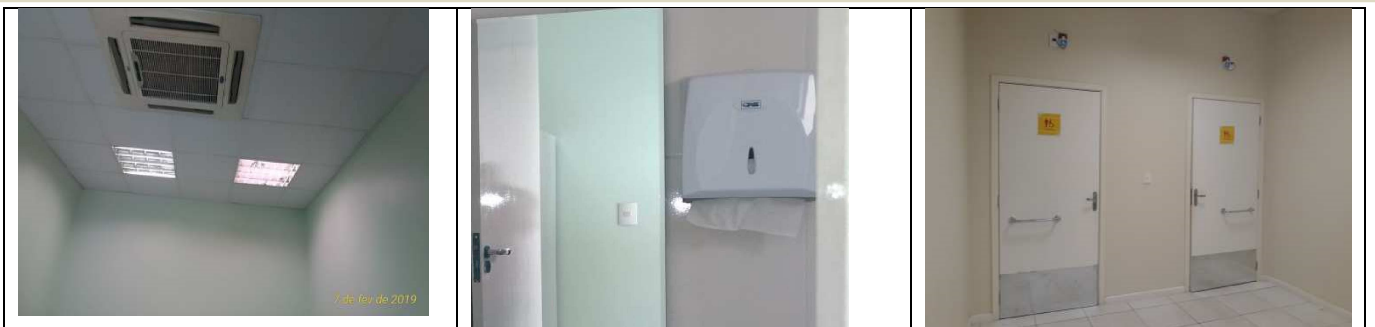
Figura 26 - Ponto de iluminação, interruptores e tomadas do Kit emergência.
