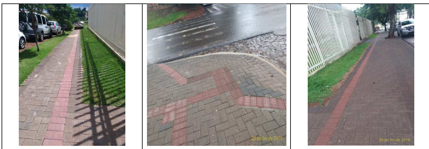
Figura 10 - Execução de piso podotátil direcional e alerta externo. Nas testadas e esquina.
