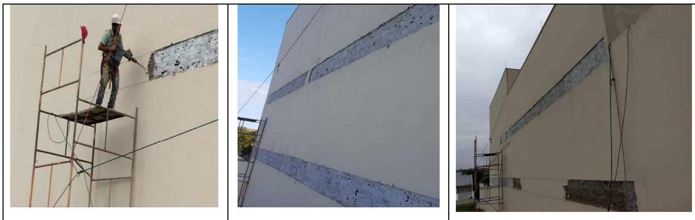
Figura 8 - Rasgo em alvenaria e demolição do revestimento.
