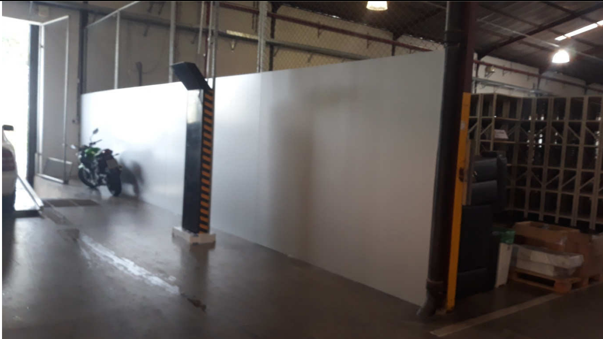
Figura 27: Painel em ACM
