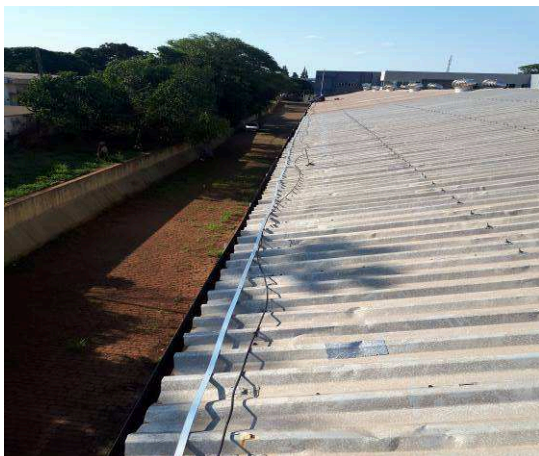
Figura 13: novo SPDA Barracão
