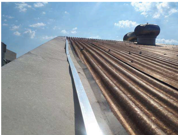
Figura 19: novo SPDA Barracão
