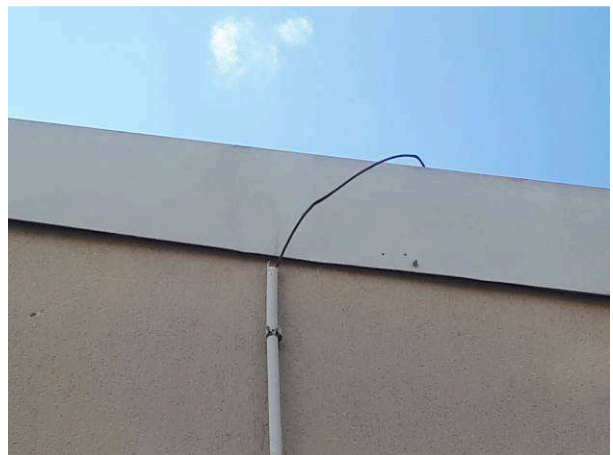
Figura 20: novo SPDA Barracão
