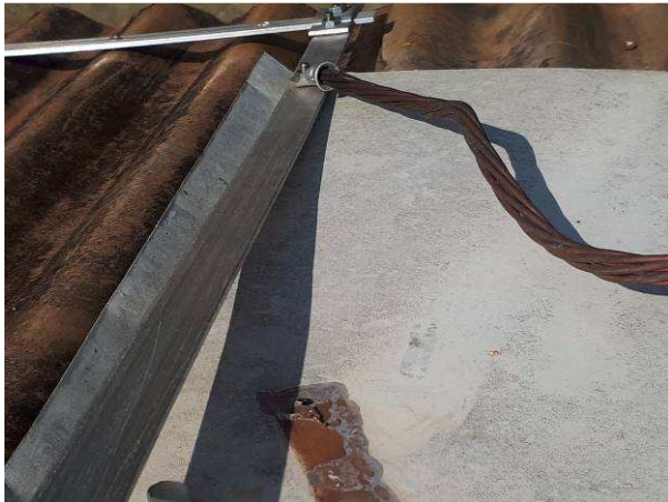
Figura 21: novo SPDA Barracão
