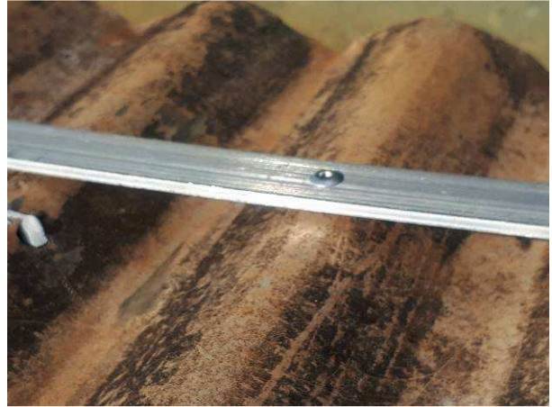
Figura 18: novo SPDA Barracão
