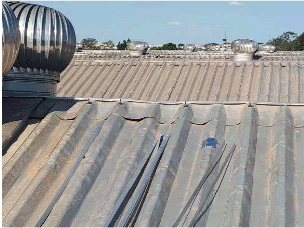
Figura 15: novo SPDA Barracão
