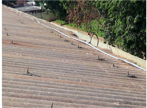
Figura 16: novo SPDA Barracão
