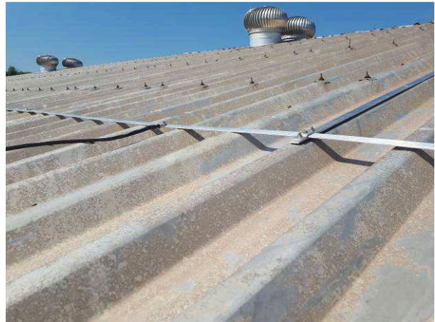
Figura 22: novo SPDA Barracão
