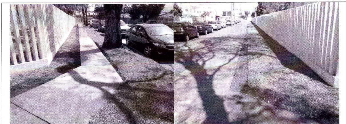
Figura 4 e 5 - Remoção de grama para a instalação do piso podotátil das calçadas externas nas ruas Guairaca e Paricis.
