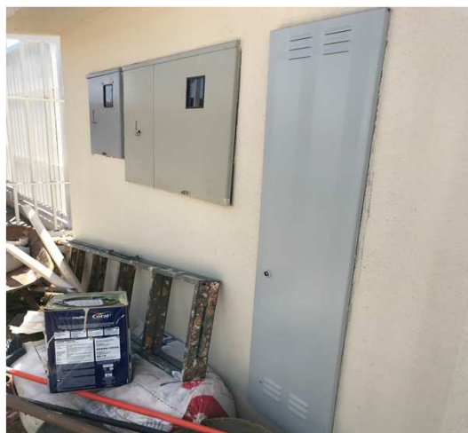
Figura 01E: Entrada de energia
