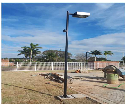
Figura 03E: Caixas para CFTV externas - postes
