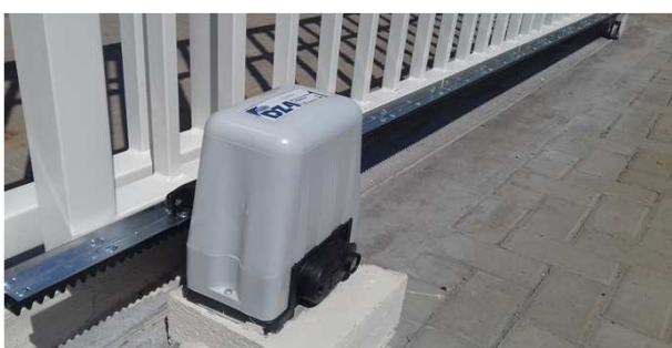
Figura 36C: Motor e sistema de automação do portão de veículos
