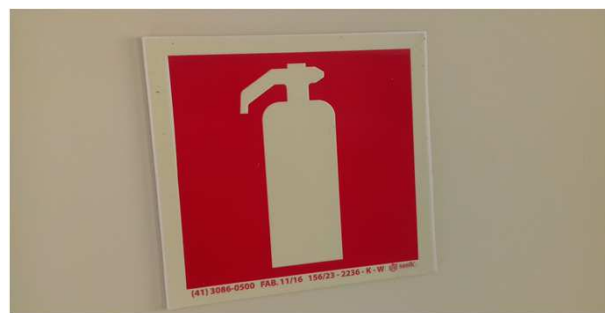
Figura 23C: Placa de sinalização de extintor
