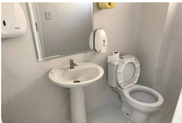
Figura 11C: Sanitário com conjunto instalado - secretaria
