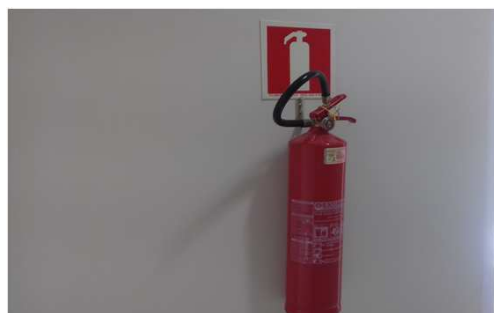
Figura 21C: Extintor ABC instalado no hall público
