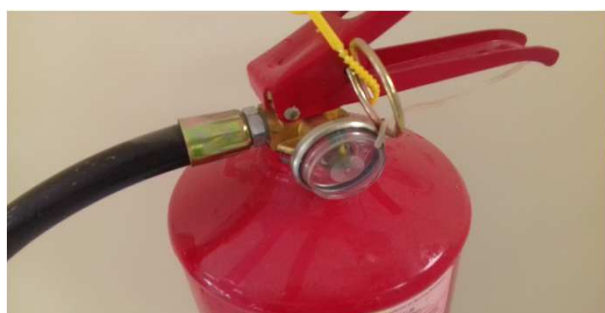
Figura 18C: Detalhe da carga e lacre - extintor da secretaria
