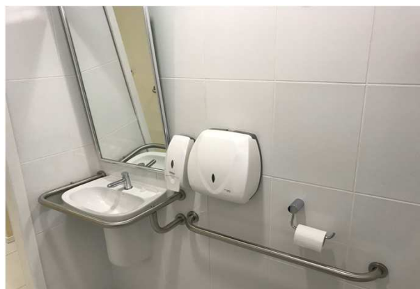
Figura 14C: Sanitário com conjunto instalado - BWC PNE público
