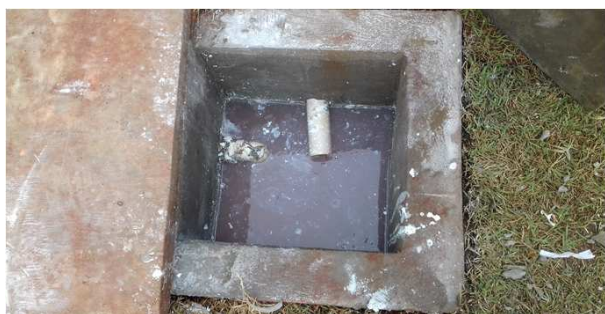
Figura 05C: Caixa de gordura
