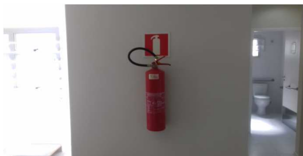
Figura 20C: Extintor ABC instalado na secretaria
