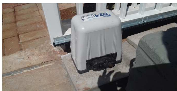
Figura 35C: Motor e sistema de automação do portão de pedestres
