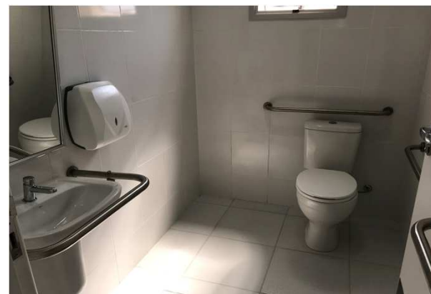
Figura 12C: Sanitário com conjunto instalado - BWC PNE secretaria
