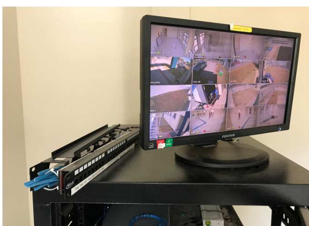
Figura 49C: Sistema de CFTV em funcionamento
