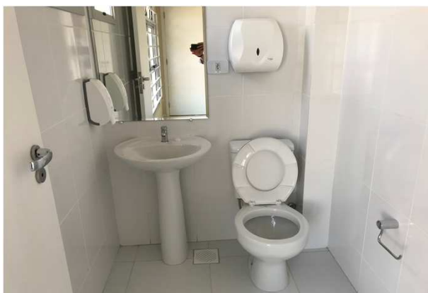
Figura 13C: Sanitário com conjunto instalado - BWC público
