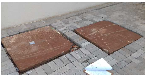
Figura 06C: tampa de caixas de esgoto
