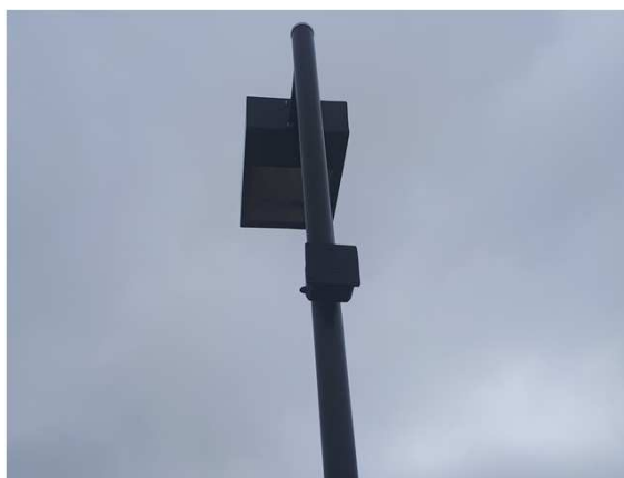
Figura 04E: Caixas para CFTV externas - postes
