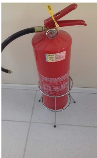
Figura 16C: Detalhe de extintor do arquivo
