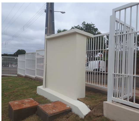
Figura 02E: Entrada de energia
