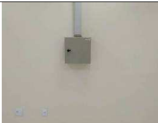
Figura 04E: Quadro QD-OAB
