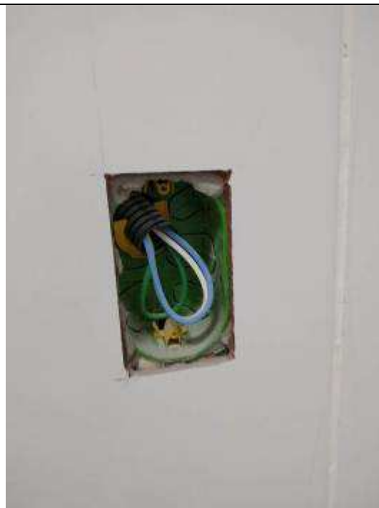
Figura 02E: Caixa de ligação, duto e cabeamento elétrico - copa atendimento
