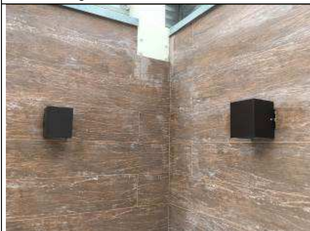
Figura 15C: luminárias tipo arandela.
