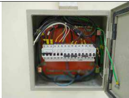
Figura 05E: Quadro QD-OAB
