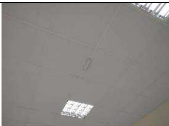
Figura 18E - Iluminação e bloco de emergência
