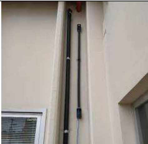
Figura 14E - Infraestrutura externa
