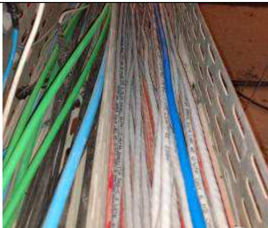
Figura 11E - Cabeamento elétrico e lógico
