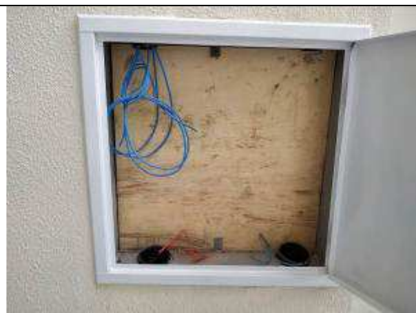
Figura 21E - Distribuidor geral de telecomunicações
