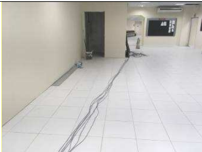
Figura 10C - piso instalado - hall público - COCAPE
