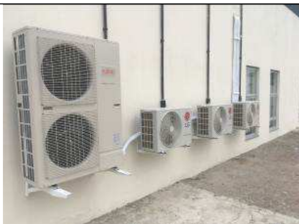
Figura 01C - Unidades SPLIT instaladas
