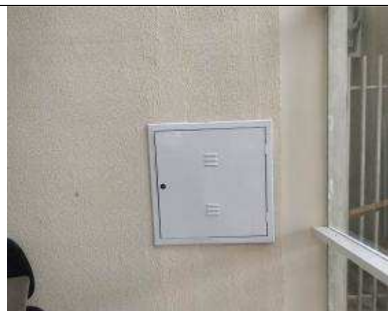
Figura 20E - Distribuidor geral de telecomunicações
