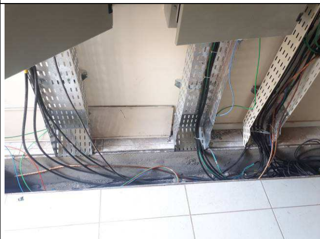
Figura 12E: cabearno elétrico - alimentadores sala técnica
