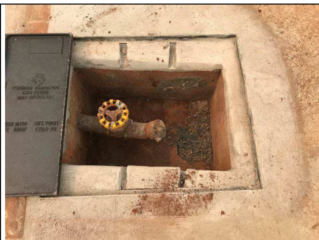
Figura 54C: Hidrante de recalque.
