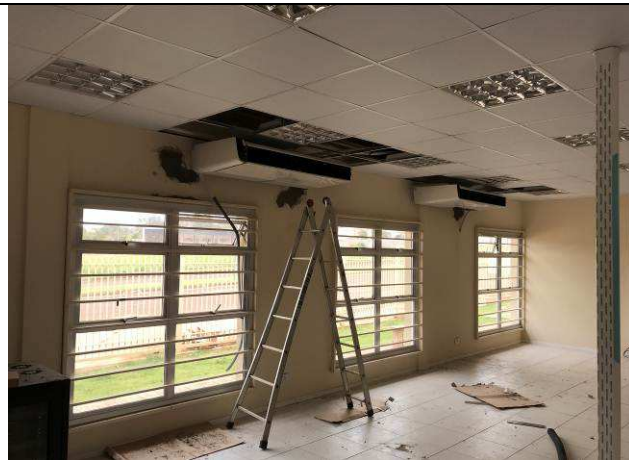
Figura 43C: Evaporadoras 47.000 BTUs - Distribuição / Sala dos Oficiais.
