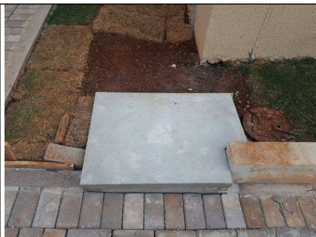
Figura 04E: infraestrutura externa - caixa de passagem
