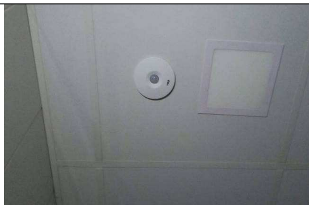
Figura 22E: iluminação interna - sensores de presença
