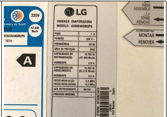
Figura 44C: Evaporadoras 47.000 BTUs - Distribuição / Sala dos Oficiais.
