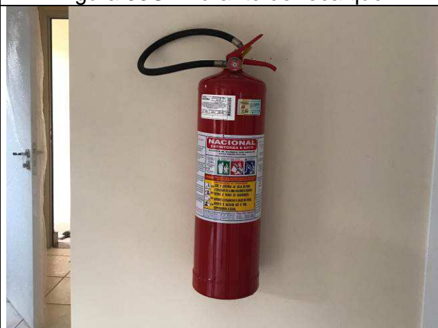
Figura 55C: Extintor de água - 1ª Vara.
