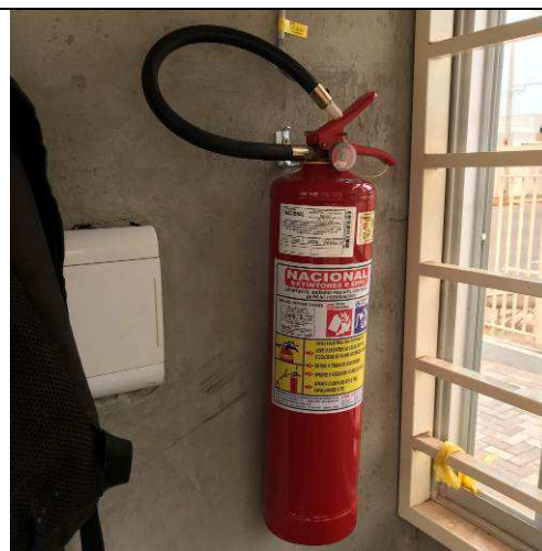
Figura 60C: Extintor de pó - guarita.
