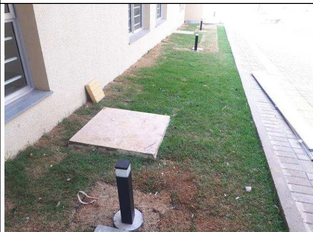
Figura 25E: iluminação externa - postes balizadores
