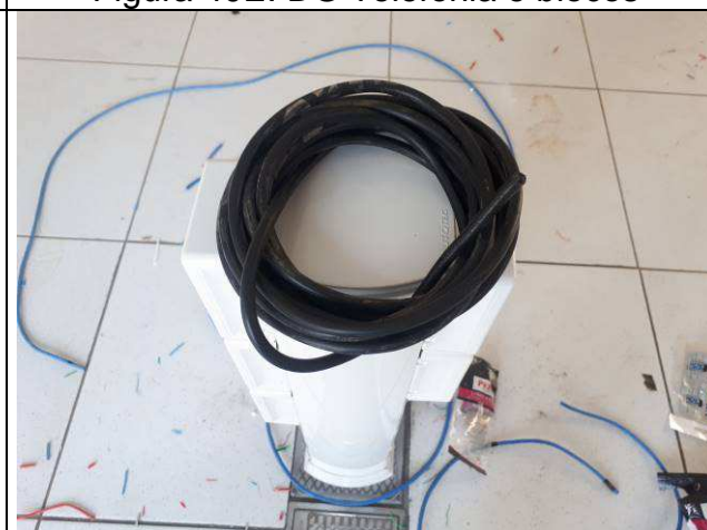
Figura 42E: cabeamento sonorização
