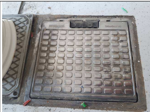
Figura 37E: caixas de piso Dutotec - salas de audiências
