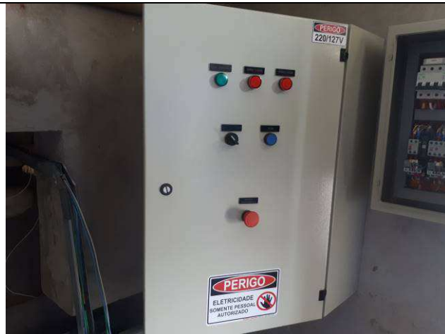
Figura 27E: quadro elétrico QD-INC
