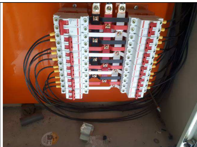
Figura 10E: cabearno elétrico - ar-condicionado
