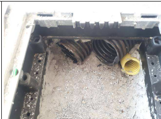
Figura 38E: caixas de piso Dutotec - salas de audiências
