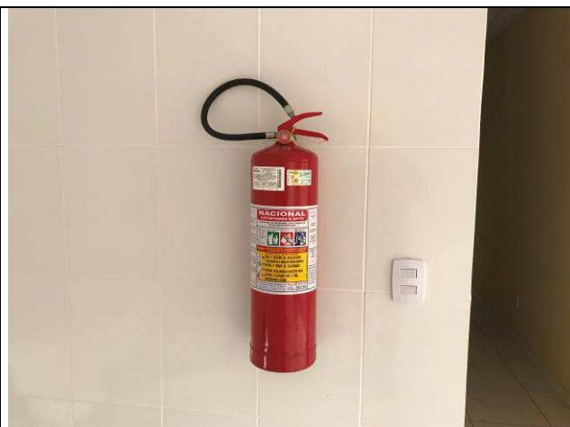
Figura 59C: Extintor de água - copa terceirizados.
