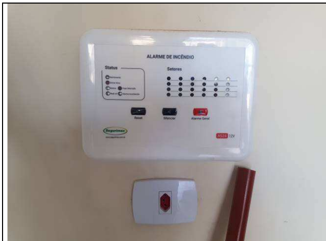
Figura 53E: Central de alarme de incêndios
