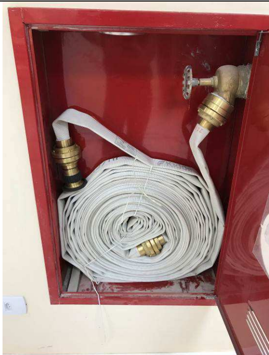
Figura 49C: Abrigo de incêndio - 1ª Vara.
