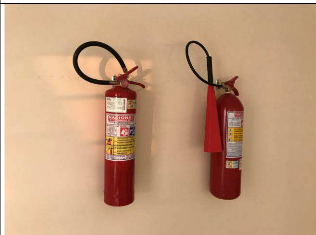
Figura 61C: Extintor de pó e CO 2 - arquivo.
