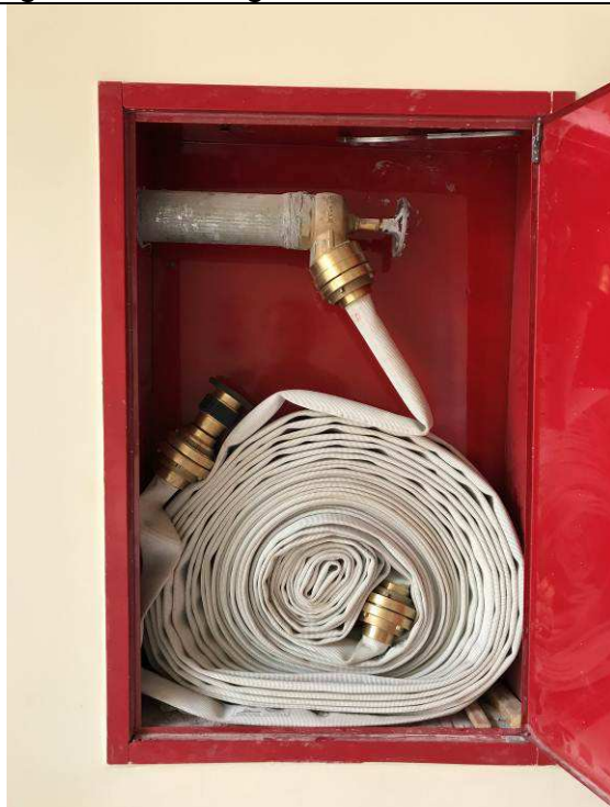
Figura 51C: Abrigo de incêndio - Hall público.
