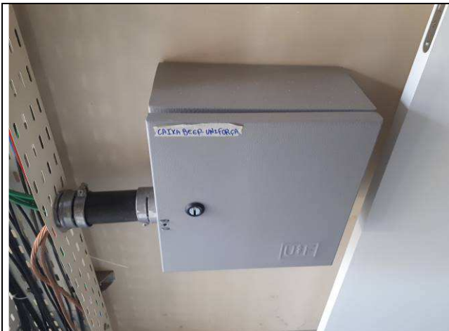
Figura 33E: Quadro de Equipotencialização BEP
