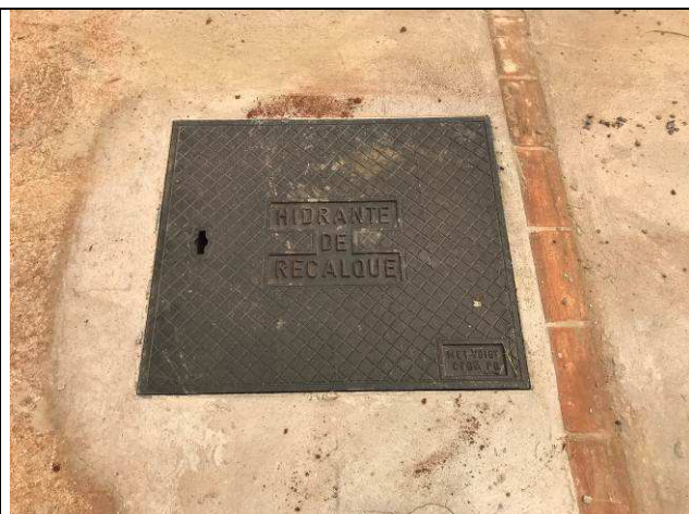
Figura 53C: Hidrante de recalque.
