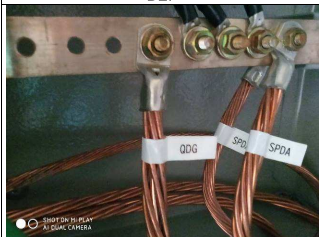
Figura 35E: Aterramentos equipotencializados
