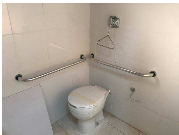
Figura 21C: Barras de apoio - banheiro da área de terceirizados.
