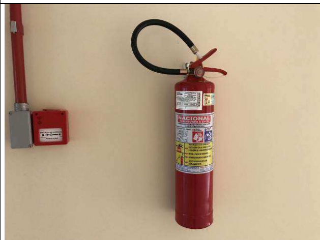
Figura 62C: Extintor de pó - hall do arquivo.
