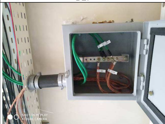
Figura 36E: Aterramentos equipotencializados
