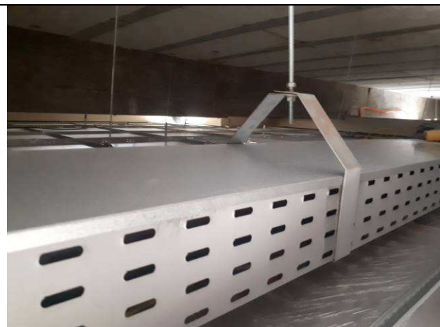
Figura 05E: infraestrutura interna - eletrocalhas tampadas
