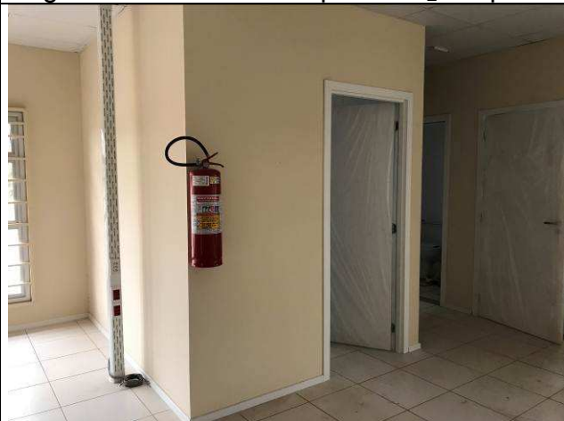
Figura 63C: Extintor de água - distribuição.
