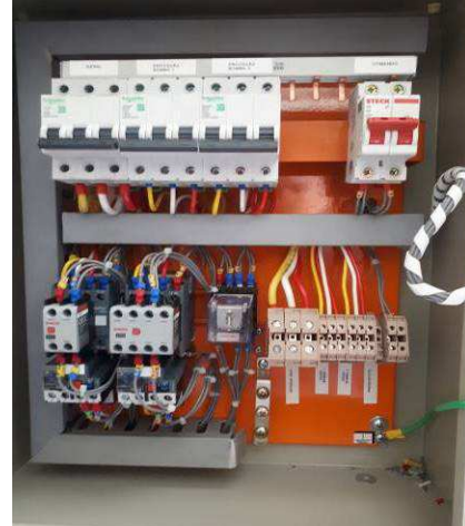
Figura 30E: quadro elétrico QD-Bombas
