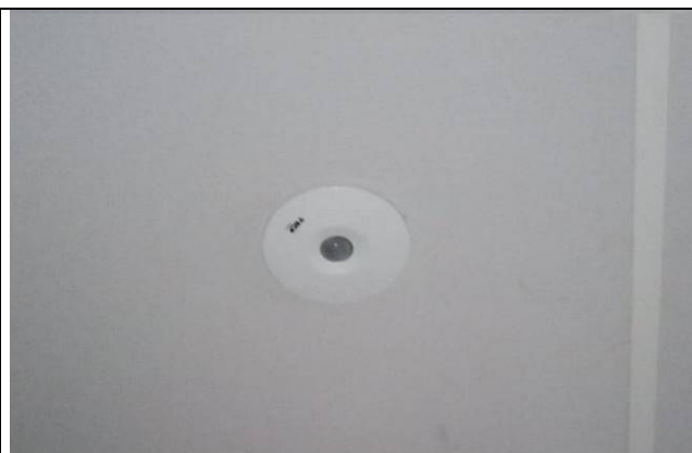
Figura 21E: iluminação interna - sensores de presença
