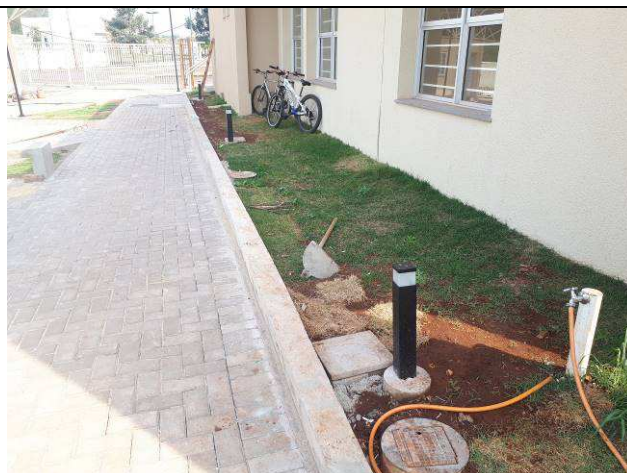
Figura 26E: iluminação externa - postes balizadores
