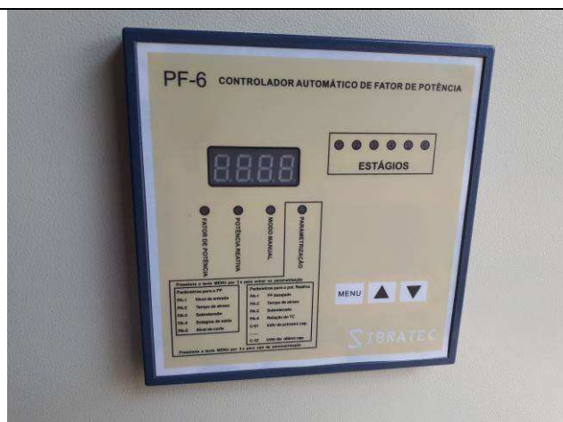
Figura 31E: quadro elétrico Banco de Capacitores
