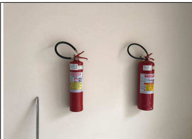
Figura 65C: Extintor de água e pó - hall público.
