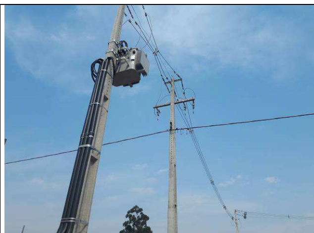
Figura 02E: entrada de serviço de energia elétrica
