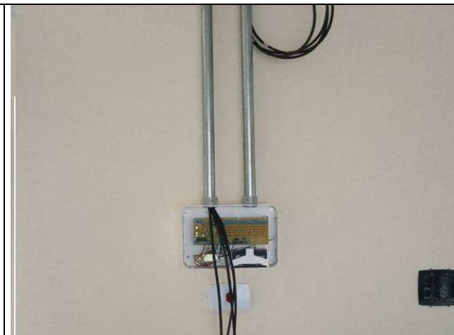
Figura 54E: Central de alarme de incêndios
