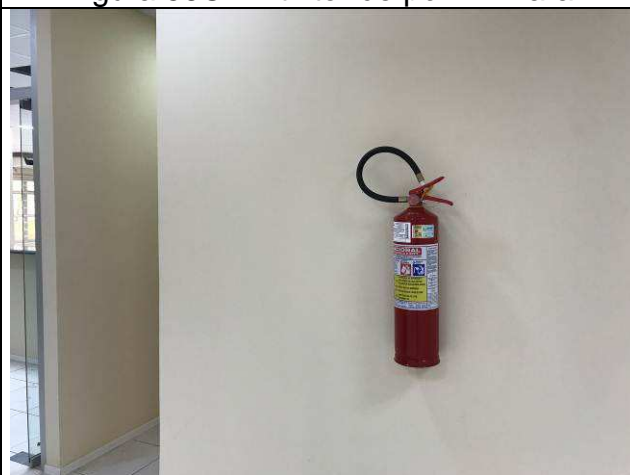
Figura 58C: Extintor de pó - 2ª Vara.
