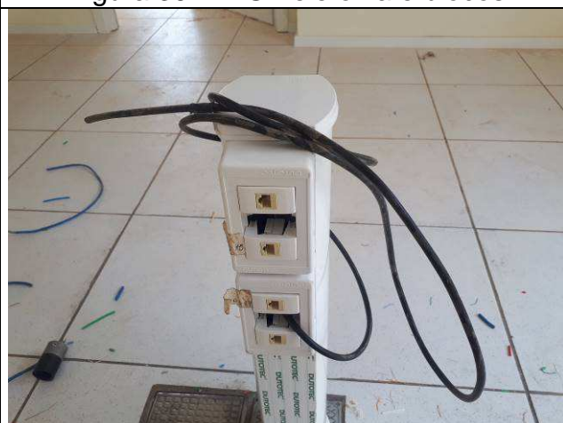
Figura 41E: cabeamento sonorização
