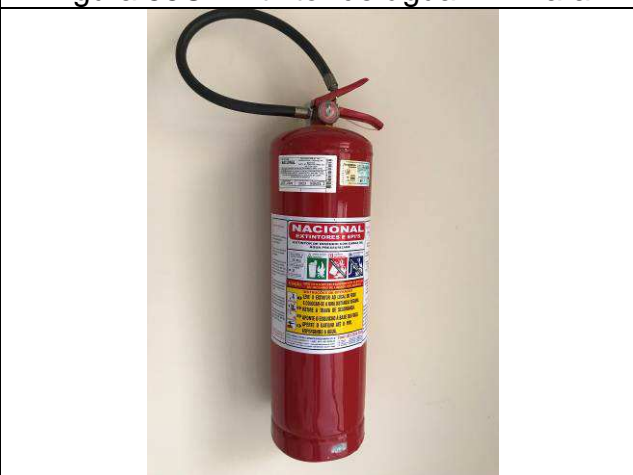
Figura 57C: Extintor de água - 2ª Vara.
