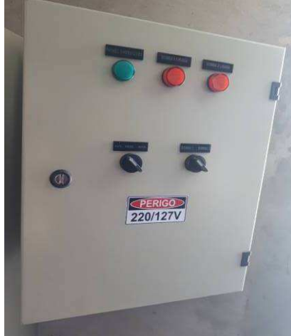
Figura 29E: quadro elétrico QD-Bombas
