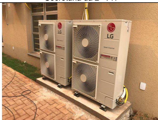
Figura 47C: Condensadoras 47.000 BTUs - Distribuição / Sala dos Oficiais.
