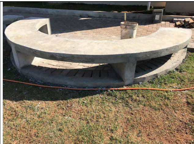
Figura 96C: Bancos de concreto.
