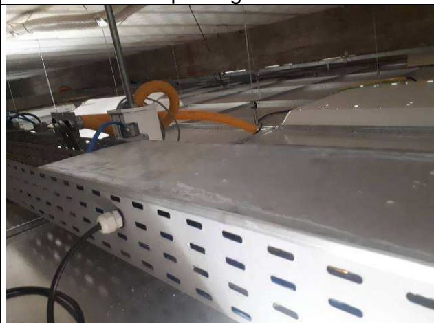
Figura 06E: infraestrutura interna - eletrocalhas tampadas
