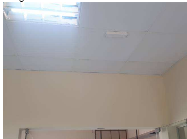
Figura 20E: iluminação interna - blocos de emergência
