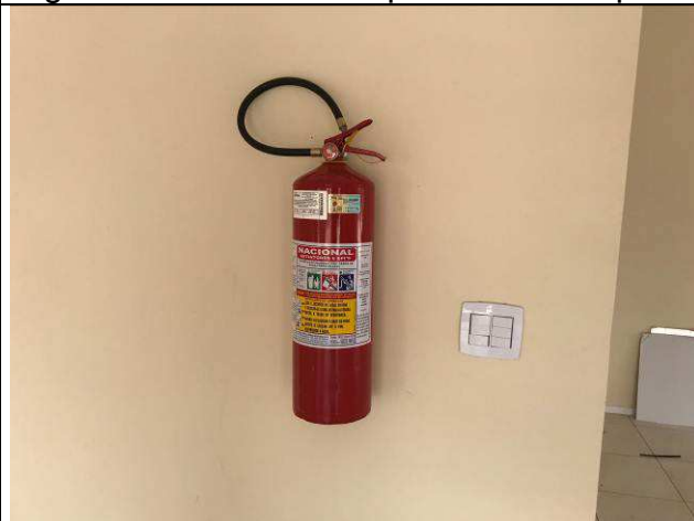
Figura 64C: Extintor de água - distribuição.
