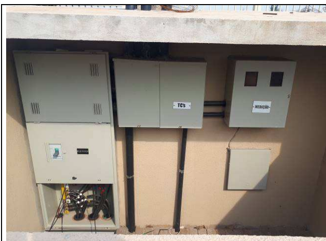
Figura 01E: entrada de serviço de energia elétrica
