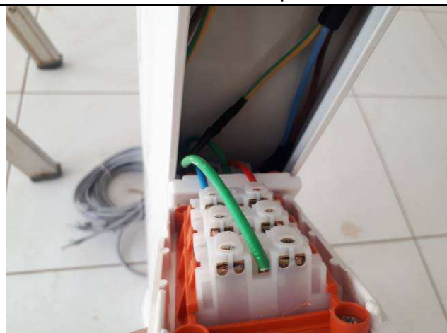
Figura 07E: cabeamento elétrico - colunas técnicas e totens
