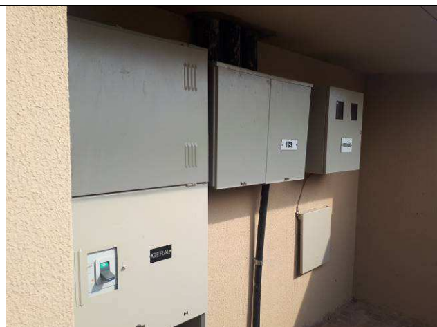
Figura 03E: entrada de serviço de energia elétrica
