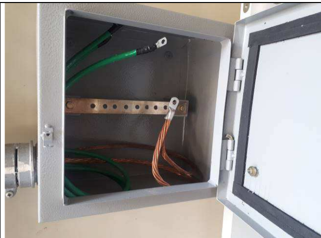
Figura 34E: Quadro de Equipotencialização BEP
