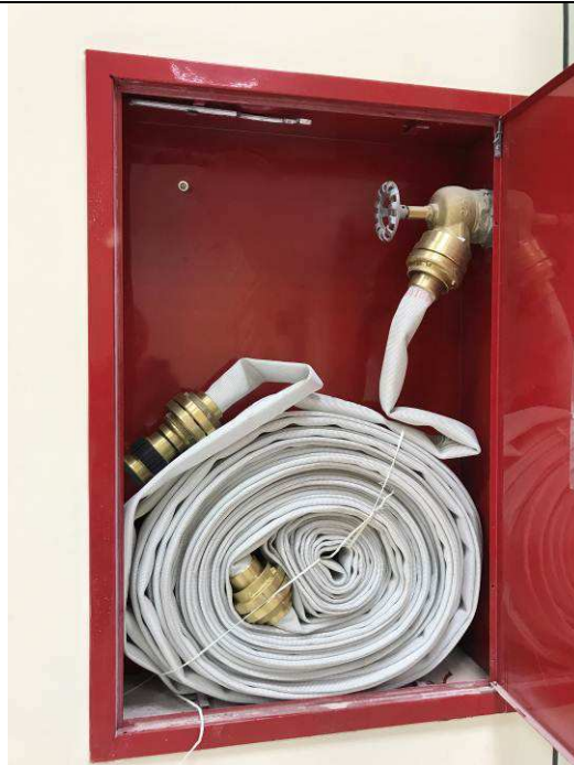
Figura 50C: Abrigo de incêndio - 2ª Vara.
