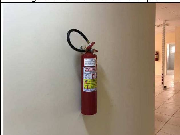
Figura 56C: Extintor de pó - 1ª Vara.
