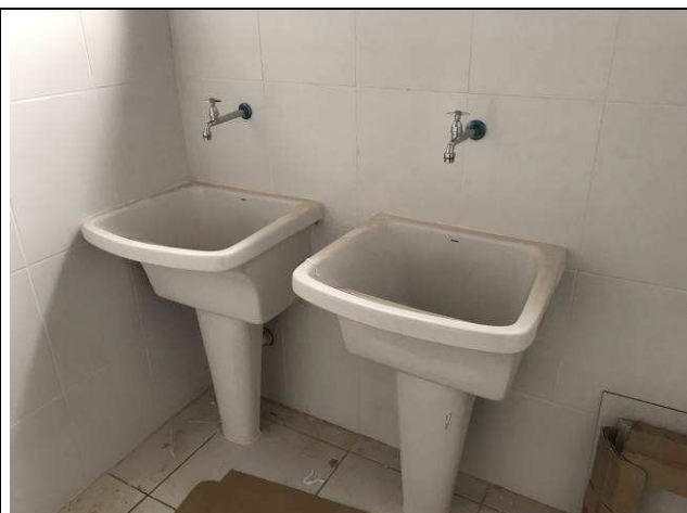
Figura 35C: Torneiras tanques - área de serviço.
