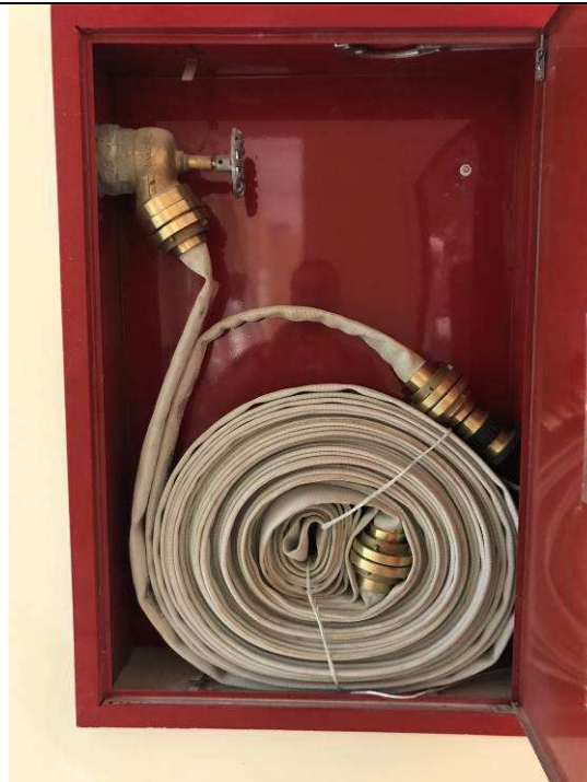
Figura 52C: Abrigo de incêndio - Hall do Arquivo / Auditório.
