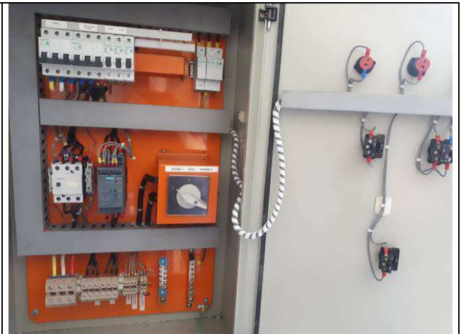
Figura 28E: quadro elétrico QD-INC
