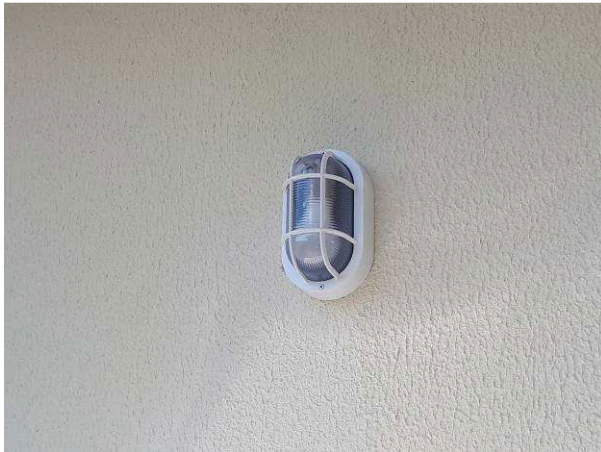
Figura 31E - iluminação - luminárias externas
