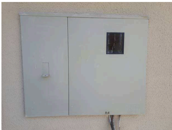
Figura 06E - entrada de energia em BT - módulo GNE
