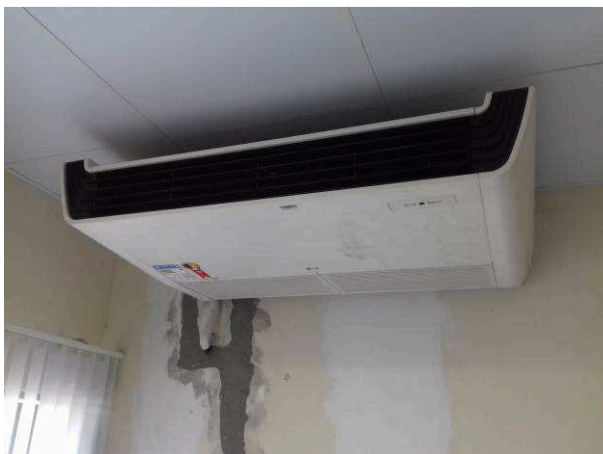
Figura 47C: Aparelho de ar condicionado transferido de local, no hall público
