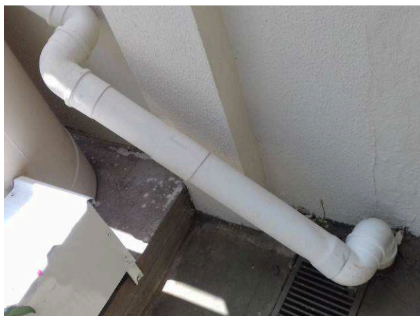
Figura 16C: Tubulação extravasora do reservatório
