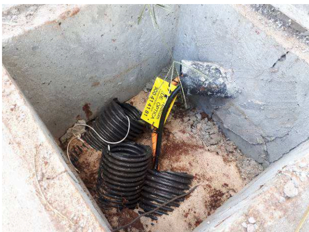
Figura 53E - entrada de telecomunicações
