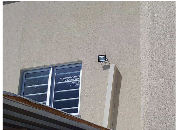
Figura 34E - iluminação - luminárias externas
