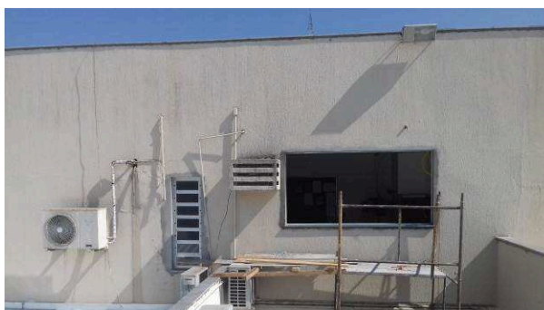
Figura 44C: Local onde havia vão e aparelho janeleiro, ao lado da janela da sala da OAB
