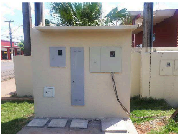
Figura 03E - entrada de energia em BT
