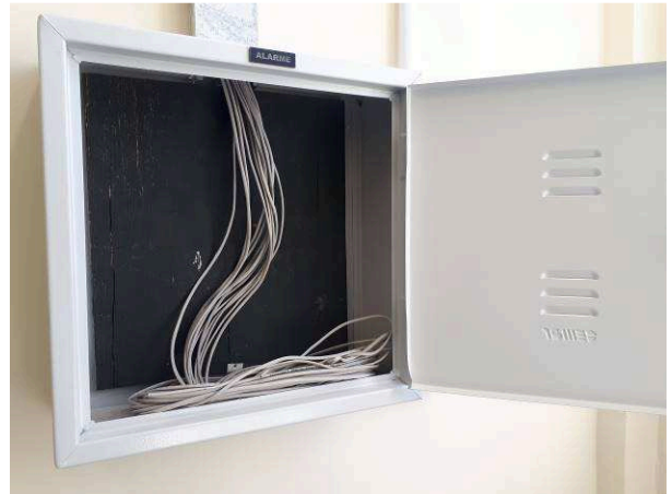
Figura 62E - cabeamento alarme
