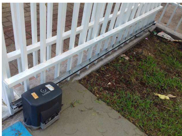
Figura 20C: Motor de automatização do portão de pedestres
