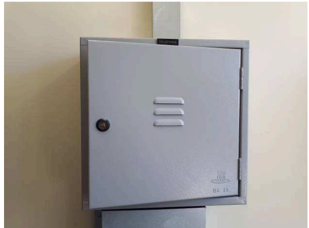
Figura 58E - DG de telefonia
