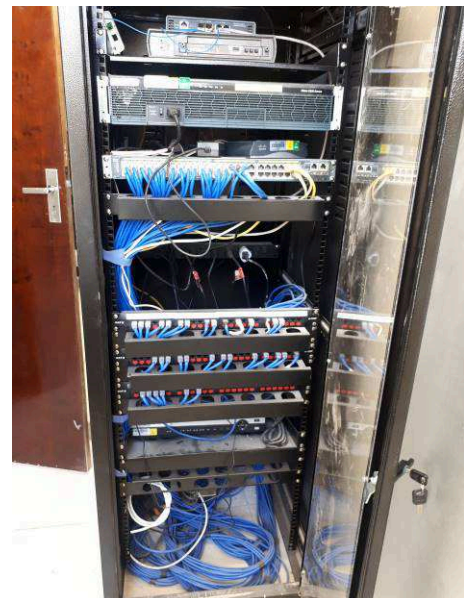
Figura 66E - rack sala técnica
