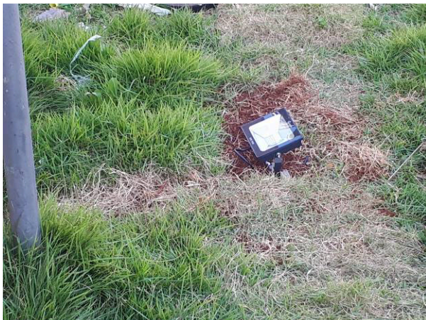
Figura 35E - iluminação - luminárias externas
