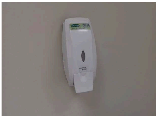
Figura 40C: Dispenser de sabonete líquido, instalado na sala de perícia
