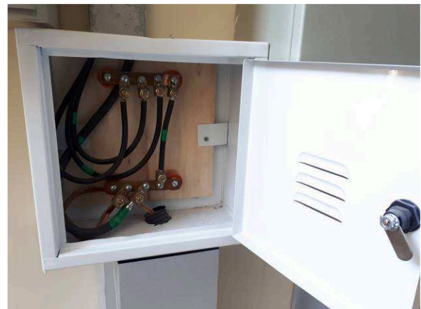
Figura 52E - Barramento de equipotencialização
