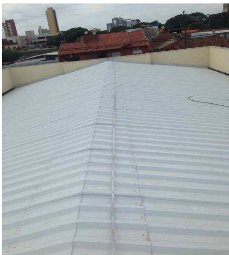
Figura 41E - SPDA captação
