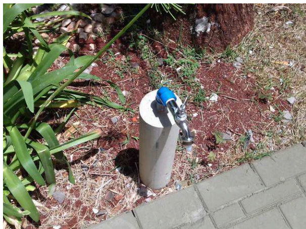
Figura 18C: Torneira de jardim, alimentada pela cisterna de reúso - Próxima ao arquivo
