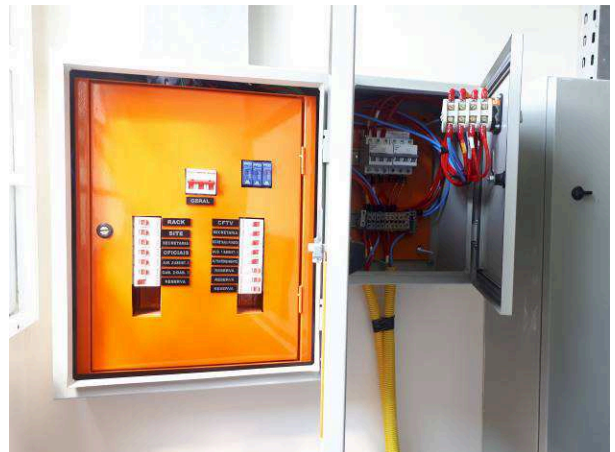
Figura 36E - quadro estabilizado
