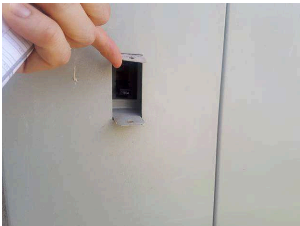
Figura 05E - entrada de energia em BT - módulo GNE
