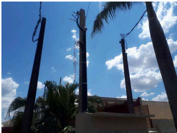
Figura 01E - entrada de energia em BT
