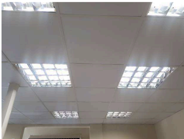
Figura 23E - iluminação - luminárias com aletas
