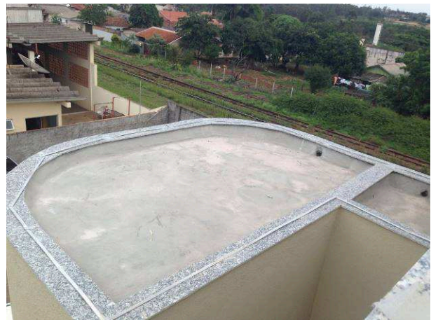
Figura 40E - SPDA captação
