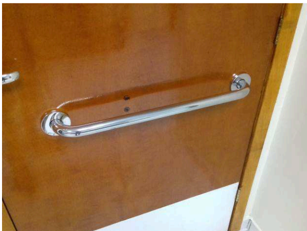
Figura 12C: Barra externa para abertura de porta - BWC PNE do pavimento superior
