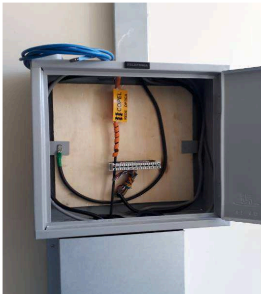
Figura 59E - DG de telefonia
