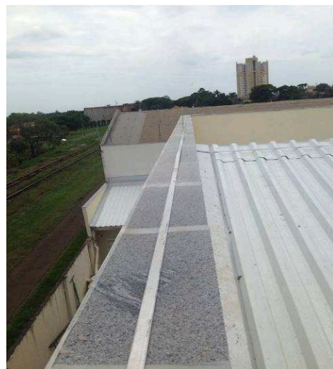
Figura 42E - SPDA captação
