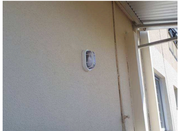
Figura 32E - iluminação - luminárias externas
