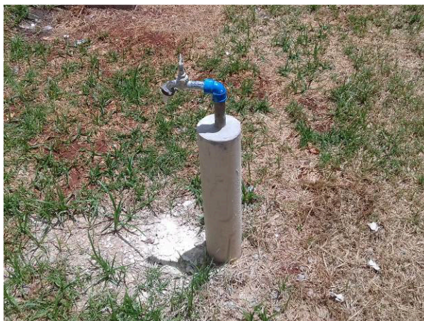
Figura 19C: Torneira de jardim, alimentada pela cisterna de reúso - Próxima ao estacionamento
