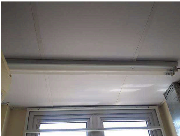
Figura 27E - iluminação - luminárias tipo calha
