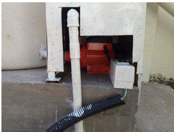
Figura 17C: Motor de pressurização da rede de reúso
