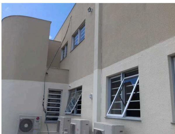
Figura 33C: "Prumada" em shaft, para ocultar rede frigorígena, na lateral esquerda do prédio
