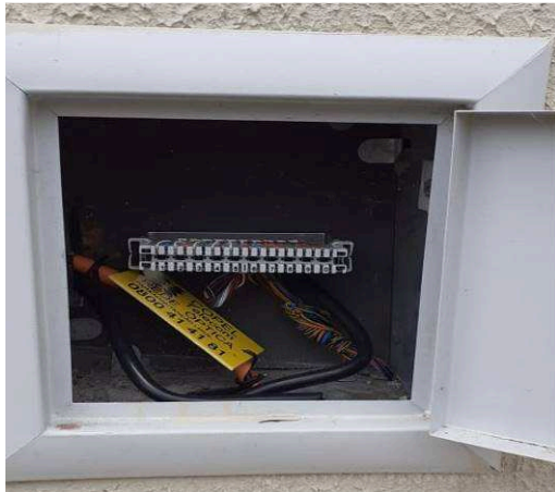
Figura 61E - bloco Bargoa entrada telefonia
