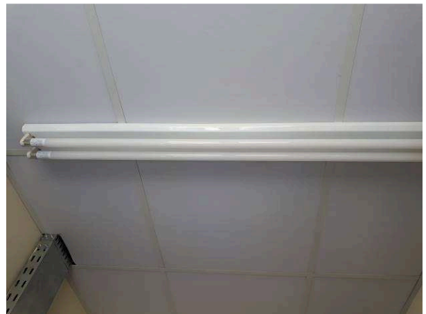
Figura 28E - iluminação - luminárias tipo calha
