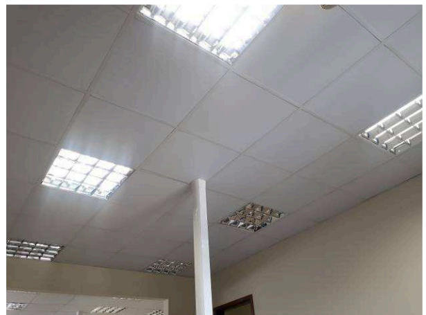
Figura 24E - iluminação - luminárias com aletas
