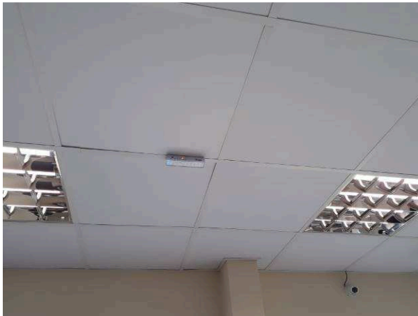
Figura 21E - iluminação - blocos de emergência
