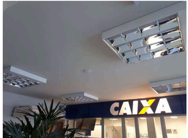
Figura 26E - iluminação - luminárias com aletas
