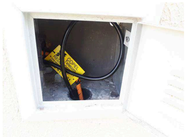
Figura 54E - entrada de telecomunicações
