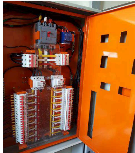
Figura 38E - quadro ar-condicionado
