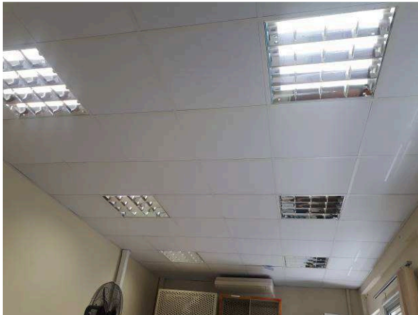
Figura 25E - iluminação - luminárias com aletas
