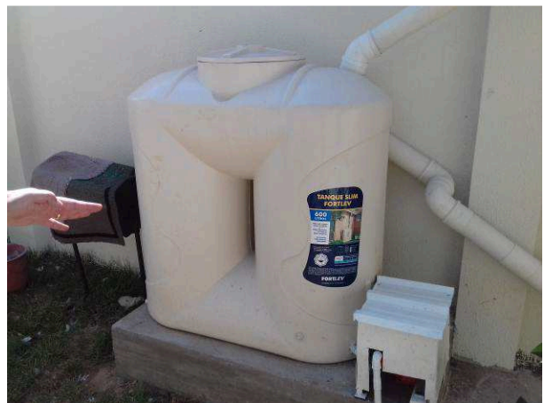
Figura 15C: Reservatório de reúso
