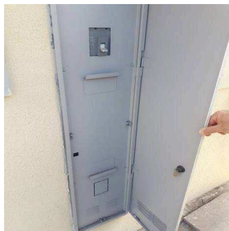
Figura 04E - entrada de energia em BT - módulo barramento
