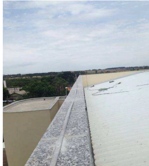
Figura 44E - SPDA captação
