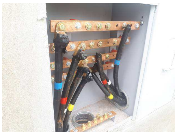
Figura 11E: Entrada de energia - barramento e cabos ramal entrada
