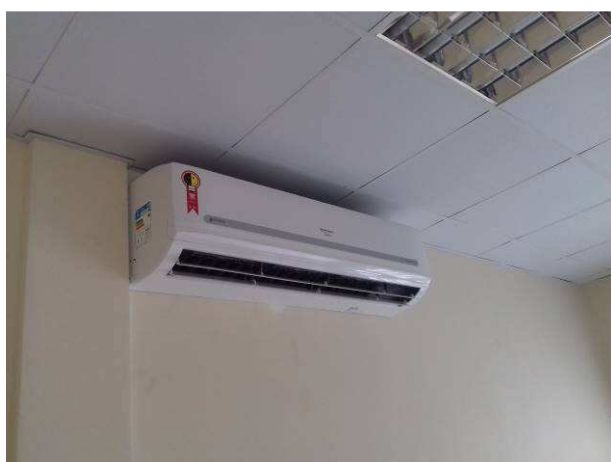
Figura 57C: Evaporadora instalada no PAB
