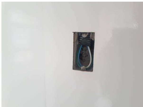
Figura 19E: Infraestrutura interna - caixas 4x2"
