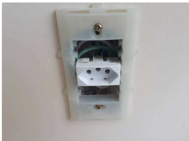
Figura 29E: Interruptores e tomadas elétricas
