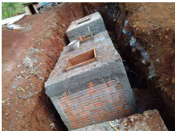
Figura 37C: Poço de visita, filtro anaeróbico e sumidouro (de cima para baixo)
