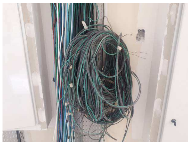
Figura 24E: Cabeamento elétrico - circuitos ar-condicionado
