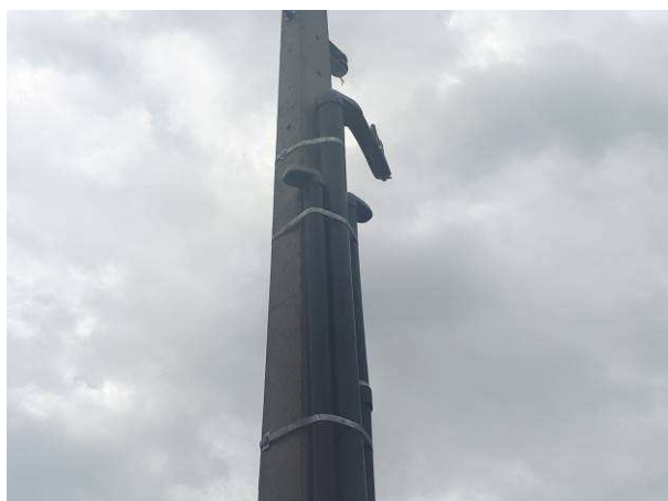
Figura 05E: Entrada de energia - eletrodutos e cabos
