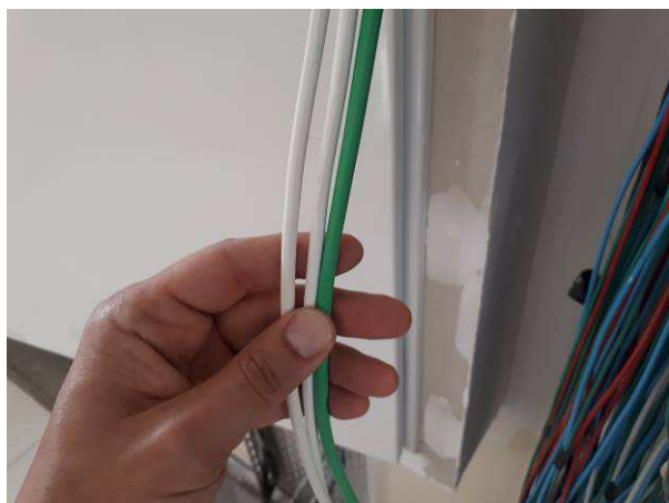
Figura 17E: Cabeamento elétrico - circuitos externos portões e iluminação
