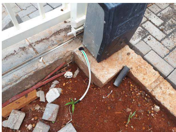
Figura 15E: Cabeamento elétrico - circuitos externos portões e iluminação
