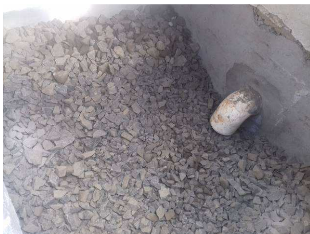
Figura 40C: Captação do filtro para descarga no sumidouro
