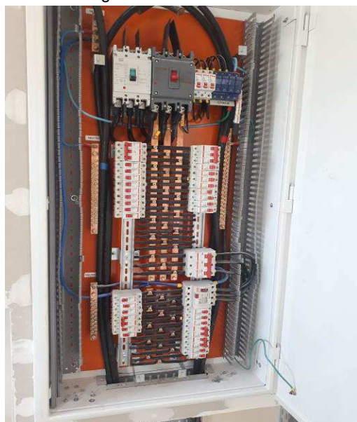
Figura 53E: Quadro QDG
