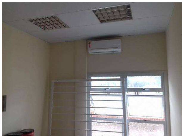
Figura 55C: Evaporadora instalada na sala da OAB
