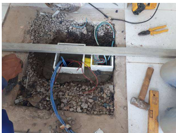
Figura 69E: infraestrutura rede lógica - caixas de piso
