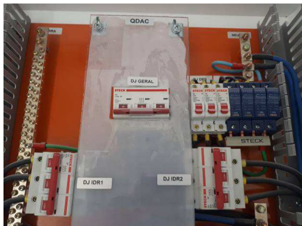
Figura 55E: Quadro QDAC
