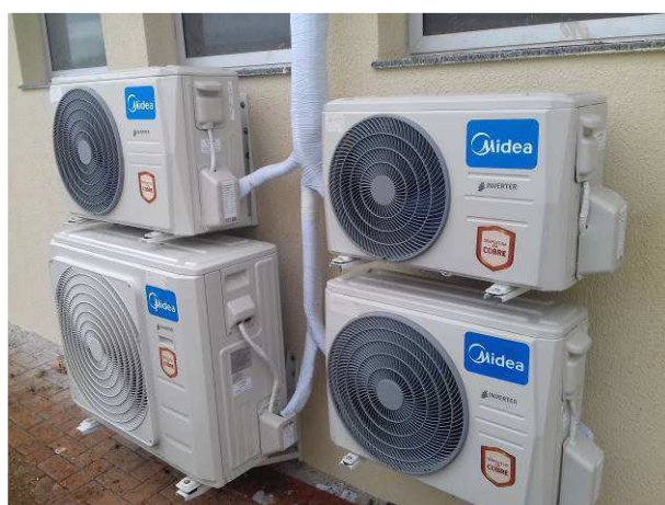
Figura 48C: Condensadoras instaladas na parede da copa
