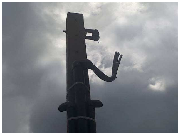
Figura 07E: Entrada de energia - eletrodutos e cabos
