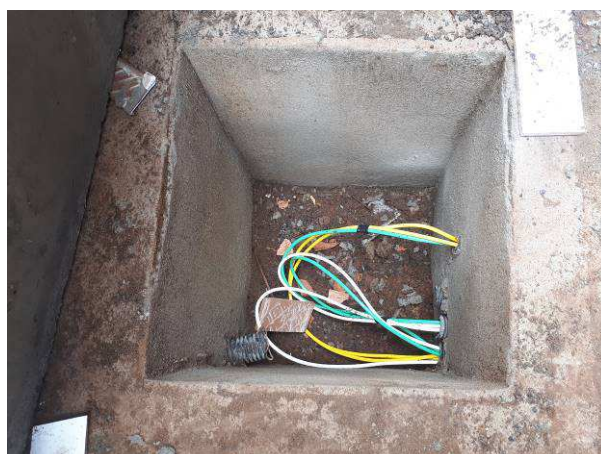
Figura 16E: Cabeamento elétrico - circuitos externos portões e iluminação
