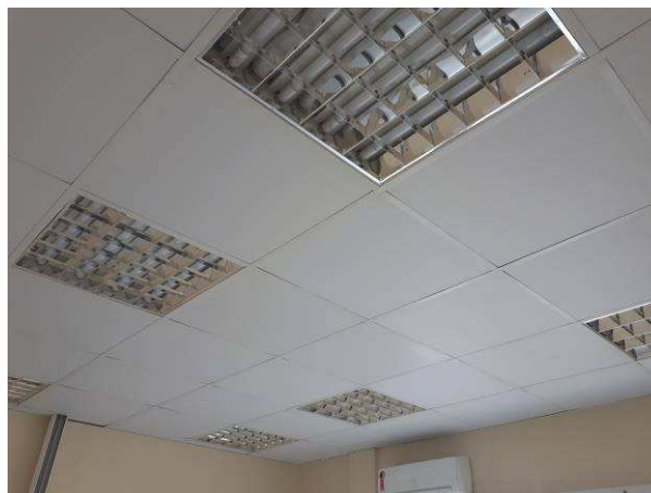
Figura 38E: Iluminação interna - luminárias 4 lâmpadas, com aletas
