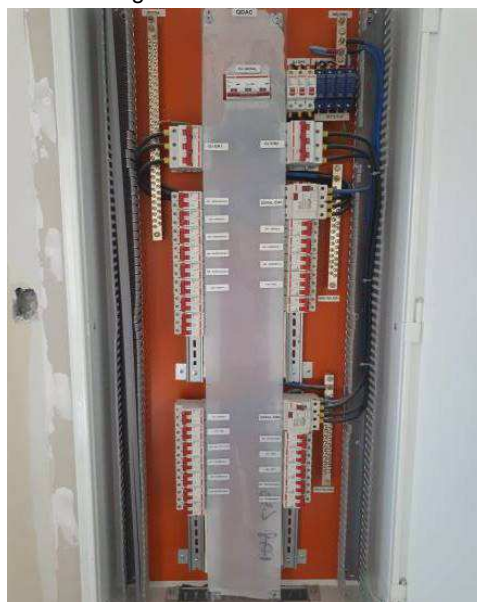
Figura 54E: Quadro QDAR
