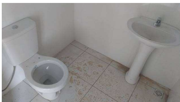
Figura 29C: Bacia sanitária, Lavatório com coluna e torneira com desligamento automático em sanitário do juiz titular
