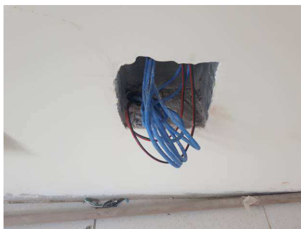
Figura 66E: infraestrutura rede lógica
