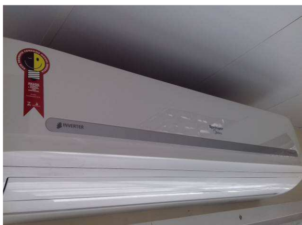
Figura 53C: Evaporadora instalada na sala de audiência 2
