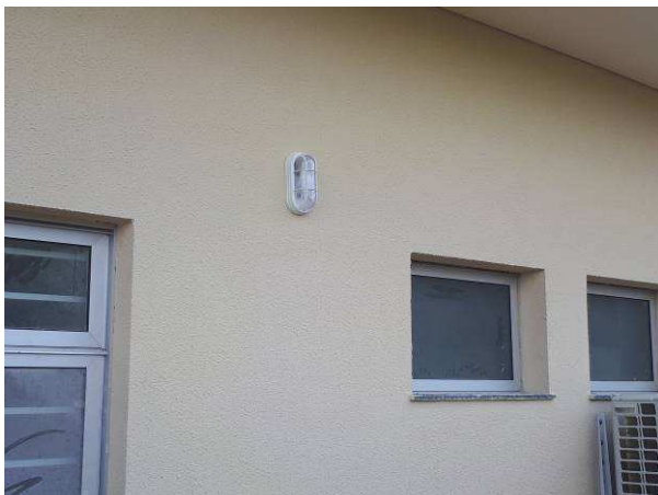
Figura 47E: Iluminação externa - luminárias tartaruga
