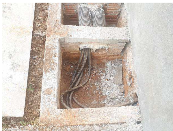
Figura 06E: Entrada de energia - eletrodutos e cabos
