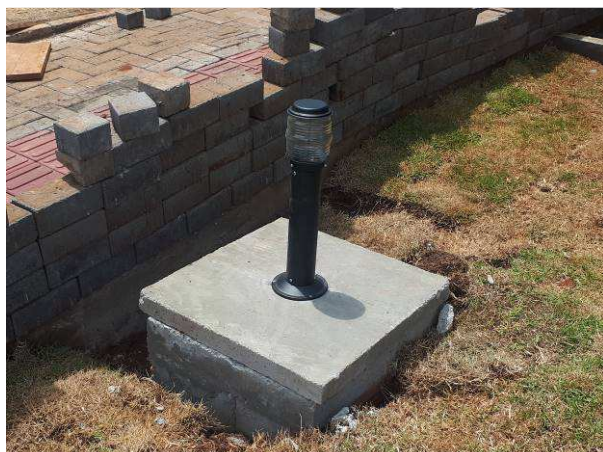
Figura 49E: Iluminação externa - luminárias postes balizadores
