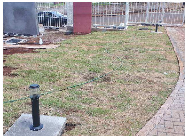
Figura 48E: Iluminação externa - luminárias postes balizadores
