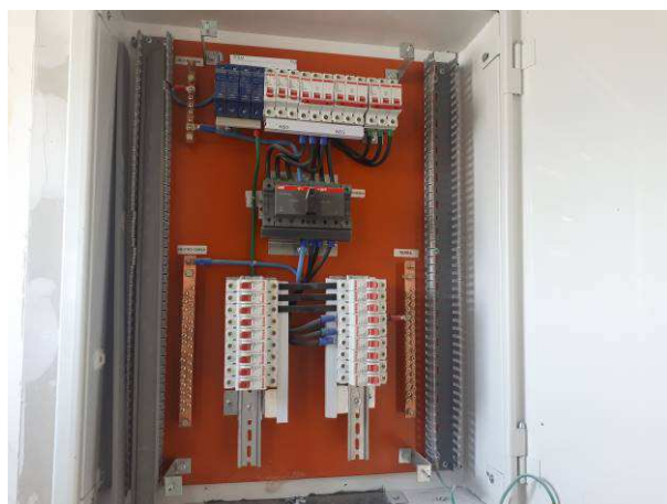
Figura 57E: Quadro QDE
