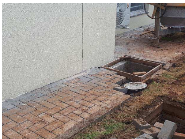
Figura 59E: caixas de inspeção aterramento
