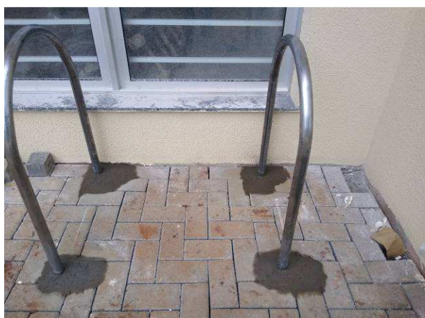
Figura 86C: Paraciclo, instalado próximo à janela do PAB
