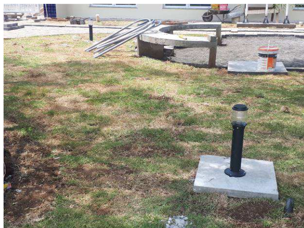
Figura 50E: Iluminação externa - luminárias postes balizadores
