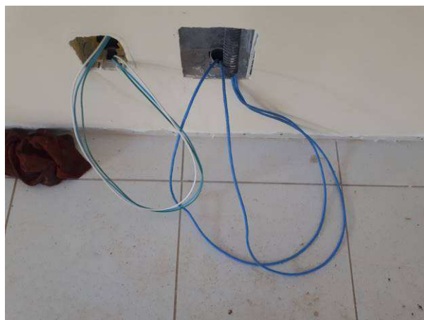
Figura 68E: infraestrutura rede lógica
