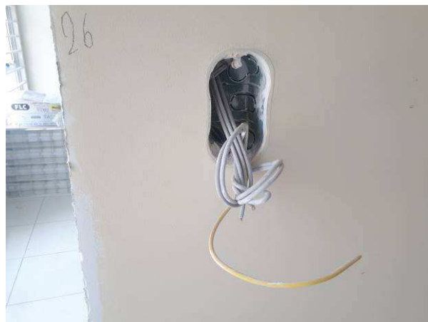
Figura 20E: Infraestrutura interna - caixas 4x2"
