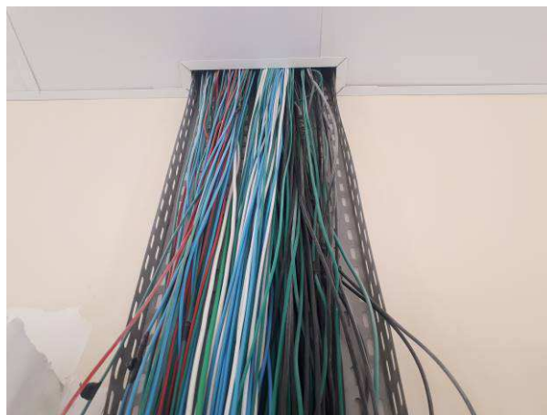
Figura 26E: Cabeamento elétrico - circuitos rede estabilizada, comum e ar-condicionado
