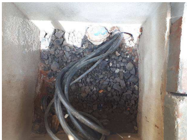
Figura 13E: Infraestrutura externa - cabos ramal entrada QDG
