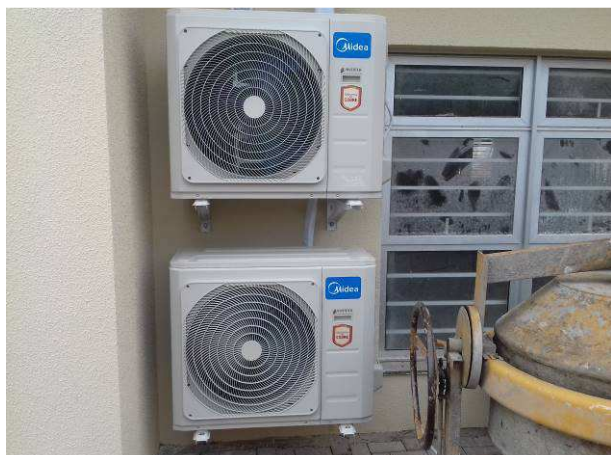
Figura 49C: Condensadoras instaladas na parede da secretaria
