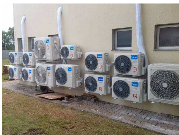
Figura 47C: Condensadoras instaladas na parede dos sanitários públicos
