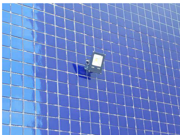
Figura 75E: Luminárias refletores LED 30W - Lateral direita edificação
