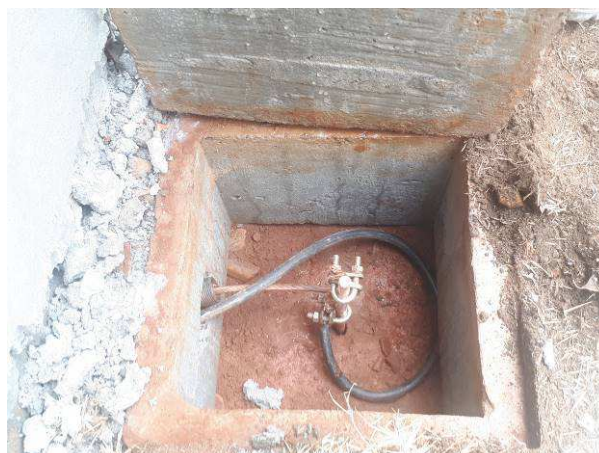
Figura 08E: Entrada de energia - aterramento
