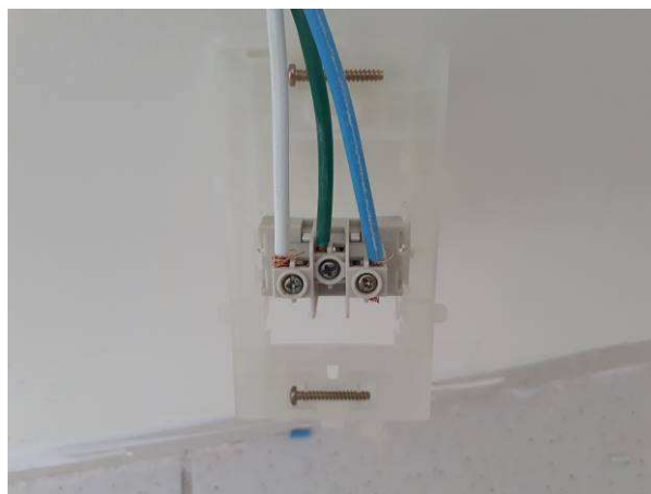
Figura 30E: Interruptores e tomadas elétricas
