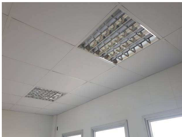
Figura 37E: Iluminação interna - luminárias 4 lâmpadas, com aletas
