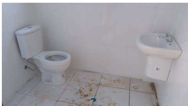
Figura 27C: Bacia com caixa acoplada para PNE, Lavatório para PNE e torneira com desligamento automático em sanitário público feminino
