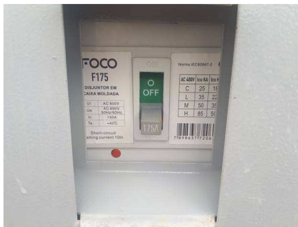
Figura 04E: Entrada de energia - proteção TRT
