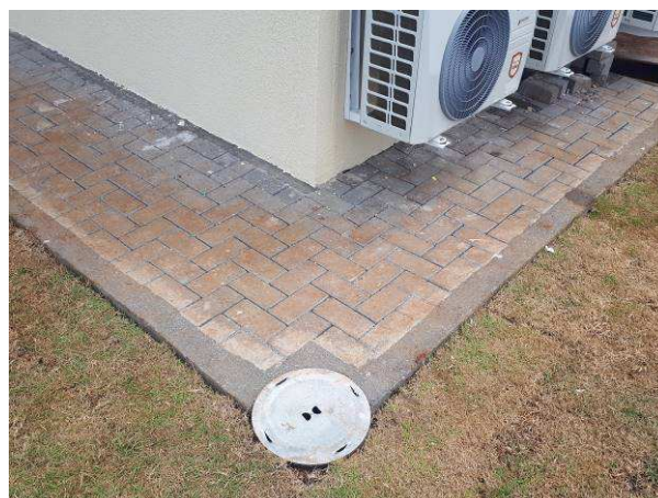
Figura 60E: caixas de inspeção aterramento
