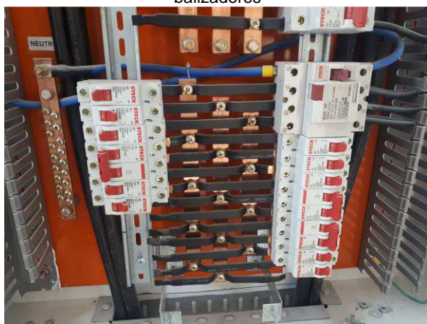
Figura 51E: Quadro QDG
