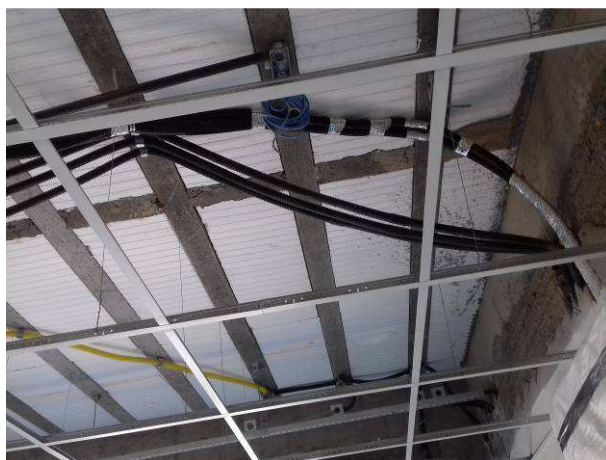
Figura 42C: Rede frigorígena da Sala Múltiplo-uso
