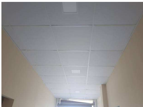
Figura 41E: Iluminação interna - luminárias tipo painel LED
