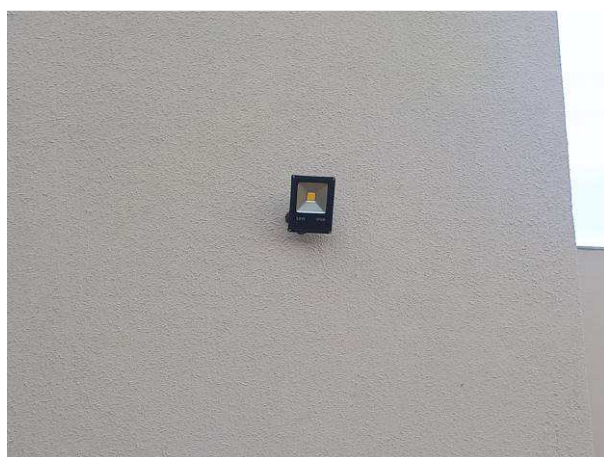
Figura 76E: Luminárias refletores LED 30W - Lateral direita edificação
