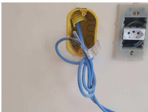
Figura 65E: infraestrutura rede lógica
