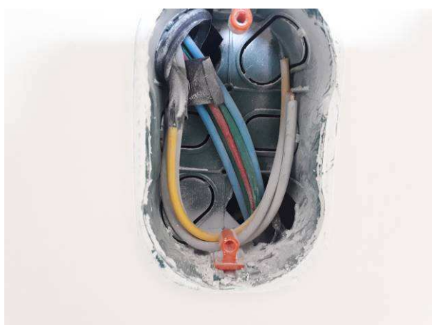
Figura 27E: Cabeamento elétrico - circuitos iluminação e rede estabilizada
