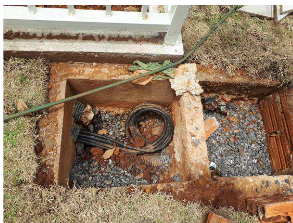
Figura 12E: Infraestrutura externa - cabos ramal entrada QDG
