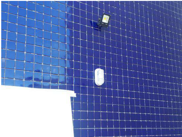
Figura 45E: Iluminação externa - luminárias tartaruga
