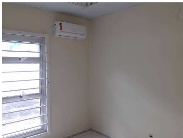
Figura 56C: Evaporadora instalada na sala dos assistentes
