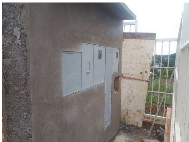
Figura 03E: Entrada de energia - caixas proteção e medição
