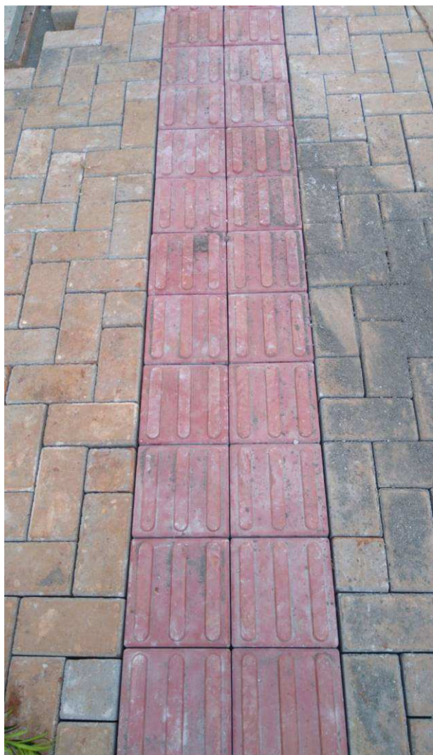
Figura 65C: Piso tátil instalado na calçada de acesso ao imóvel
