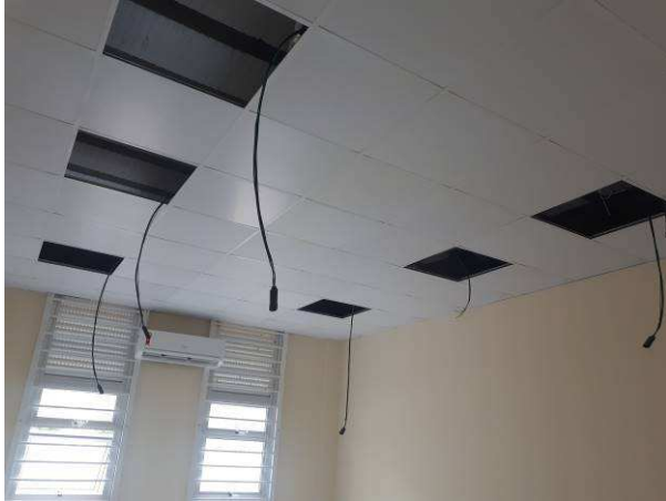
Figura 43E: Iluminação interna - espera para luminárias arquivo
