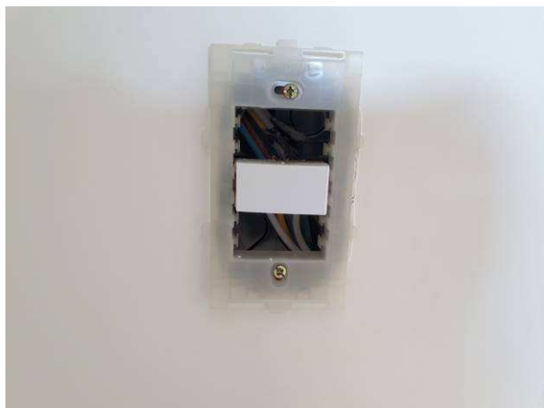
Figura 31E: Interruptores e tomadas elétricas
