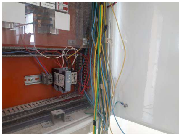
Figura 25E: Cabeamento elétrico - circuitos iluminação
