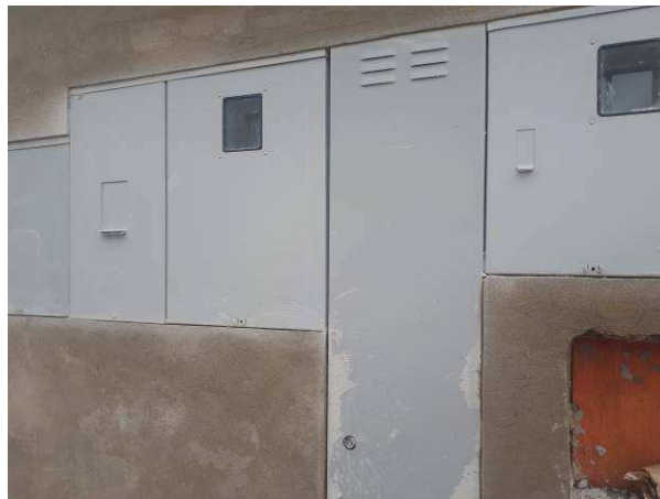
Figura 02E: Entrada de energia - caixas proteção e medição
