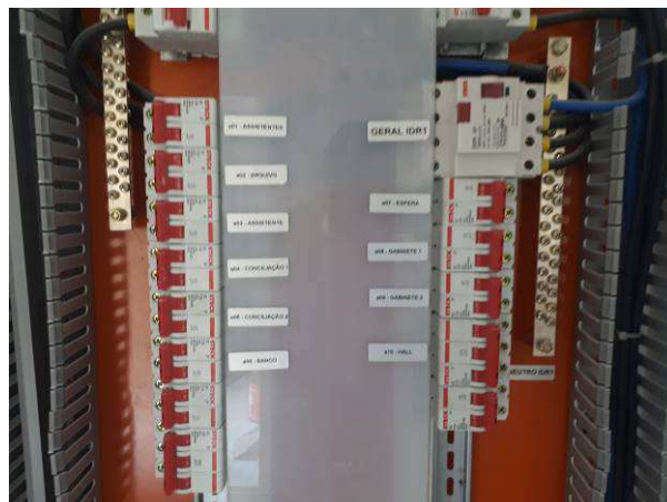
Figura 56E: Quadro QDAC
